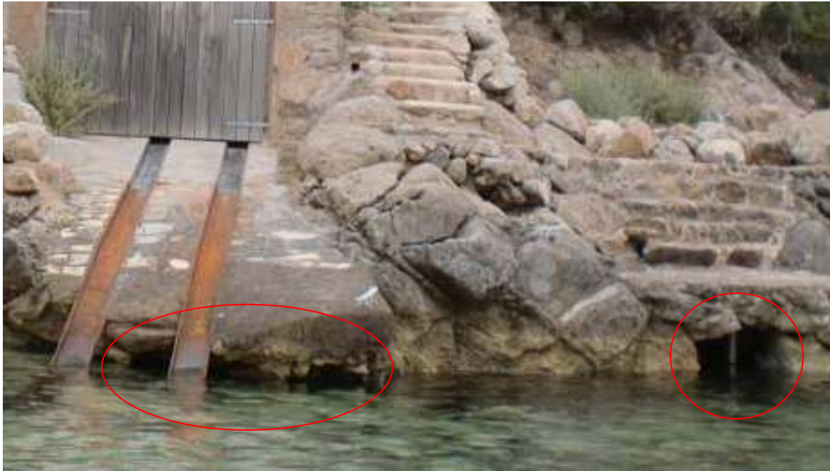
Fotografía 3.- Bajo el embarcadero y la rampa de varada anexa hay importantes descalses de las estructuras de hormigón que comprometen la seguridad de las personas.
