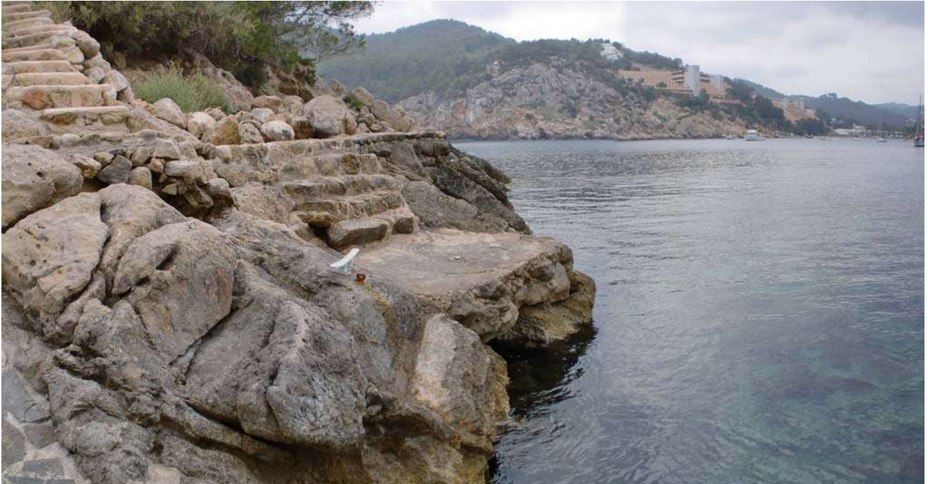
Figura 4.- El pequeño embarcadero es una estructura de hormigón sobre una base de roca natural y escollera artificial, en muy mal estado de conservación. Además se encuentra descalzado bajo la estructura de hormigón.
