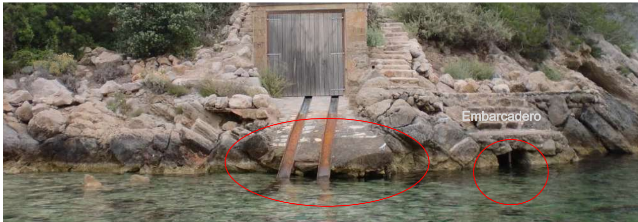
Fotografía 3.- Vista de los descalces de las estructuras de hormigón existentes bajo el embarcadero y la rampa de varada anexa que comprometen la seguridad de las personas.
