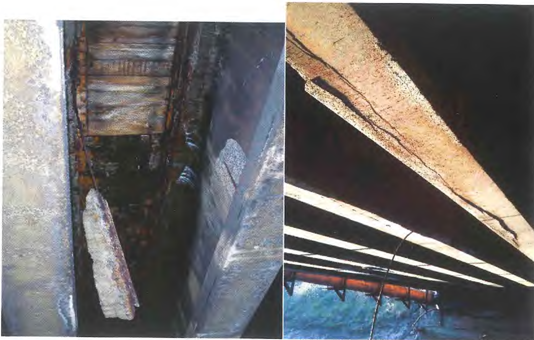
Fotografías de la parte inferior del puente, mostrando daños visibles en las vigas de sustentación con rotura de armaduras en la zona de trabajo a tracción.
