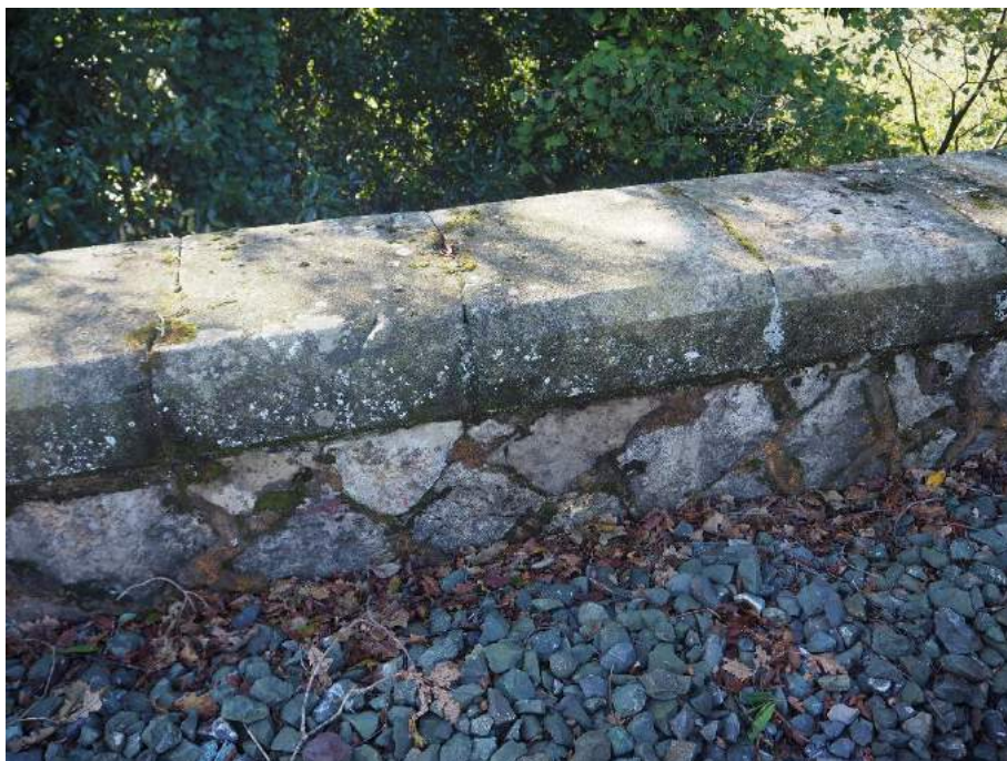
201029 013 Murete derecho de fábrica con leves daños
