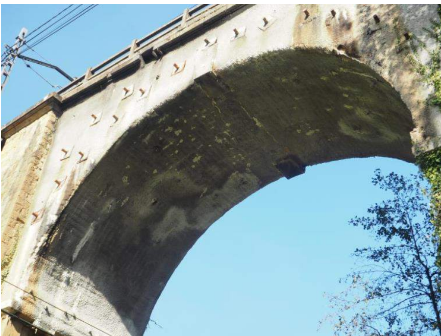
Figura 9. Filtraciones desde los anclajes de los bulones y desprendimiento del gunitado
