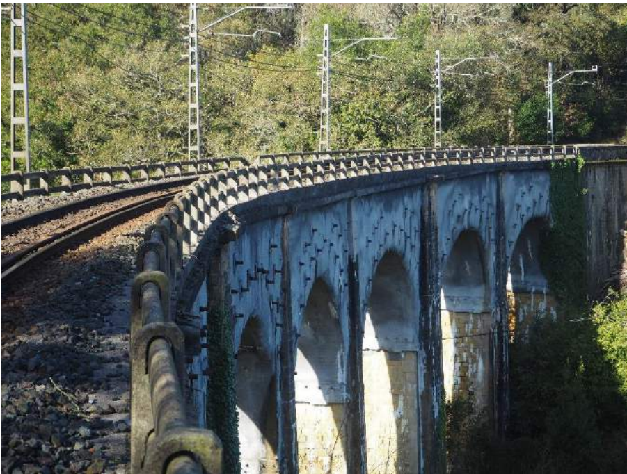
201029 020 Deformación en imposta por asiento en lado izquierdo desde estribo 2
