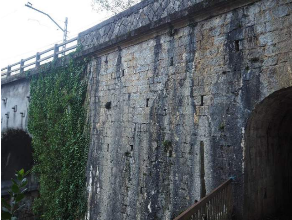
201029 253 Muro en vuelta izquierdo estribo 1 con humedades y vegetación
