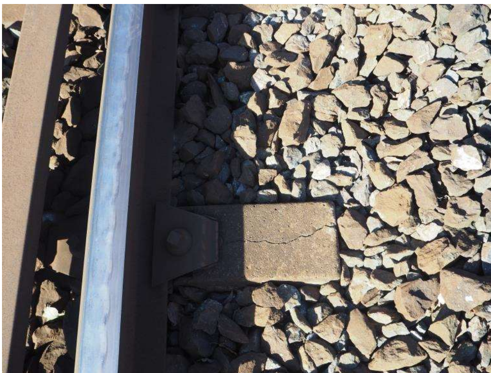
Figura 20. Fisura en travesía de hormigón
