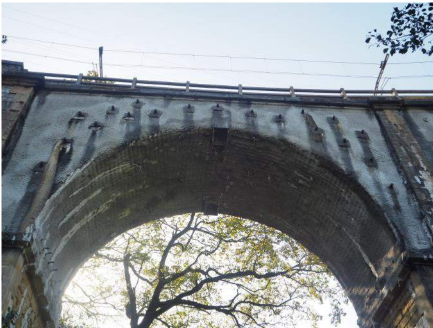
Figura 7. Vista del asiento registrado en las pilas P-2, P-3, P-4 y P-5 desde el estribo 2, observable por la pérdida de alineación de la imposta de fábrica
