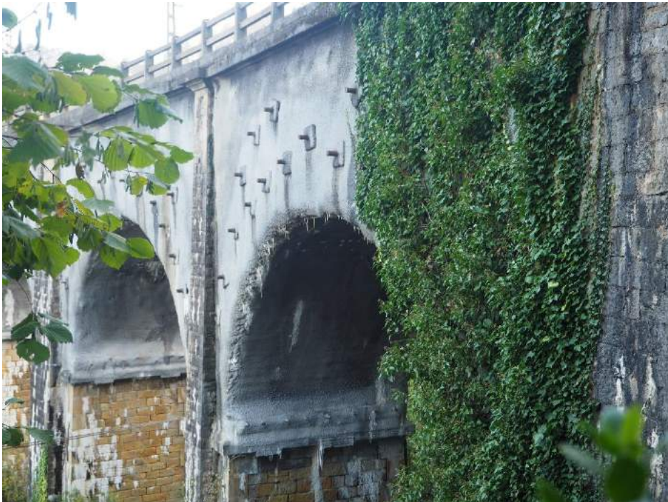
201029 262 Humedades y estalactitas en bóveda vano 1 lado izquierdo
