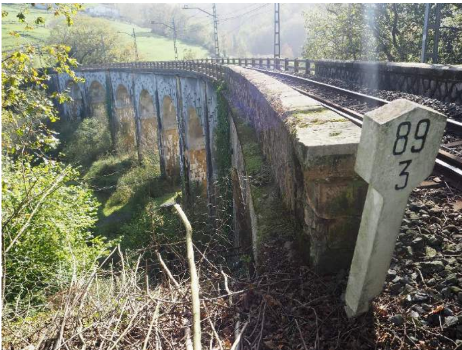
201029 094 Murete izquierdo de fábrica con leves daños en estribo 1
