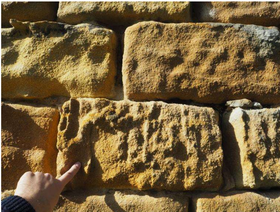
Figura 9. Detalle de la arenización y pérdida del material de junta característico de la fábrica de las pilas.
