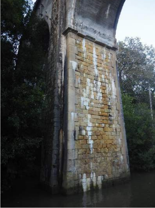
201029 231 Pila 1 lado derecho con eflorescencias y arenización
