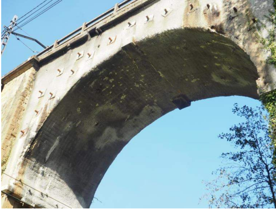
Figura 14. Filtraciones desde los anclajes de los bulones y desprendimiento del gunitado
