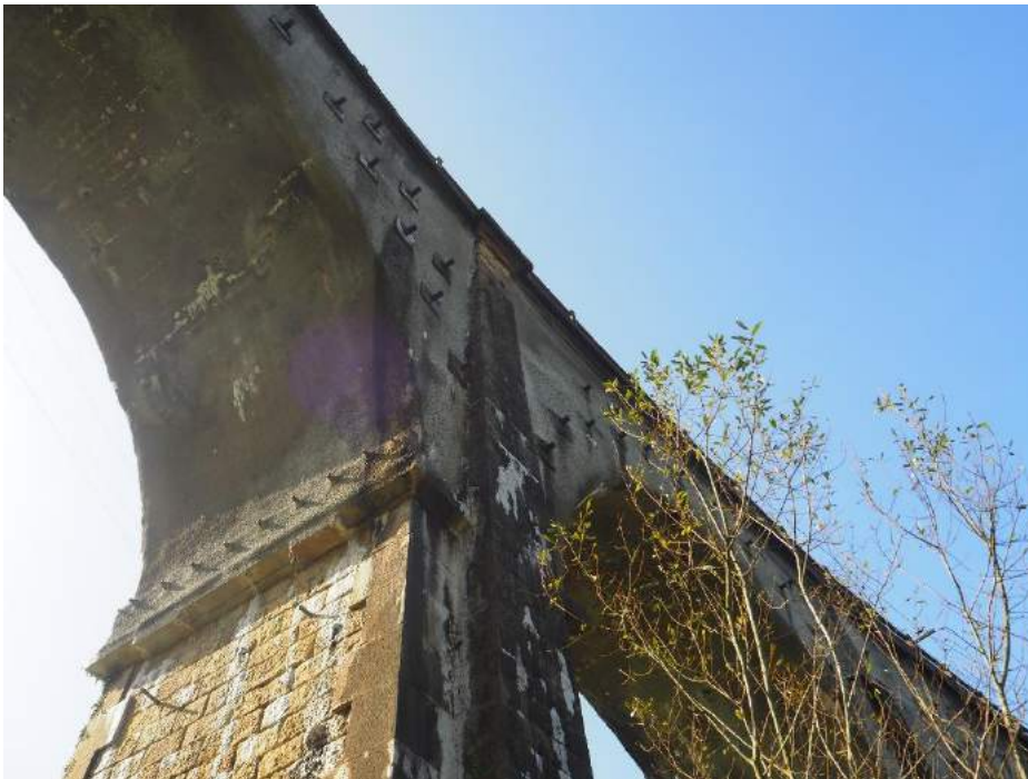
201029 170 Pila 4 lado izquierdo con humedades y eflorescencias
