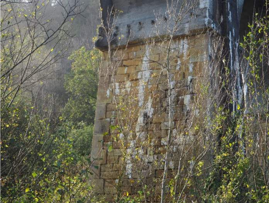
201029 191 Pila 3 lado vano 4 con eflorescencias y arenización
