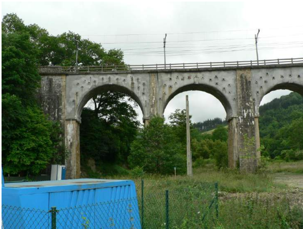
Figura 7. Humedades y depósitos calcáreos en bóvedas
