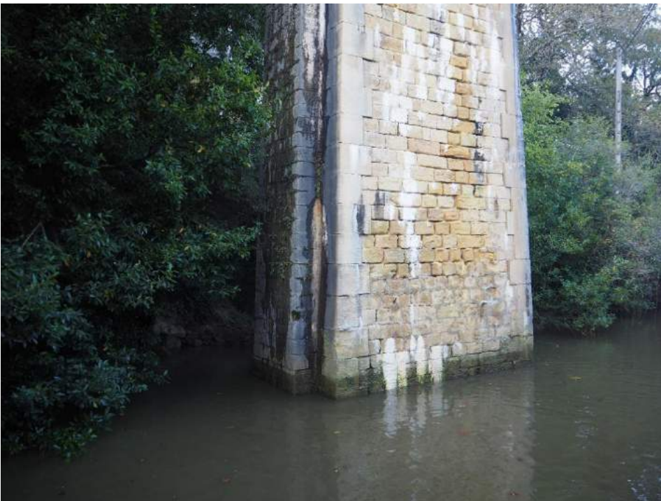
201029 232 Pila 1 lado derecho con eflorescencias y arenización
