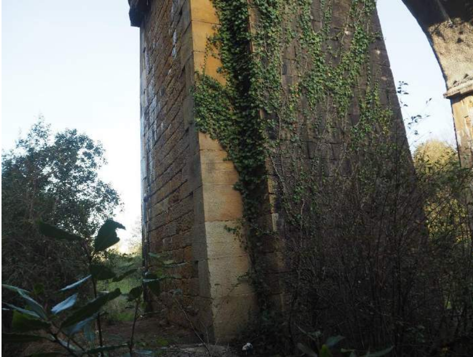
201029 229 Pila 2 lado derecho con humedades y vegetación
