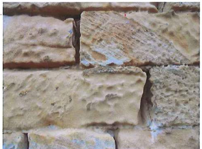
Perdida de material entre juntas de mampuestos del fuste de pilas
