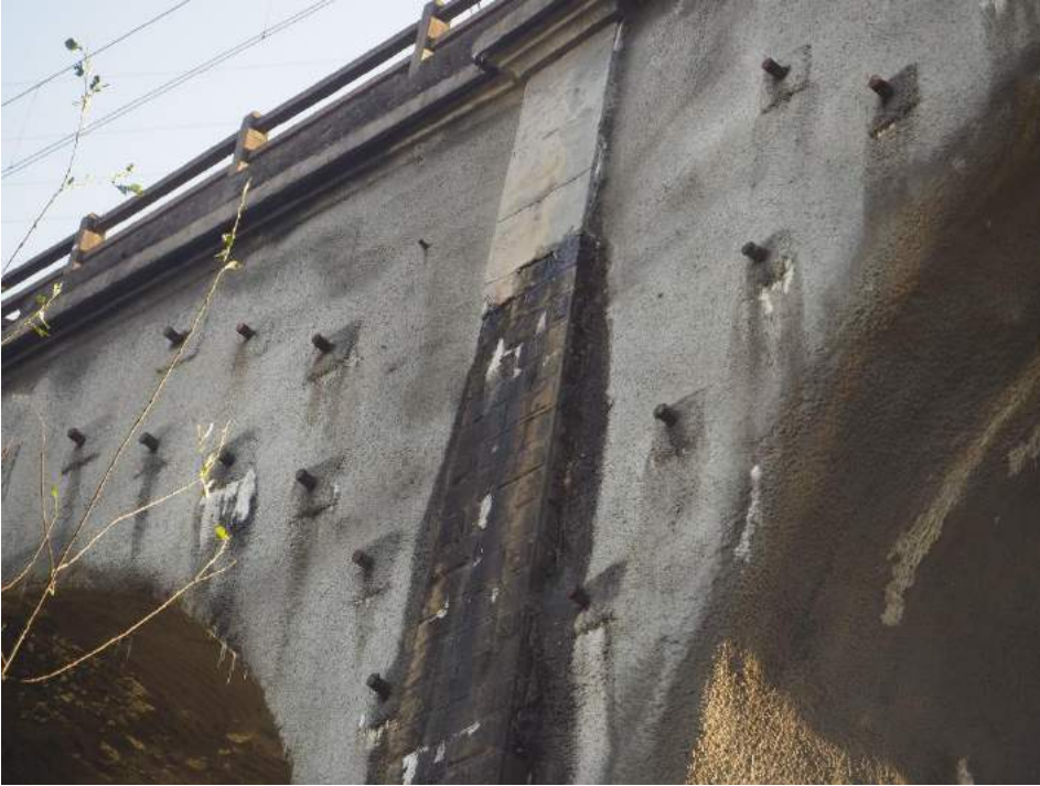
201029 199 Fisura en cabeza de pila 3 lado izquierdo con humedades y eflorescencias
