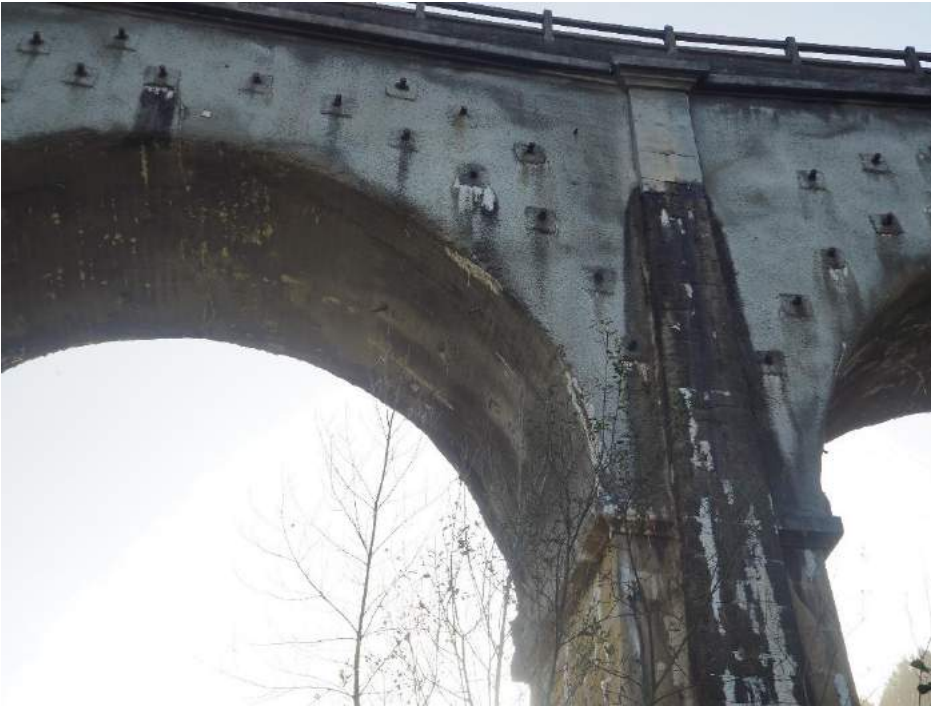
201029 183 Humedades en bulones en arranque de bóveda vano 4 lado izquierdo
