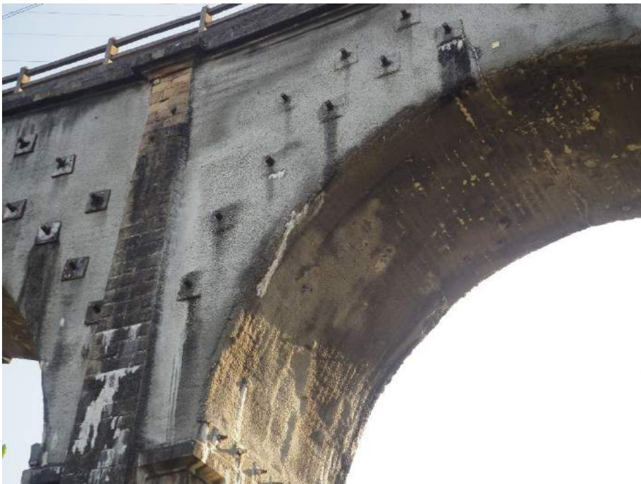
201029 182 Humedades en bulones en arranque de bóveda vano 4 lado izquierdo
