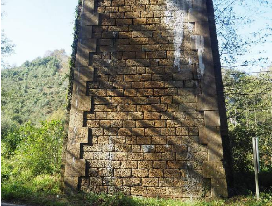
201029 121 Pila 6 lado vano 7 con eflorescencias y leve arenización
