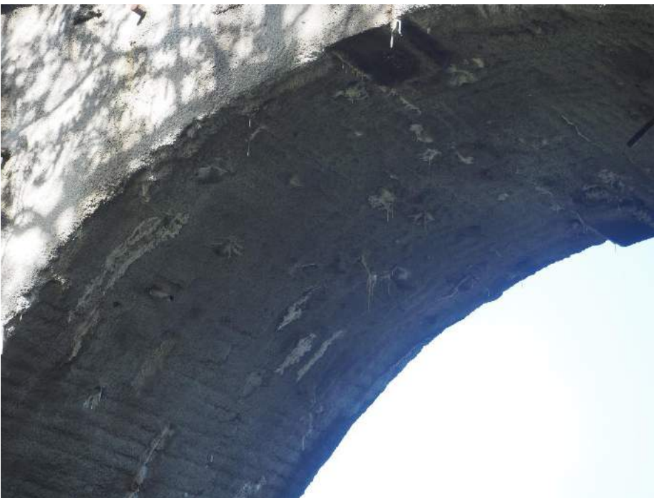
201029 104 Fisuras, eflorescencias y esclactitas en bóveda vano 7
