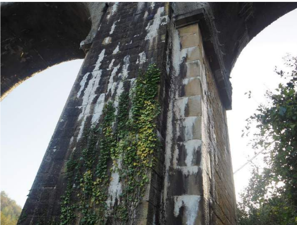
201029 244 Pila 2 lado izquierdo con humedades y eflorescencias
