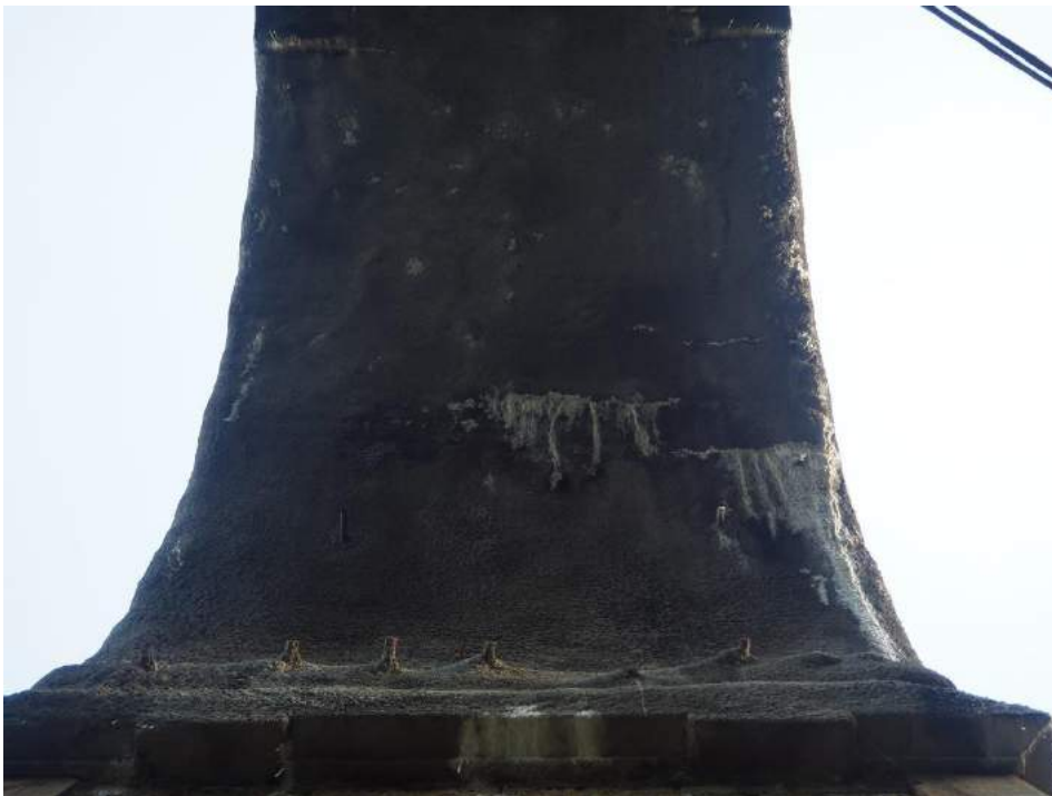
201029 242 Bóveda vano 2 con fisuras y eflorescencias
