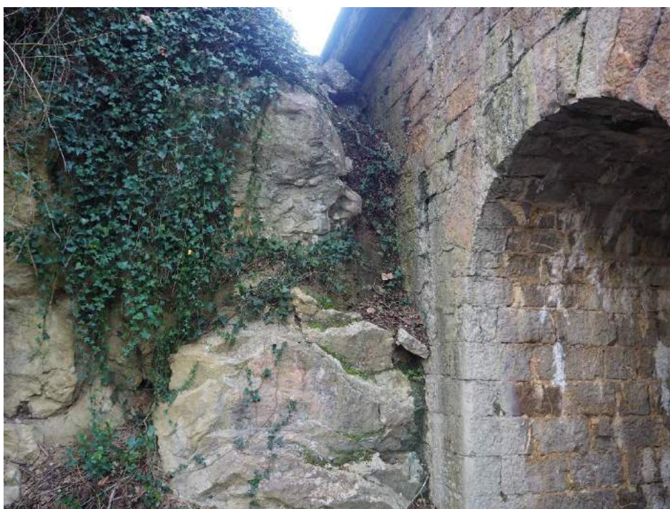
201029 266 Muro en vuelta derecho estribo 1 con humedades y vegetación
