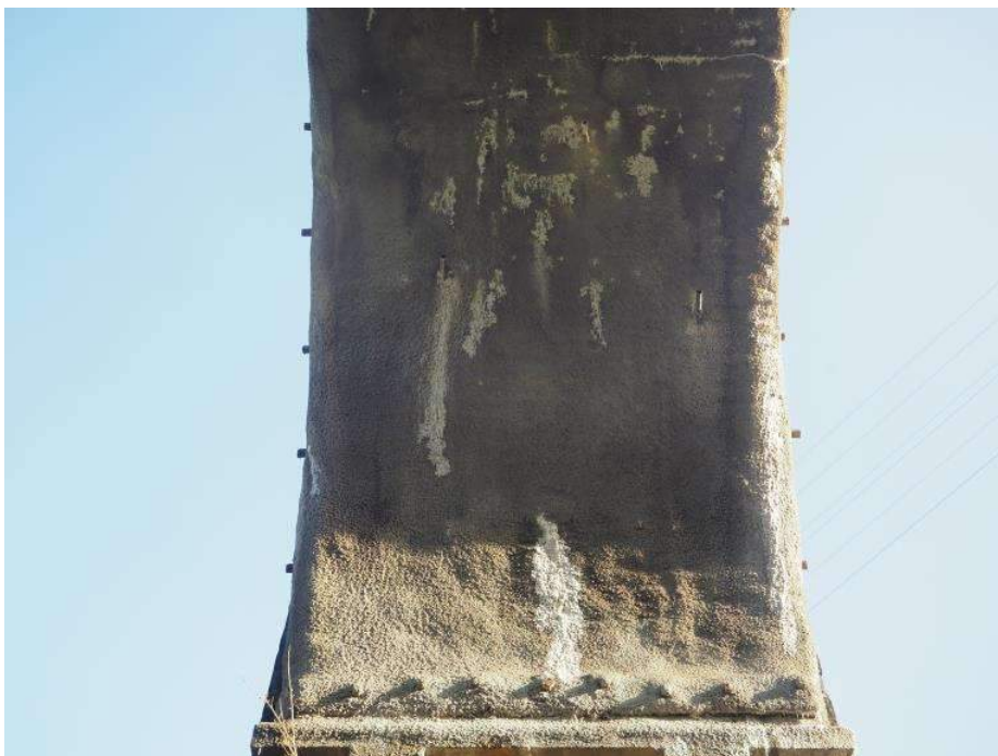
Figura 16. Mechinales de drenaje en los hombros de bóveda, sin circulación de agua
