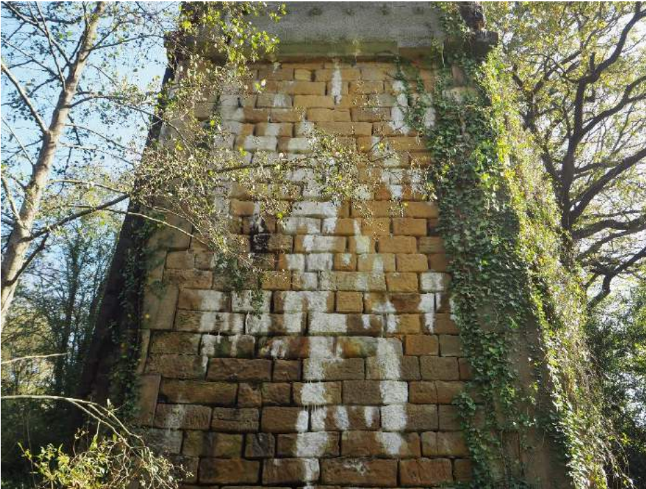
201029 159 Pila 6 lado vano 6 con eflorescencias y arenización
