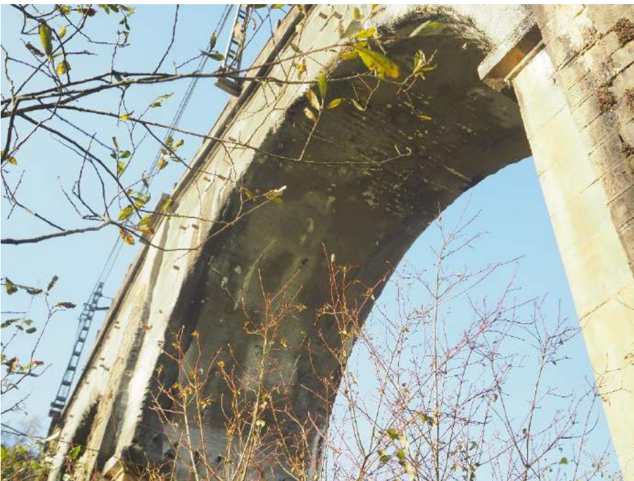
201029 188 Fisuras y eflorescencias en bóveda vano 3
