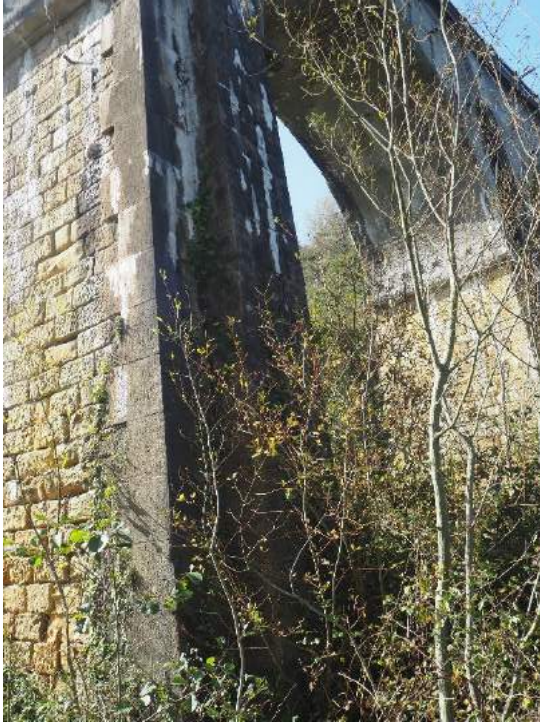
201029 169 Pila 4 lado izquierdo con humedades y eflorescencias
