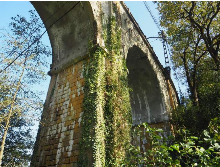
201029 152 Pila 6 lado derecho con humedades y vegetación enraizada
