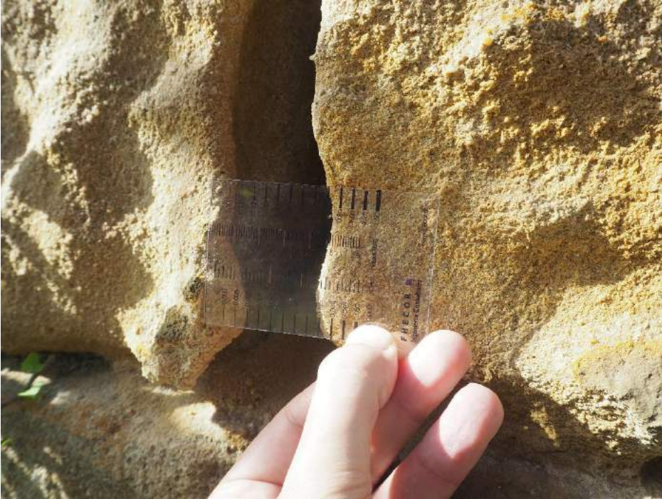
201029 167 Pérdida de material en pila 4 lado vano 5 por arenización
