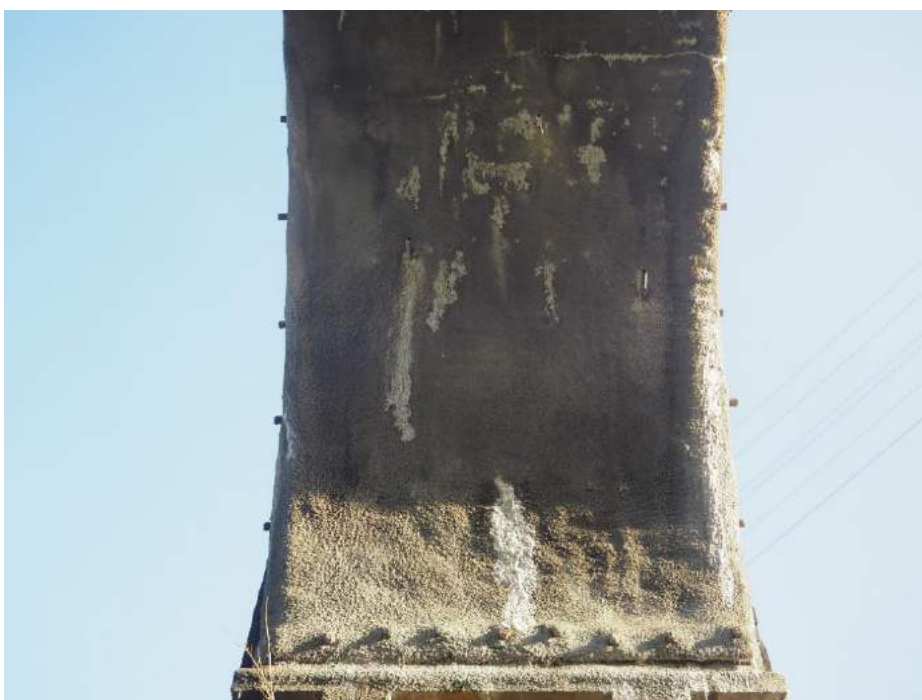
201029 204 Bóveda vano 3 con fisuras y eflorescencias
