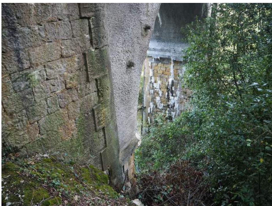
201029 278 Bulones en arranque de bóveda vano 1 sobre estribo 1 lado derecho
