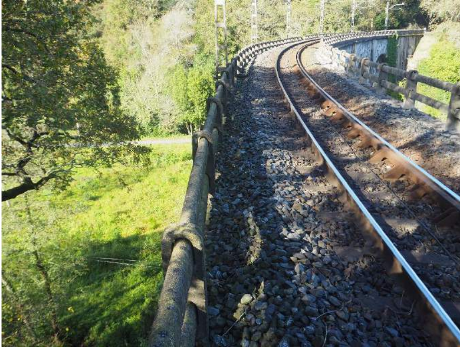
201029 021 Barandilla y derrame de balasto en lado derecho desde estribo 2
