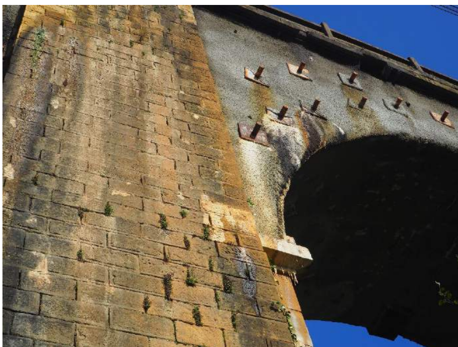
201029 150 Humedades en bulones bóveda vano 6 lado derecho
