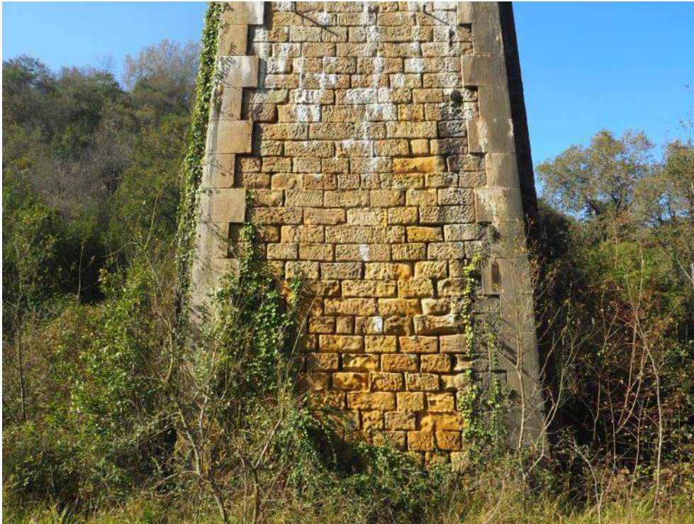
Figura 3. Eflorescencias, humedades y vegetación enraizada en la pila 4, así como arenización y pérdida del material de junta.
