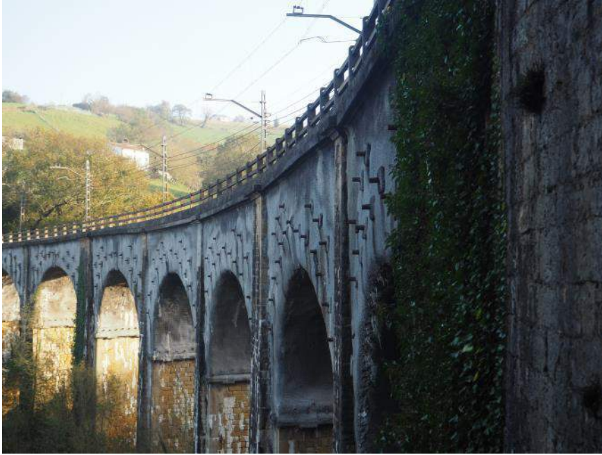
Figura 6. Vista del asiento registrado en las pilas P-2, P-3, P-4 y P-5 desde el estribo 2, observable por la pérdida de alineación de la imposta de fábrica
