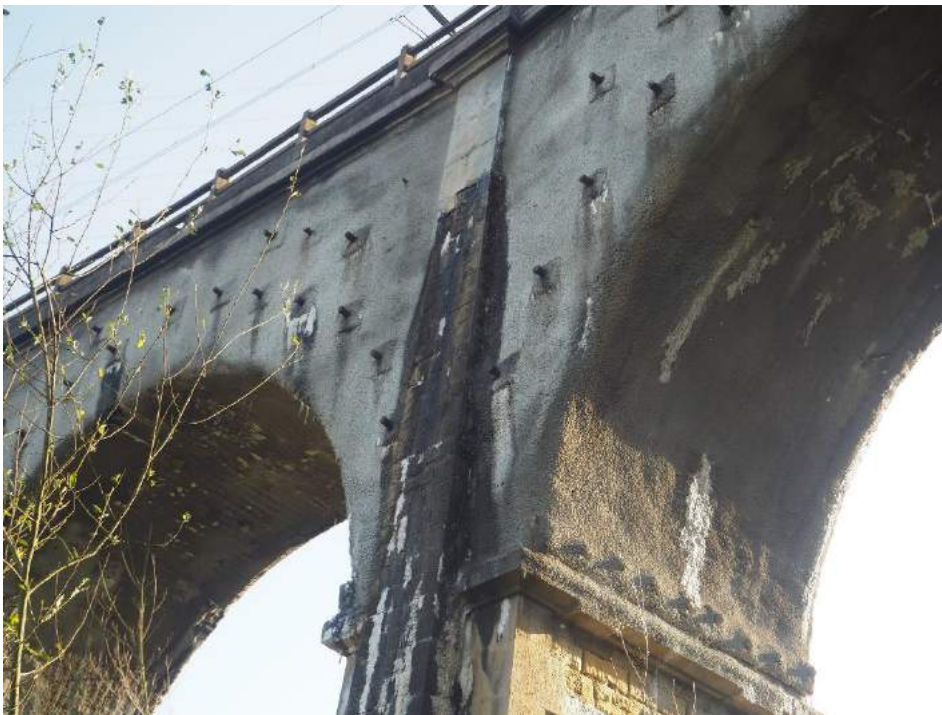
201029 198 Pila 3 lado izquierdo con humedades y eflorescencias
