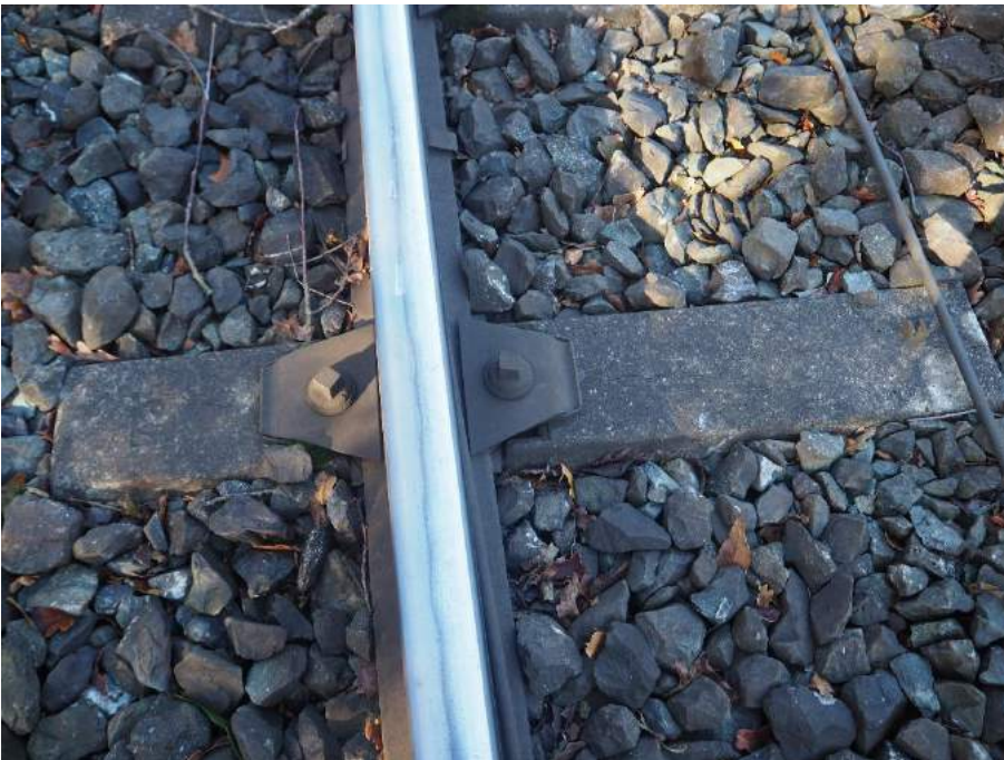
201029 024 Fisura en traviesa junto estribo 2
