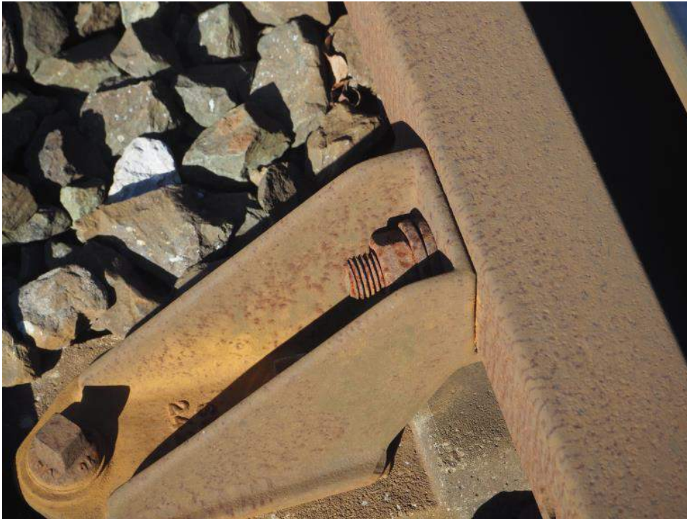
Figura 16. Picaduras y pátinas de óxido en la encarriladora de vía
