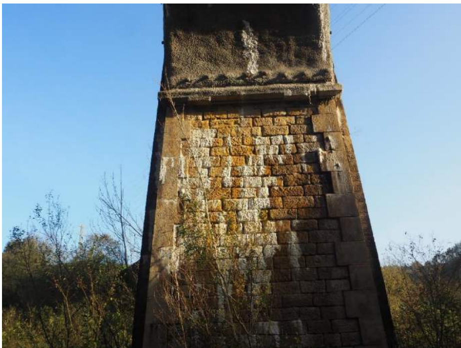
201029 203 Pila 3 lado vano 3 con eflorescencias y arenización
