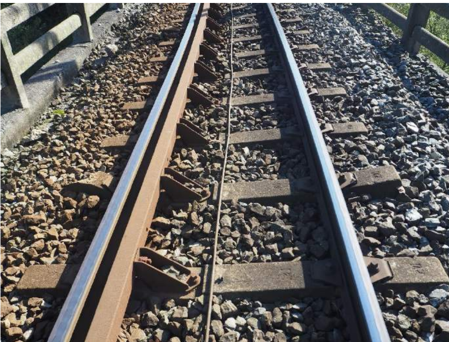
201029 064 Rotura en traviesa de hormigón lado izquierdo
