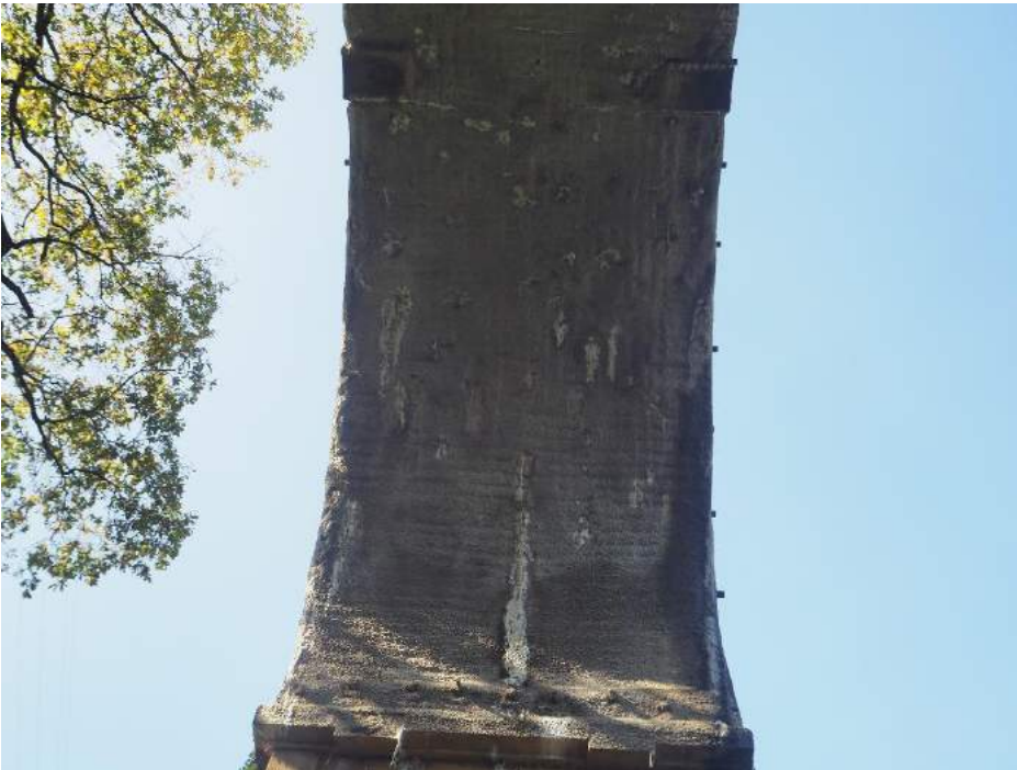
201029 124 Fisuras y eflorescencias en bóveda vano 6
