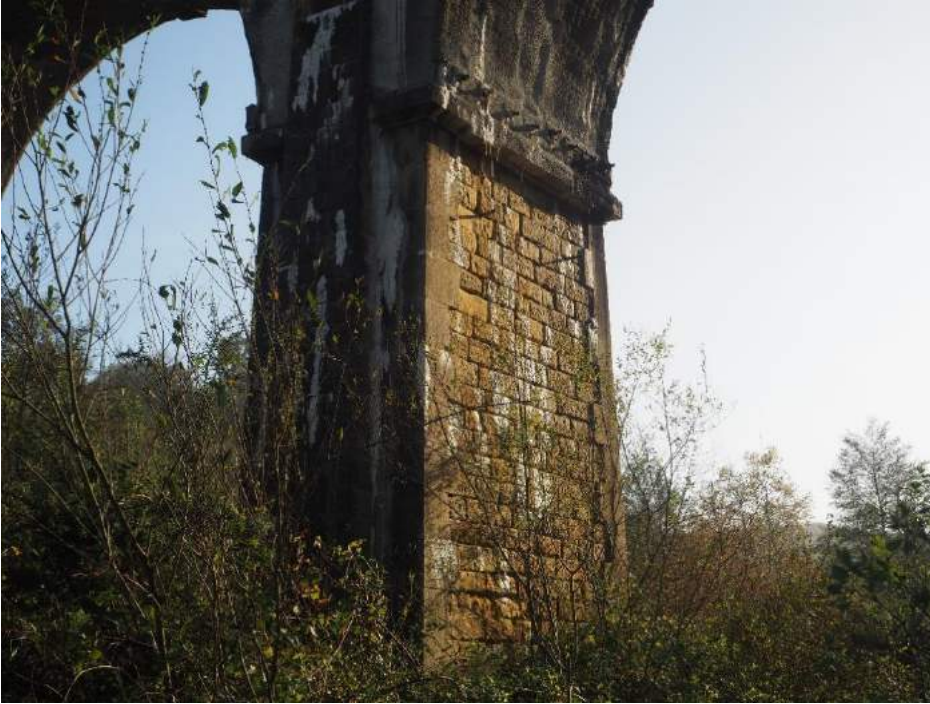
201029 179 Pila 4 lado vano 4 con eflorescencias y arenización
