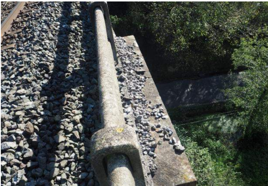
Figura 13. Caída de balasto por ausencia de un elemento de contención
