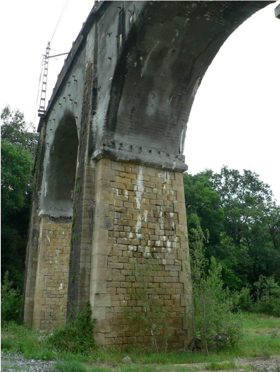
Figura 8. Humedades y depósitos calcáreos en bóvedas
