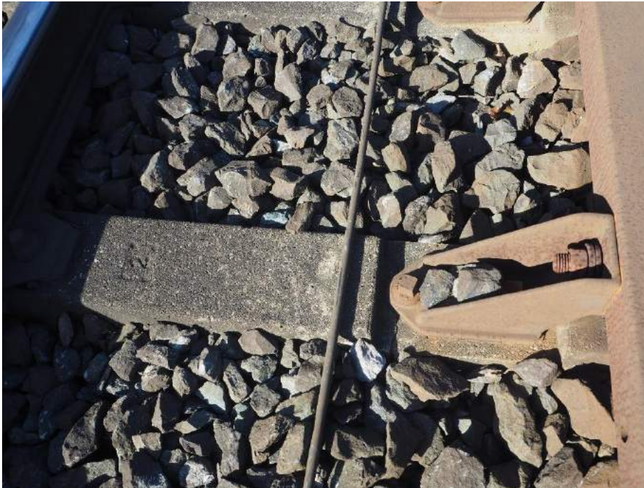
201029 062 Fisura en traviesas de hormigón
