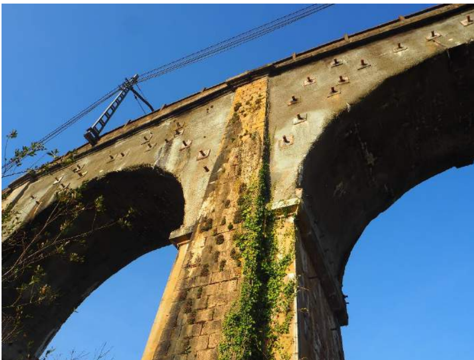
201029 186 Pila 3 con humedades y vegetación enraizada
