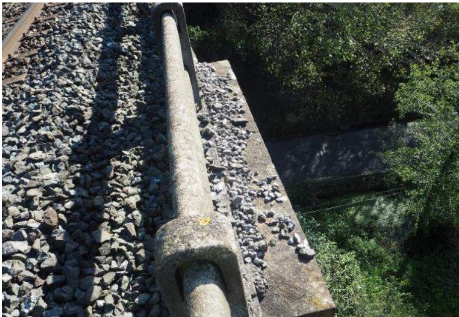
Figura 18. Caída de balasto por ausencia de un elemento de contención
