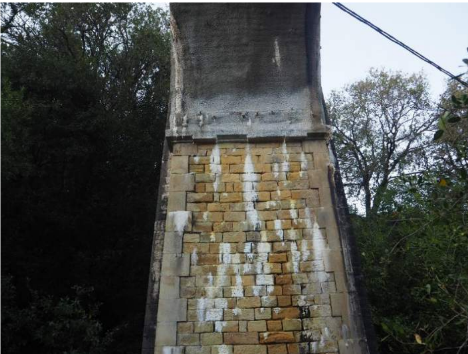
201029 240 Pila 1 lado vano 2 con eflorescencias y arenización
