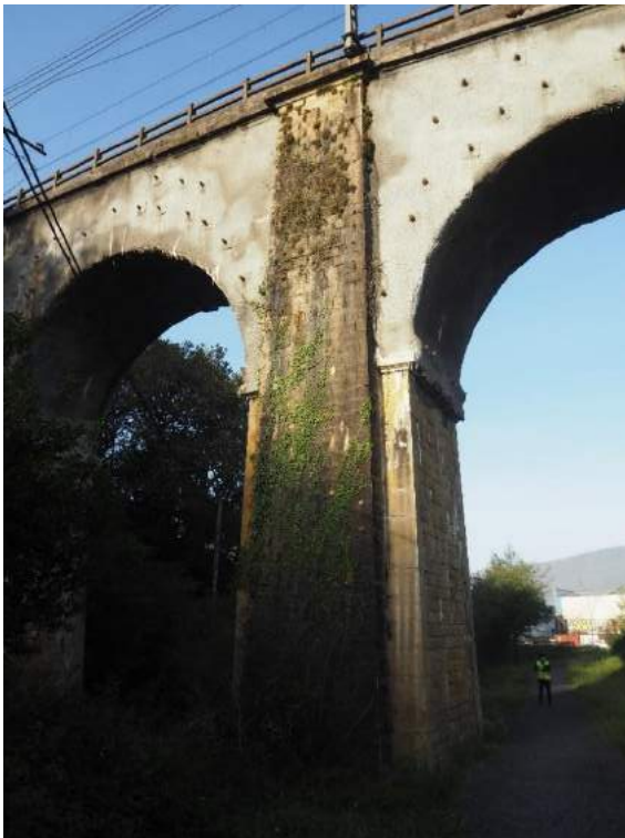
201029 218 Pila 2 lado derecho con humedades y vegetación
