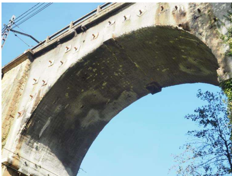
Figura 14. Filtraciones desde los anclajes de los bulones y desprendimiento del gunitado
