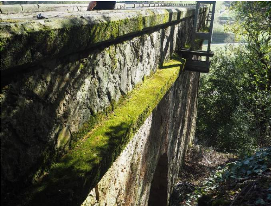
201029 096 Murete derecho de fábrica con pátina biológica en estribo 1
