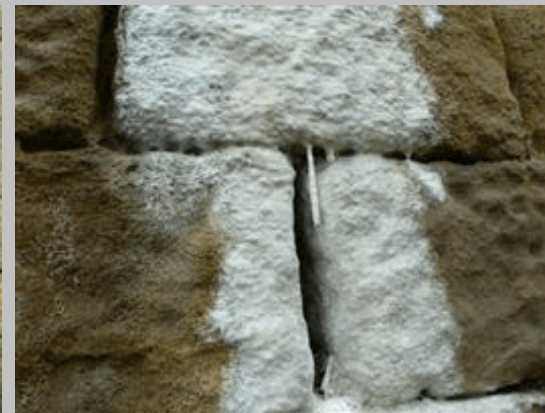
05 Manchas calcáreas en pila
