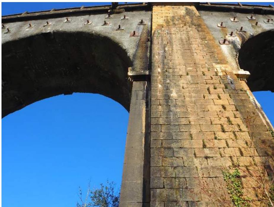
201029 149 Pila 5 lado izquierdo con humedades y vegetación enraizada
