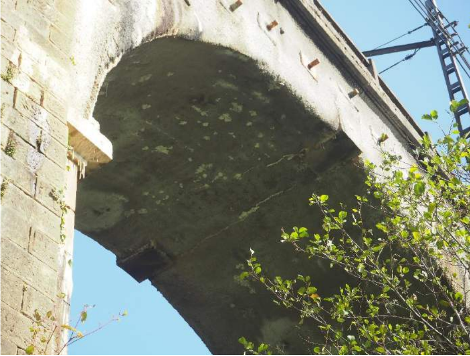
201029 151 Bóveda vano 6 con fisuras y eflorescencias
