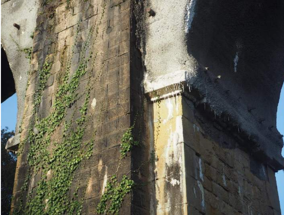
201029 217 Estalactitas en imposta de pila 2 lado derecho
