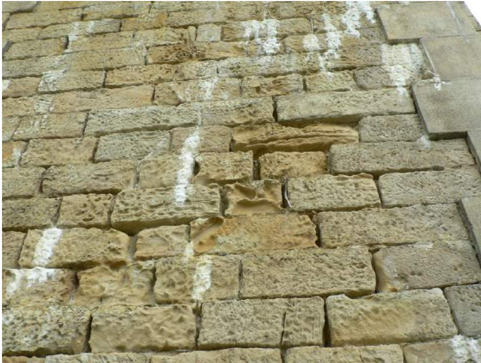
Figura 5. Alveolización de sillares en pila y pérdida de material de juntas
