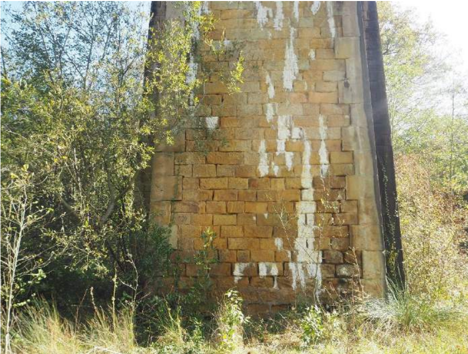
201029 143 Pila 5 lado vano 5 con eflorescencias y arenización
