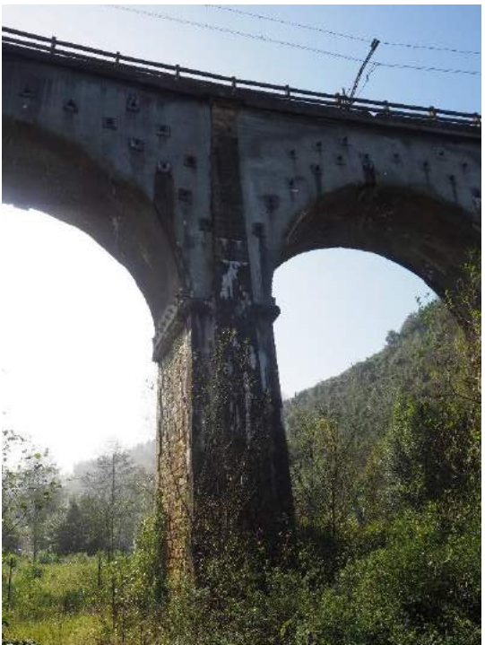
201029 172 Pila 4 lado izquierdo con humedades y eflorescencias
