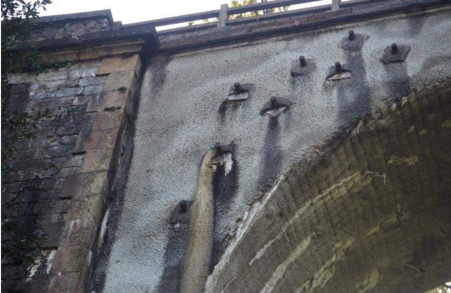
Figura 8. Filtraciones desde los anclajes de los bulones y desprendimiento del gunitado
