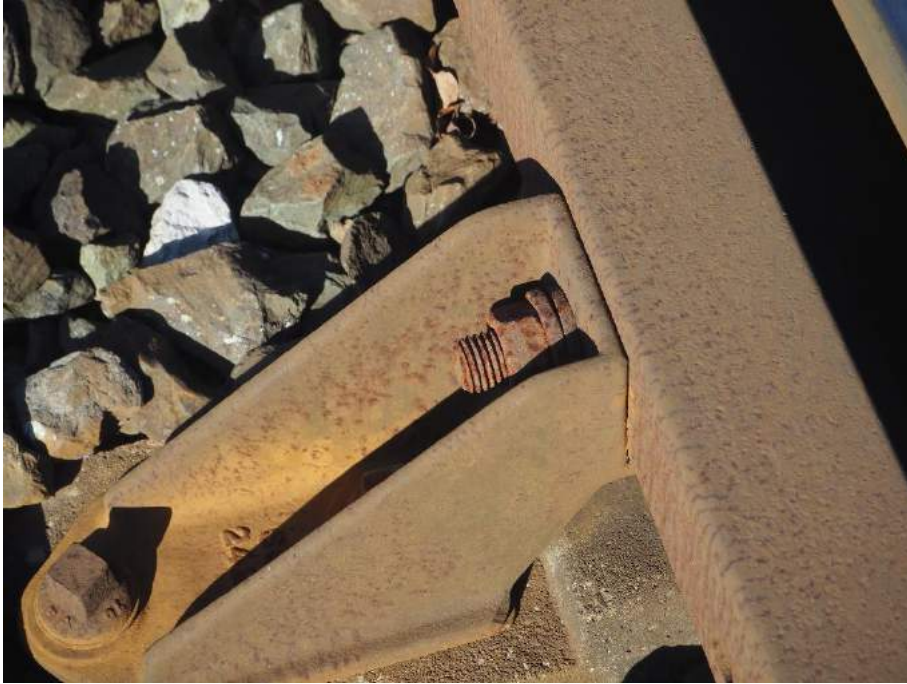
201029 057 Picadura de óxido en encarriladora
