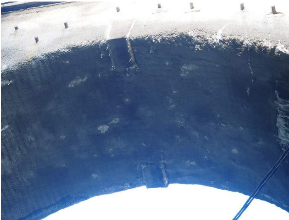
201029 225 Bóveda vano 2 con fisuras y eflorescencias
