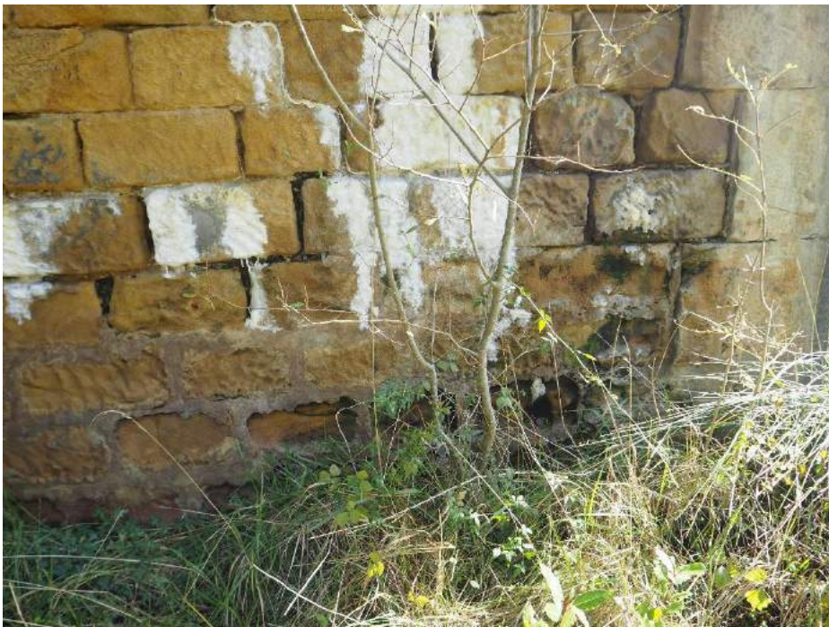
201029 146 Detalle de pila 5 lado vano 5 con eflorescencias y arenización
