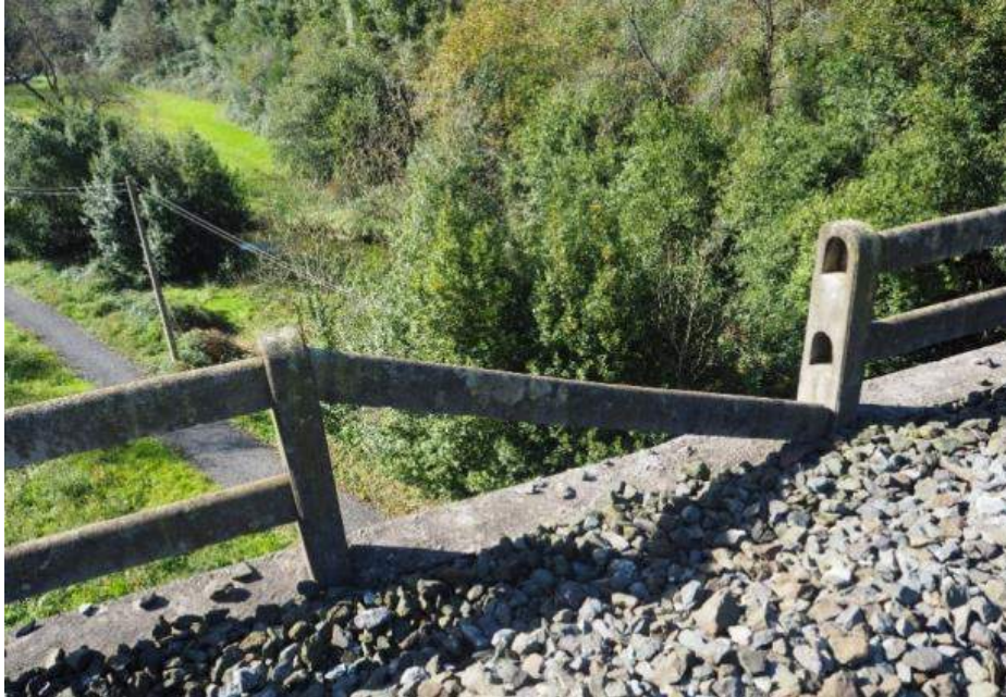
Figura 17. Barandilla rota sobre el vano 4 en el lado derecho
