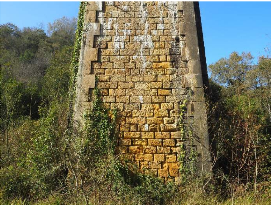
201029 164 Pila 4 lado vano 5 con eflorescencias y arenización
