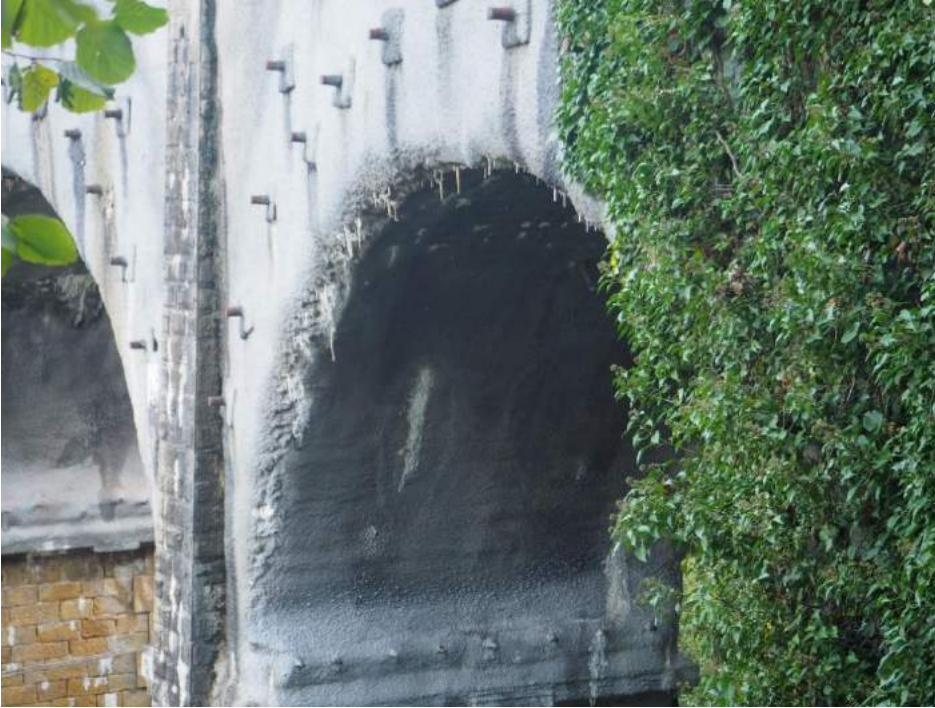
201029 263 Humedades y estalactitas en bóveda vano 1 lado izquierdo
