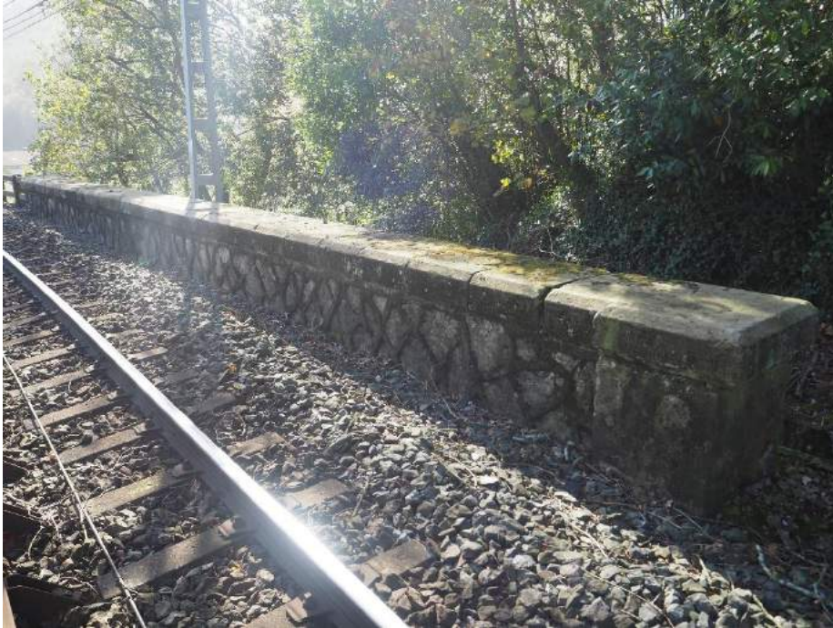
201029 093 Murete derecho de fábrica con leves daños en estribo 1
