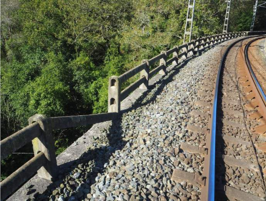
201029 067 Rotura de barandilla derecha sobre vano 4
