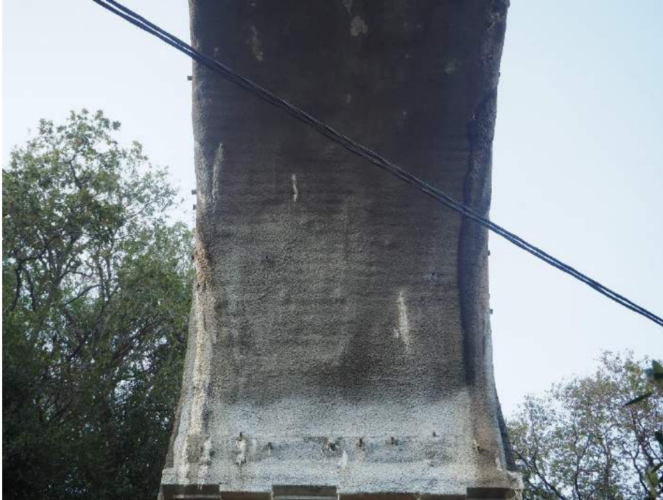
201029 241 Gunita vano 2 con leves daños
