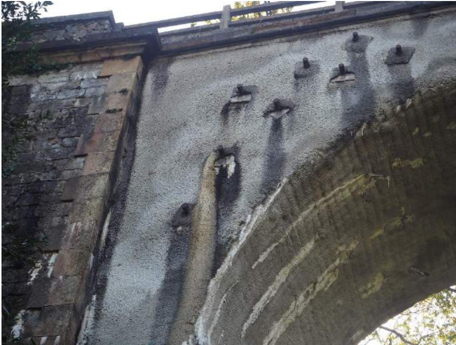
201029 117 Pérdida de gunita en anclaje de bulones en bóveda vano 7 lado izquierdo
