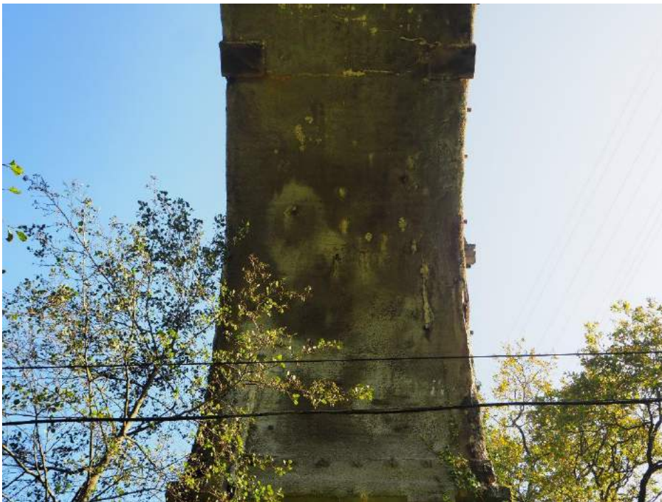
201029 158 Fisuras y eflorescencias en bóveda vano 6
