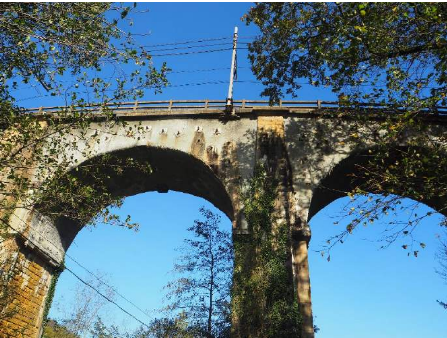
201029 128 Pila 6 lado derecho y bóvedas 6 y 7 con humedades
