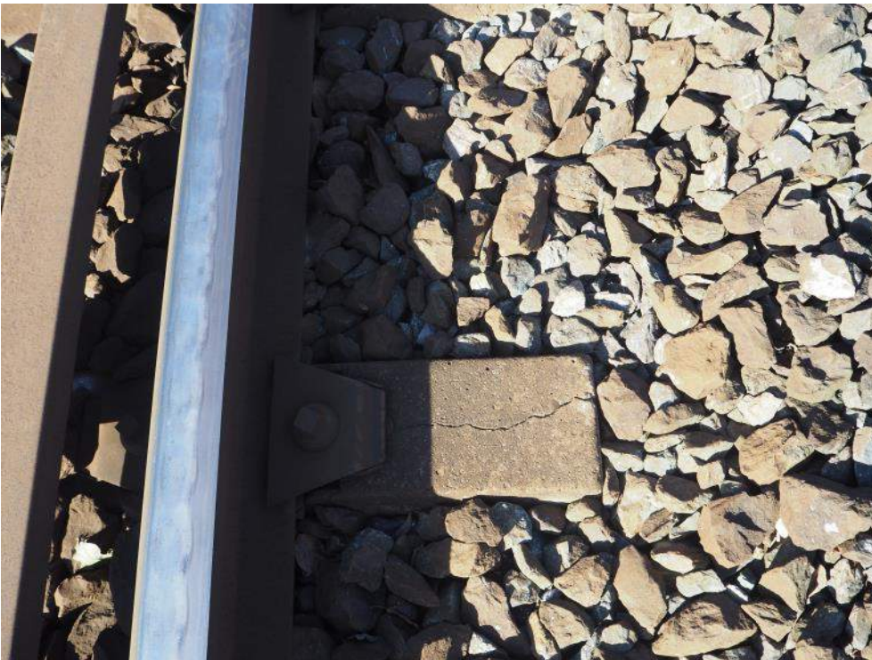
Figura 15. Fisura en traviesa de hormigón
