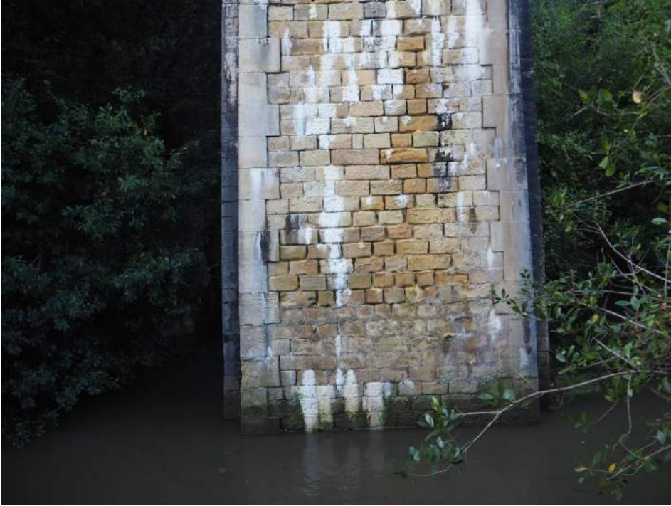
201029 239 Pila 1 lado vano 2 con eflorescencias y arenización
