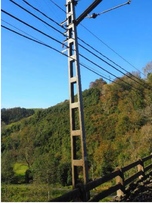
201029 033 Poste de catenaria
