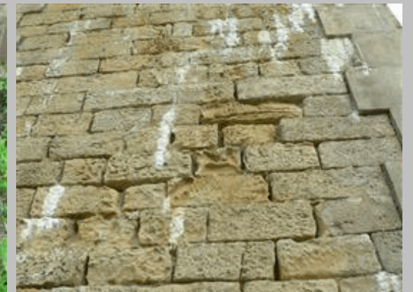
09 Alveolización de sillares en pila y pérdida de material de juntas
