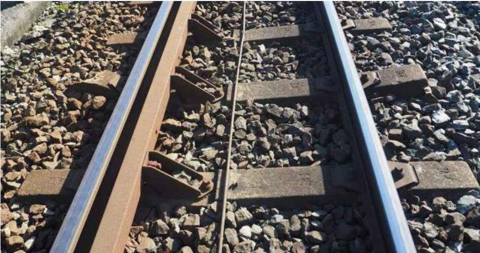
Figura 14. Traviesa de hormigón rota su lado izquierdo, con giro adicional respecto a su posición original
