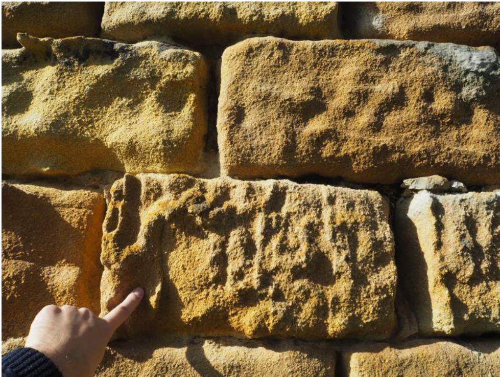
Figura 4. Detalle de la arenización y pérdida del material de junta característico de la fábrica de las pilas.
