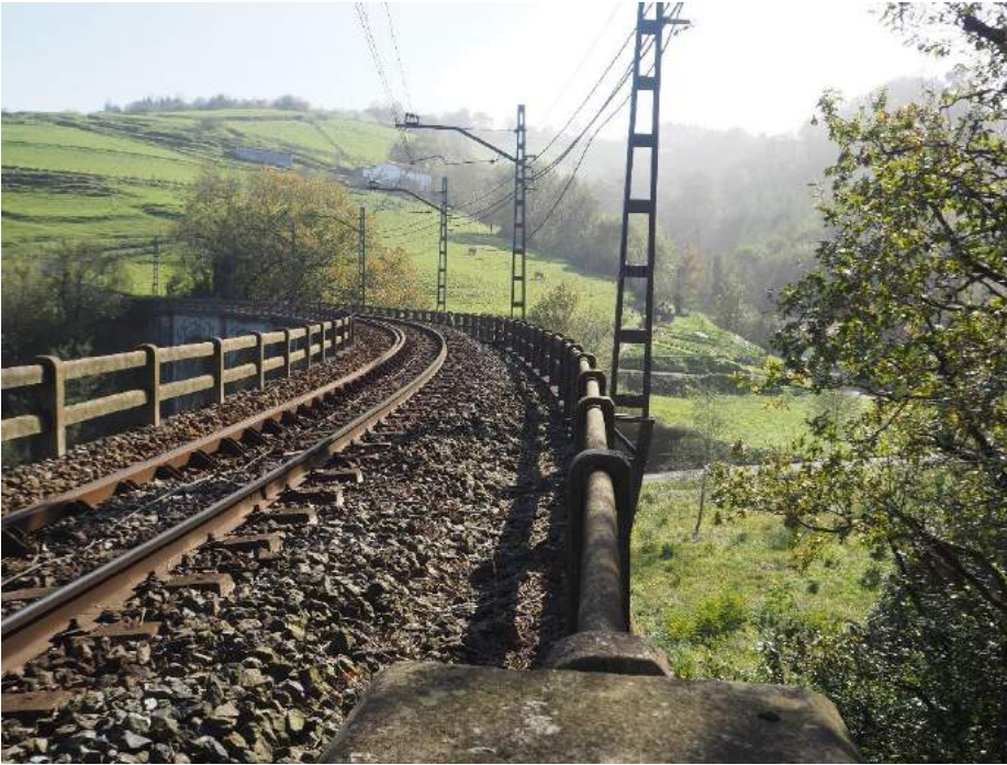
201029 091 Alineación vertical de las barandillas
