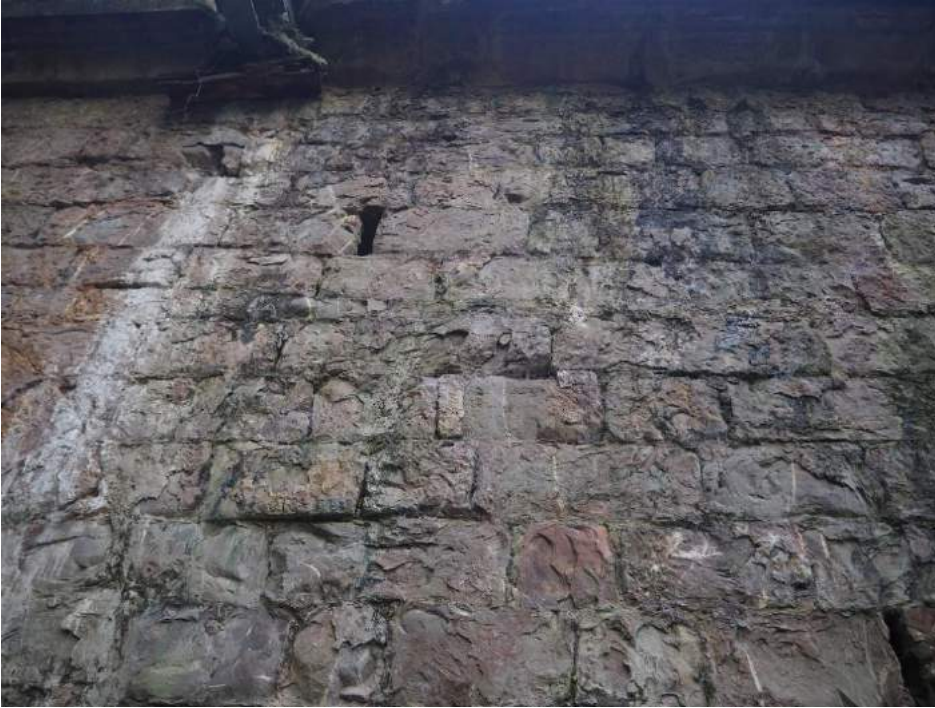
201029 267 Muro en vuelta derecho estribo 1 con humedades y vegetación
