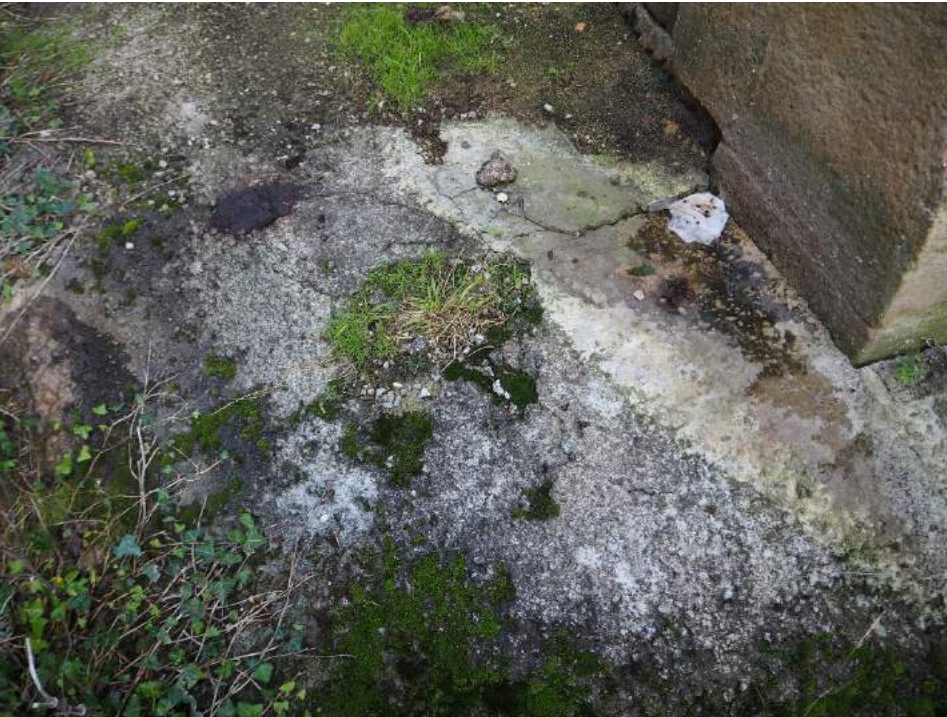
201029 236 Rotura en torta de hormigón en pila 2 lado vano 2
