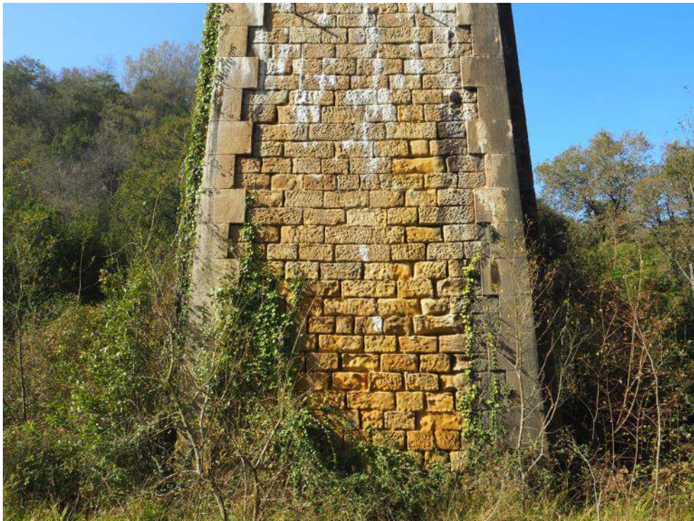
Figura 8. Eflorescencias, humedades y vegetación enraizada en la pila 4, así como arenización y pérdida del material de junta.
