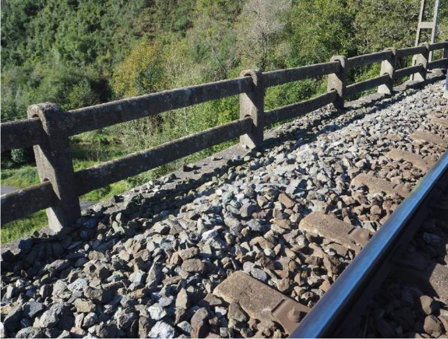
201029 063 Banqueta de balasto en lado derecho con derrame
