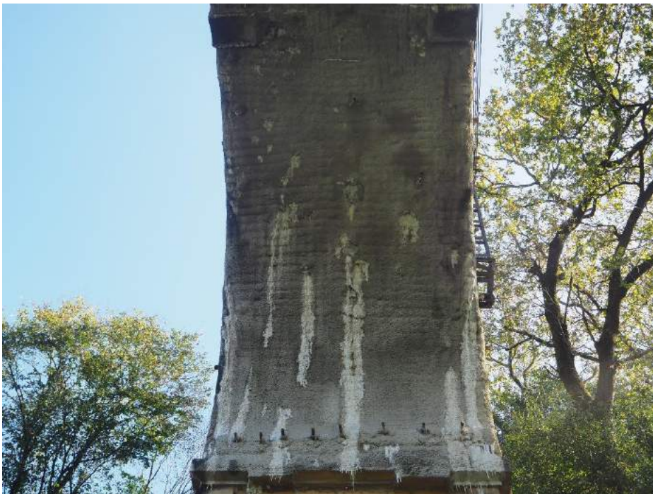
201029 110 Fisuras y eflorescencias en bóveda vano 7
