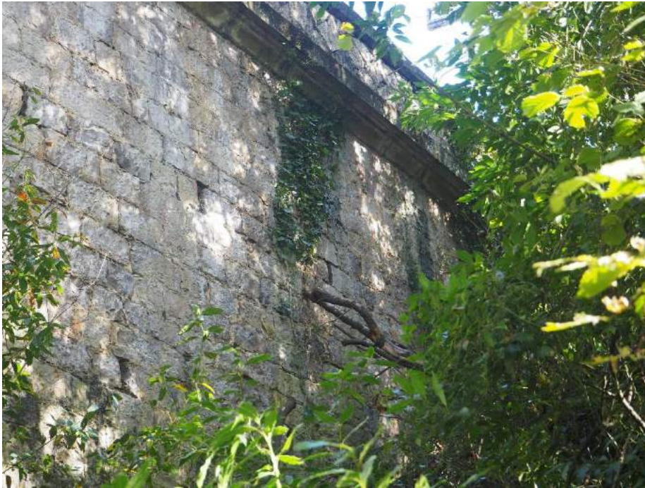
201029 101 Vegetación en muro en vuelta derecho estribo 2
