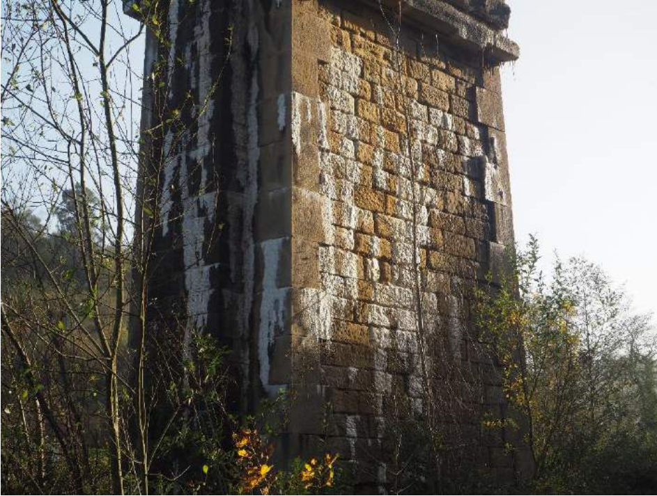
201029 195 Pila 3 lado vano 3 con eflorescencias y arenización
