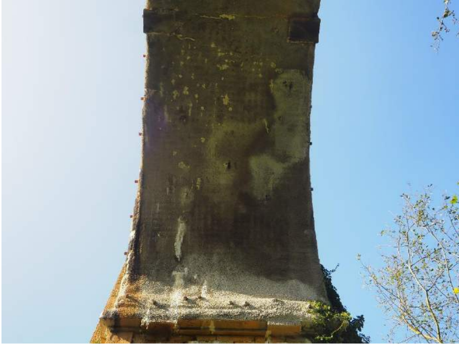
201029 157 Fisuras y eflorescencias en bóveda vano 6
