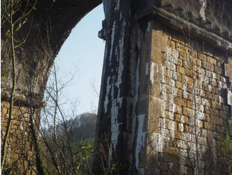
201029 197 Pila 3 lado izquierdo con humedades y eflorescencias
