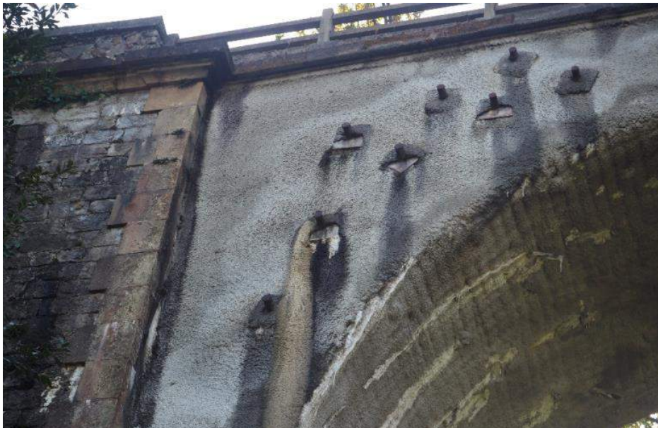
Figura 13. Filtraciones desde los anclajes de los bulones y desprendimiento del gunitado
