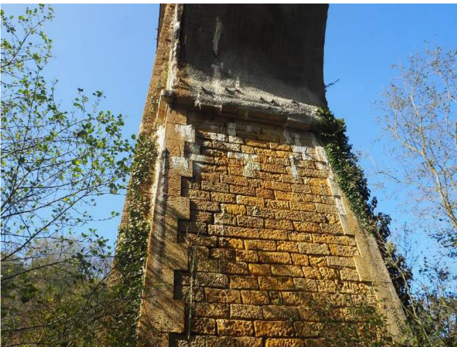
201029 156 Pila 5 lado vano 6 con eflorescencias y arenización
