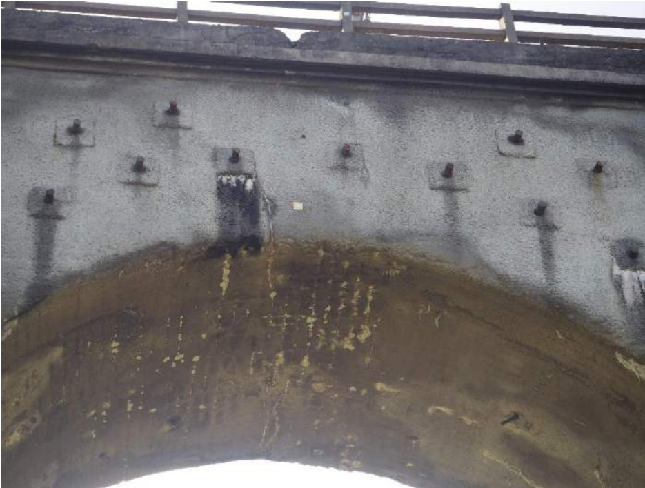
201029 175 Fisuras y eflorescencias en bóveda vano 4
