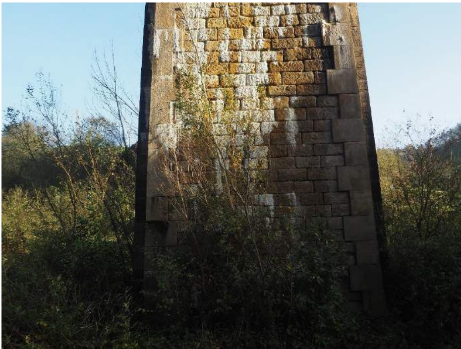
201029 202 Pila 3 lado vano 3 con eflorescencias y arenización
