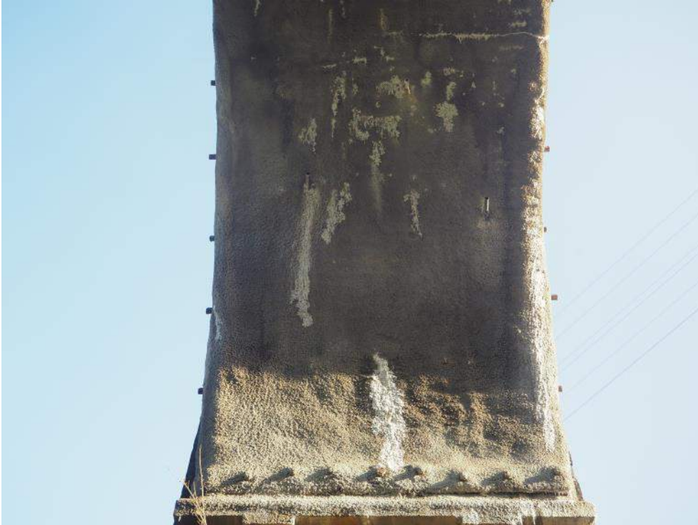
Figura 11. Mechinales de drenaje en los hombros de bóveda, sin circulación de agua
