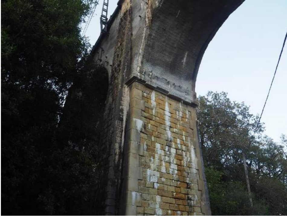
201029 233 Pila 1 lado derecho con eflorescencias y arenización
