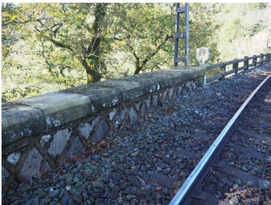
201029 014 Murete derecho de fábrica con leves daños
