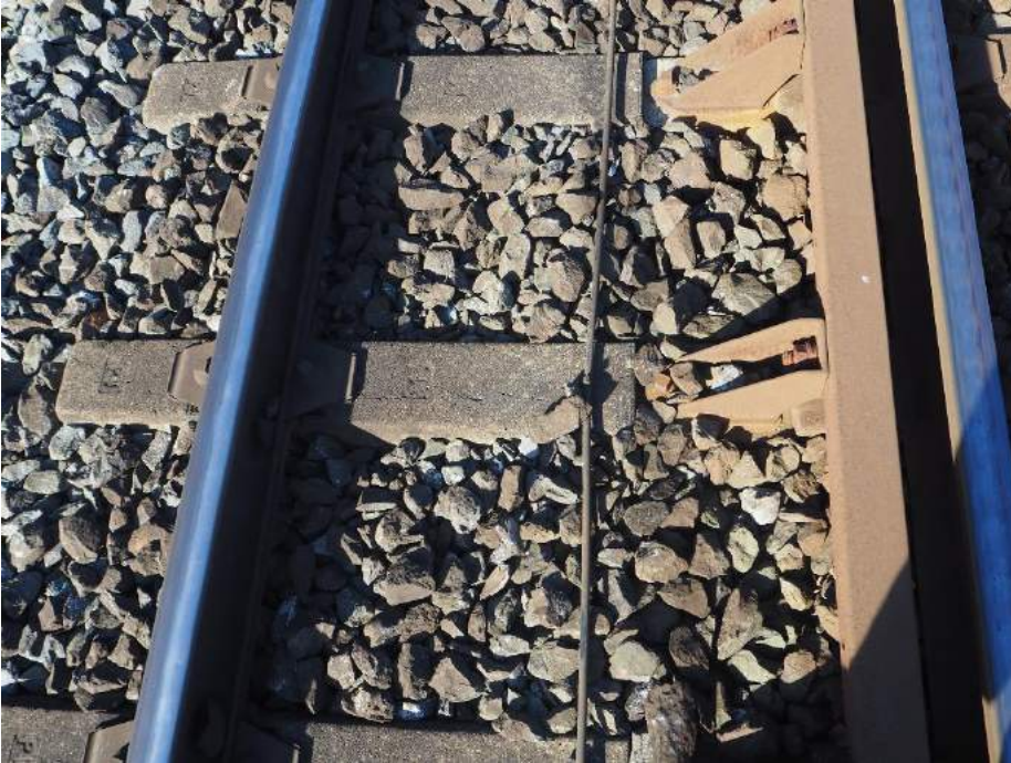
201029 075 Fisura en traviesa
