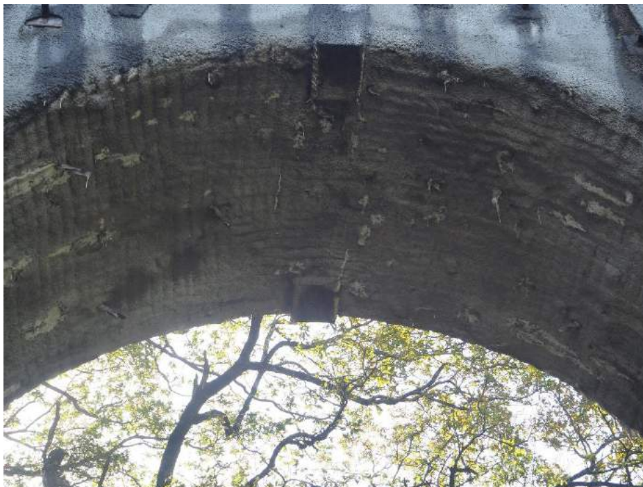
201029 118 Fisuras, eflorescencias y eslatactitas en bóveda vano 7
