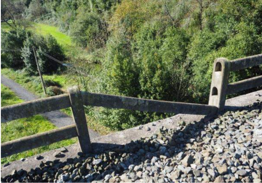
Figura 12. Barandilla rota sobre el vano 4 en el lado derecho
