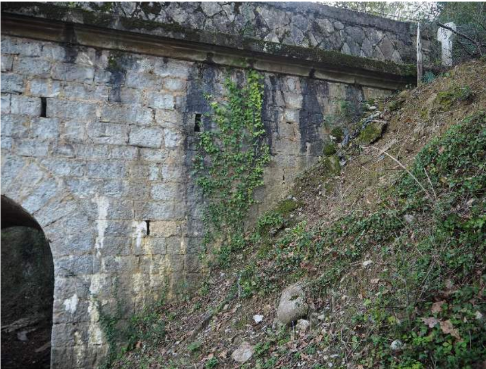
201029 252 Muro en vuelta izquierdo estribo 1 con humedades y vegetación
