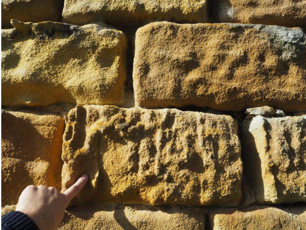
Figura 9. Detalle de la arenización y pérdida del material de junta característico de la fábrica de las pilas.
