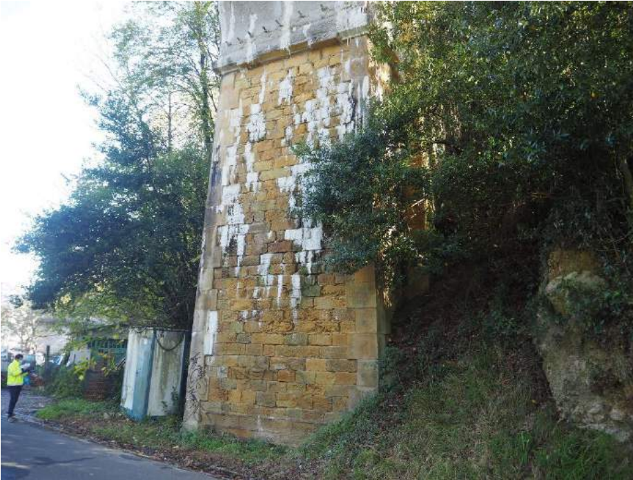
201029 107 Muro frontal de estribo 2 con eflorescencias y arenización
