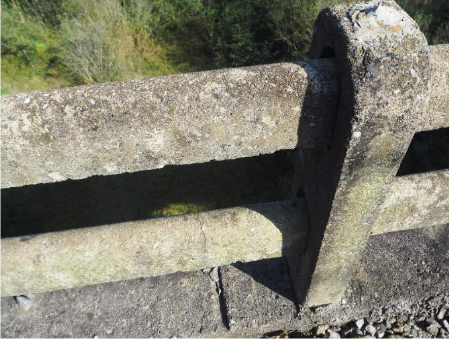
201029 059 Fisura en barandilla lado izquierdo
