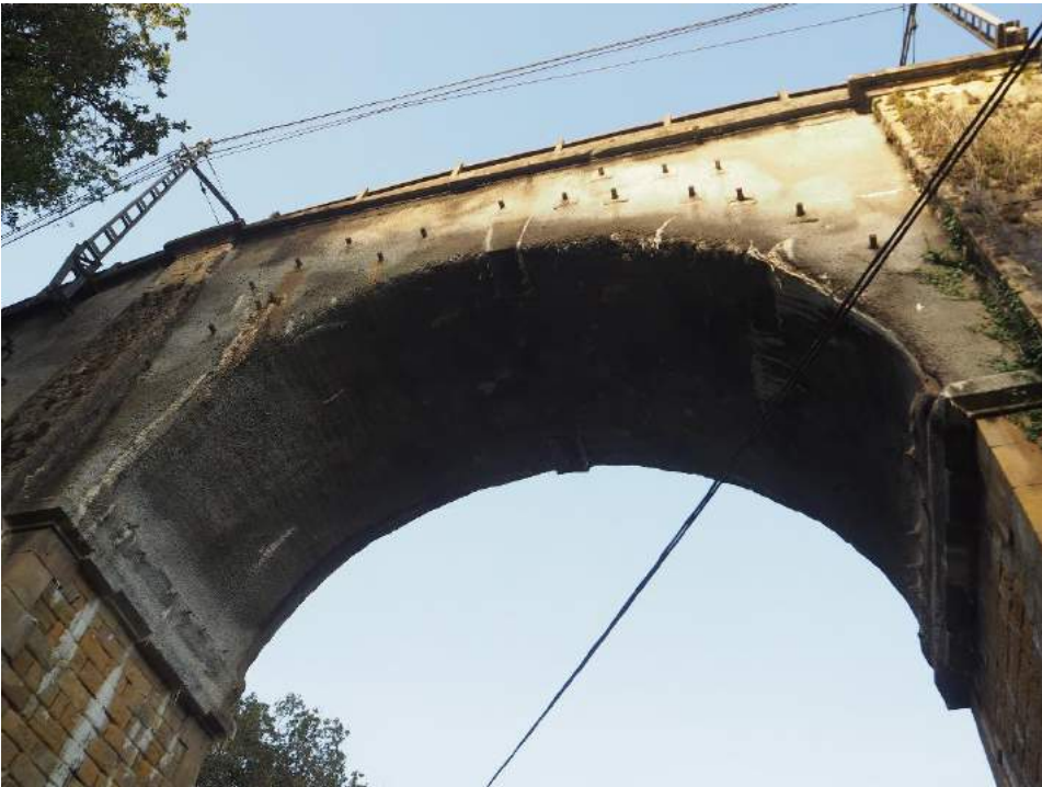
201029 224 Bóveda vano 2 con fisuras y eflorescencias
