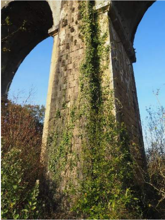
201029 185 Pila 3 con humedades y vegetación enraizada
