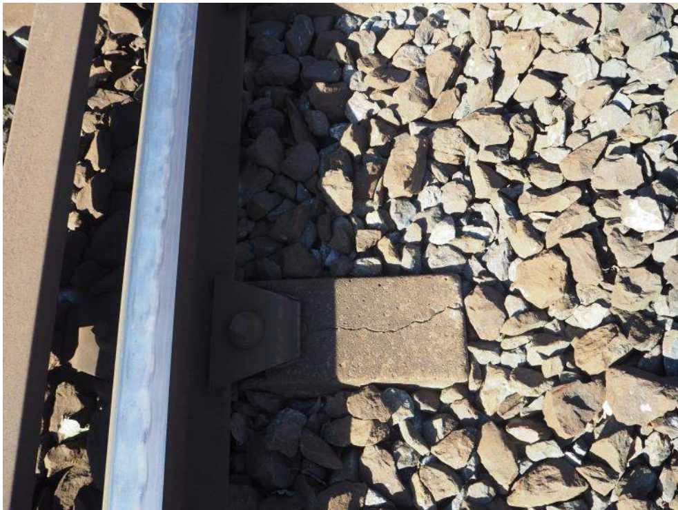
Figura 20. Fisura en traviesa de hormigón
