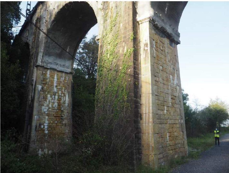
201029 216 Pila 2 lado derecho con humedades y vegetación
