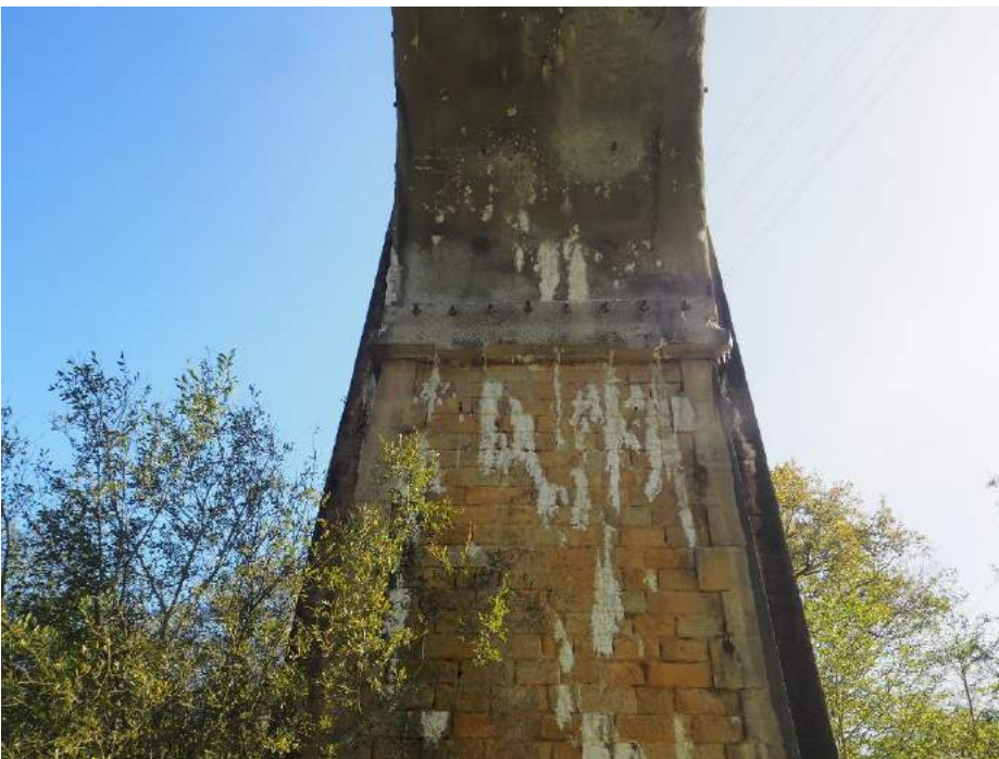
201029 144 Pila 5 lado vano 5 con eflorescencias y arenización
