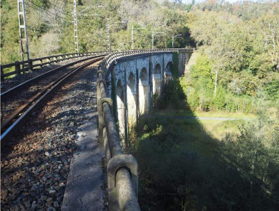
201029 019 Deformación en imposta por asiento en lado izquierdo desde estribo 2
