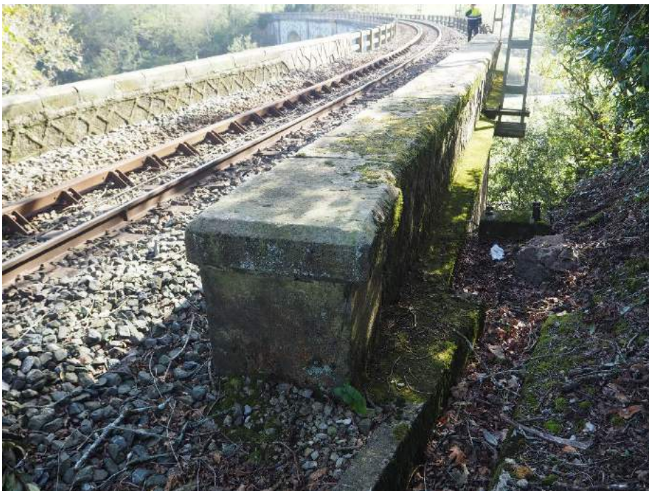
201029 098 Murete derecho de fábrica con leves daños en estribo 1
