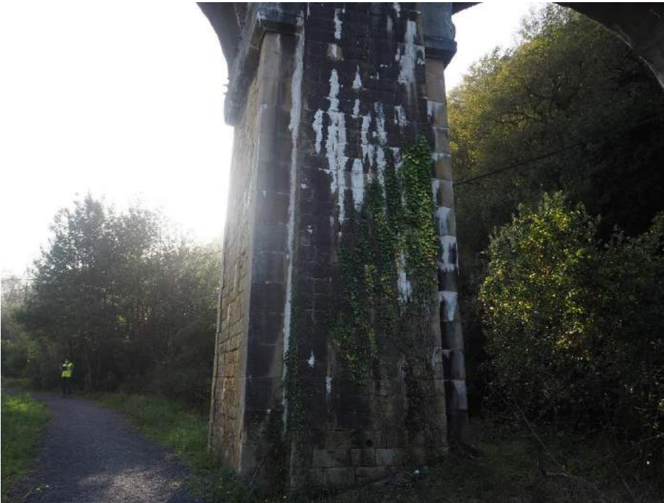
201029 200 Pila 2 lado izquierdo con humedades y eflorescencias
