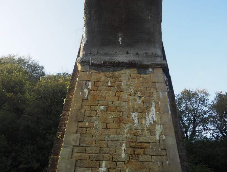
201029 207 Pila 2 lado vano 3 con eflorescencias y arenización
