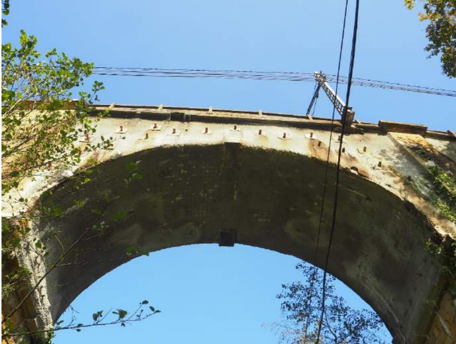
201029 153 Bóveda vano 6 con fisuras y eflorescencias
