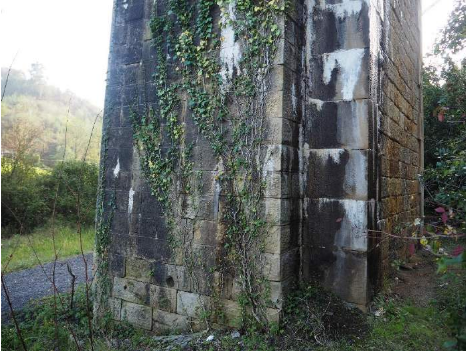
201029 245 Pila 2 lado izquierdo con humedades y vegetación
