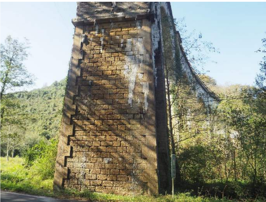
201029 120 Pila 6 lado vano 7 con eflorescencias y leve arenización
