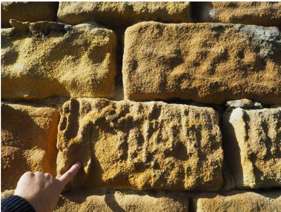
201029 166 Detalle de pila 4 lado vano 5 con eflorescencias y arenización
