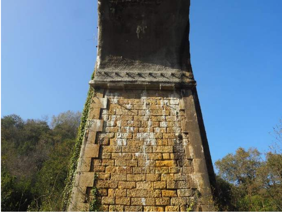
201029 165 Pila 4 lado vano 5 con eflorescencias y arenización
