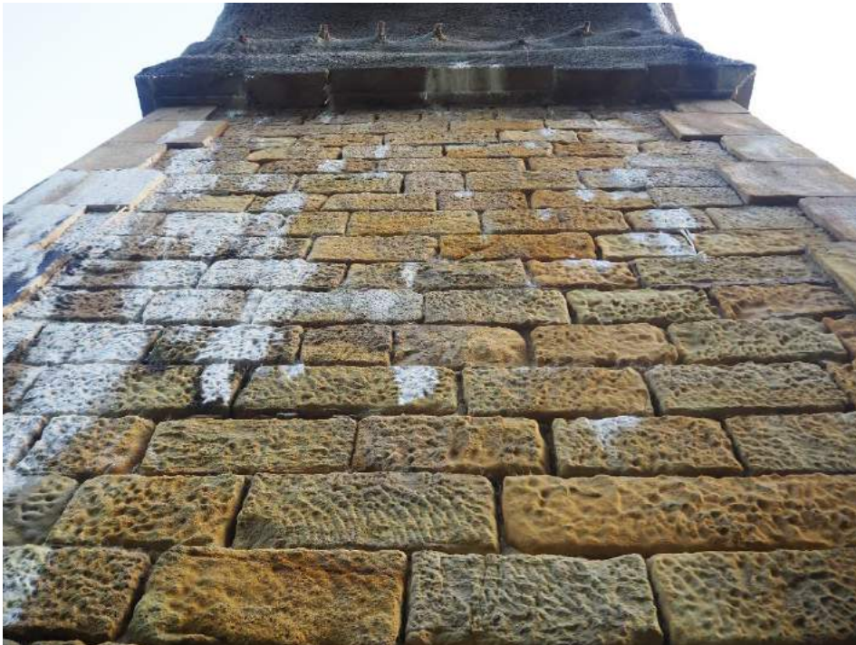
201029 238 Pila 2 lado vano 2 con eflorescencias y arenización
