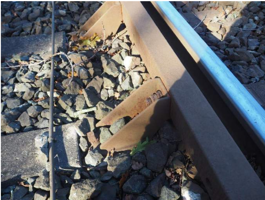
201029 030 Corrosión suprficial y picaduras en encariladora
