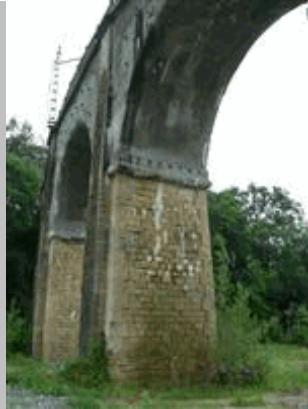
08 Aspecto de bóvedas gunitadas
