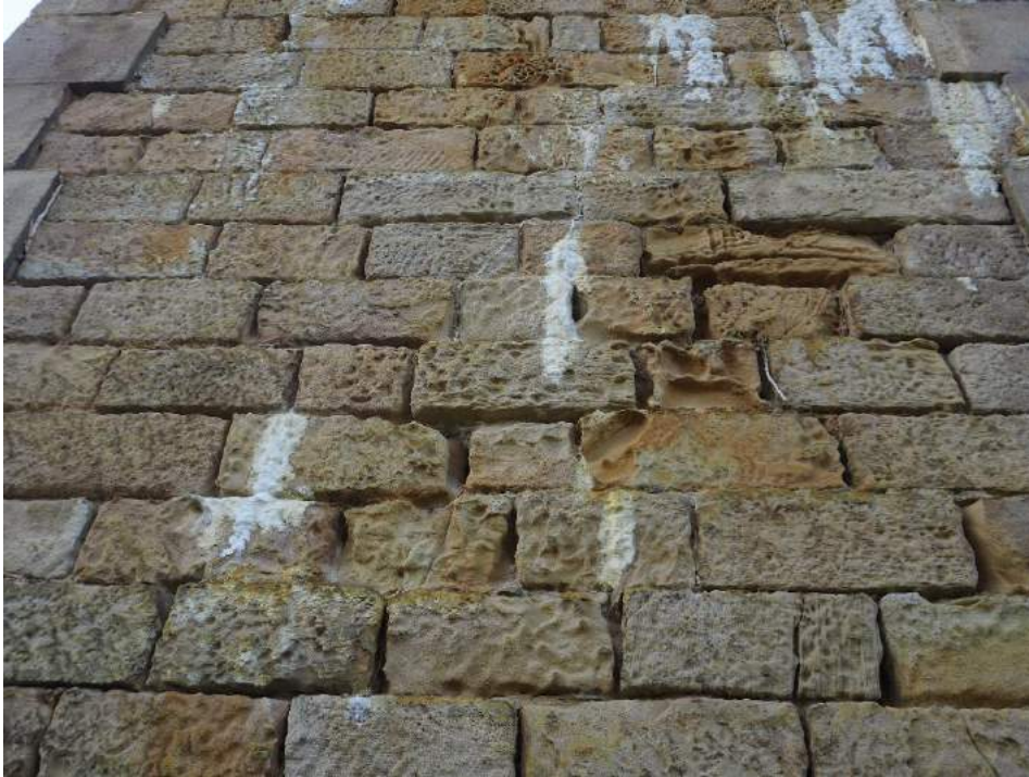
201029 209 Detalle de arenización en pila 2 lado vano 3
