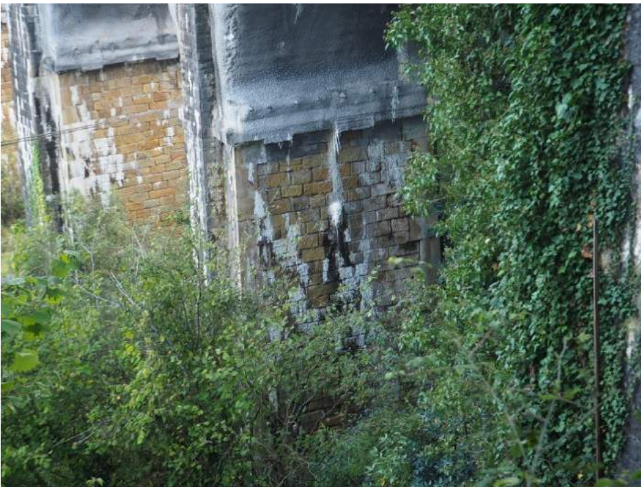
201029 264 Pila 1 lado vano 1 con eflorescencias y humedades
