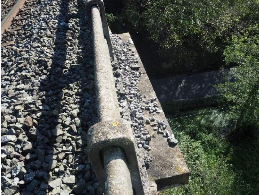
201029 053 Imposta de fábrica en pila 4 lado derecho con derrame de balasto
