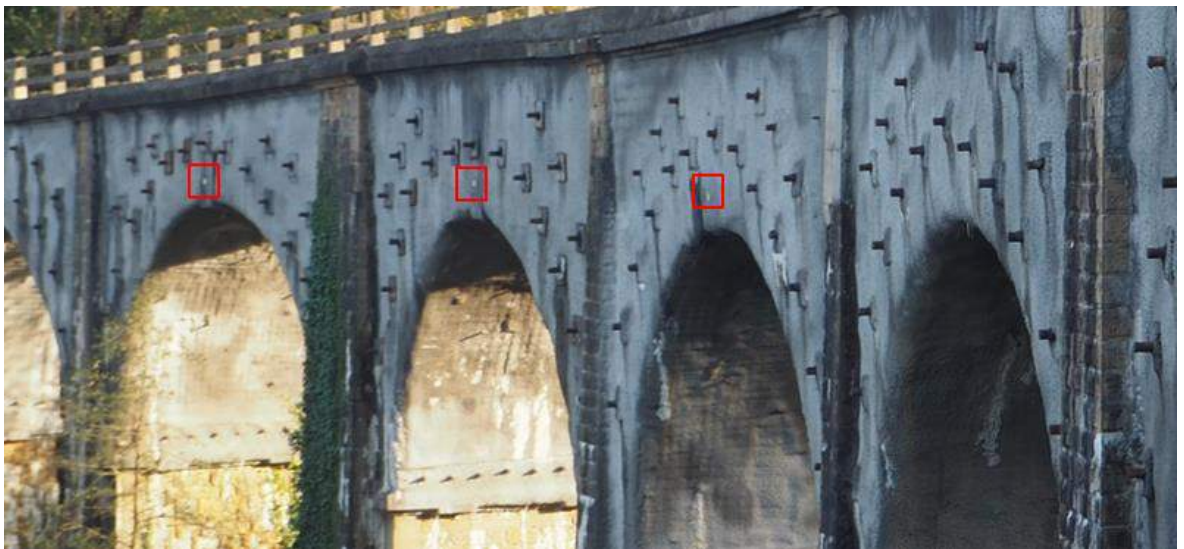
Figura 23. Dianas para mediciones topográficas en las claves de las bóvedas, en lado izquierdo
