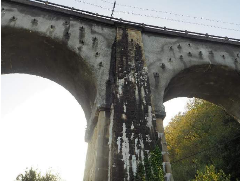
201029 201 Pila 2 lado izquierdo con humedades y eflorescencias
