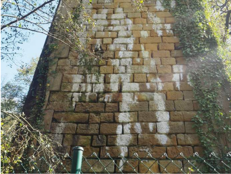
201029 161 Pila 6 lado vano 6 con eflorescencias y arenización
