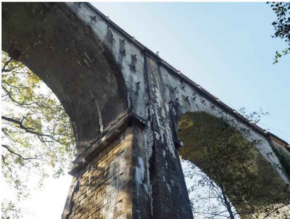
201029 126 Pila 6 lado izquierdo y bóvedas 6 y 7 con humedades
