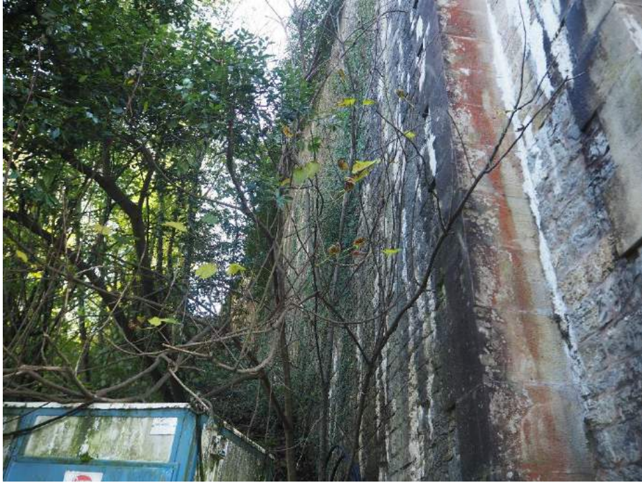
201029 113 Humedades y vegetación enraizada en muro en vuelta izquierdo estribo 2
