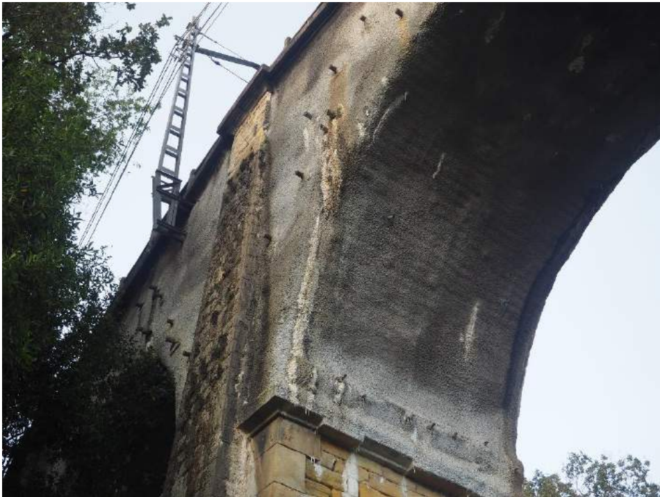
201029 234 Bulones con humedades en arranque de bóveda vano 2 lado derecho
