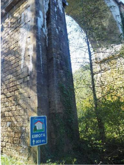
201029 125 Pila 6 lado izquierdo con humedades y vegetación enraizada
