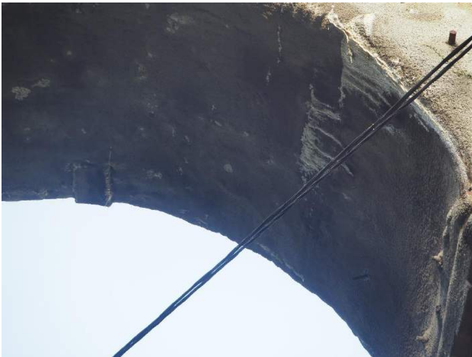
201029 226 Bóveda vano 2 con fisuras y eflorescencias
