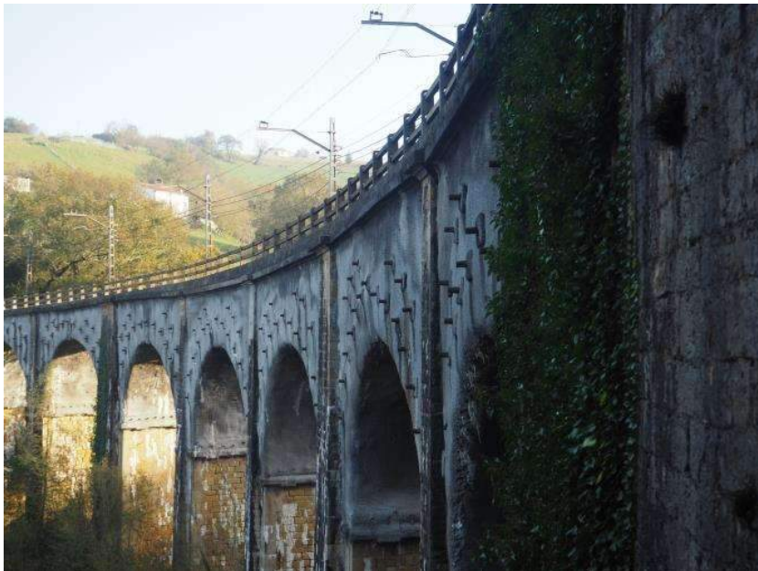
Figura 11. Vista del asiento registrado en las pilas P-2, P-3, P-4 y P-5 desde el estribo 2, observable por la pérdida de alineación de la imposta de fábrica
