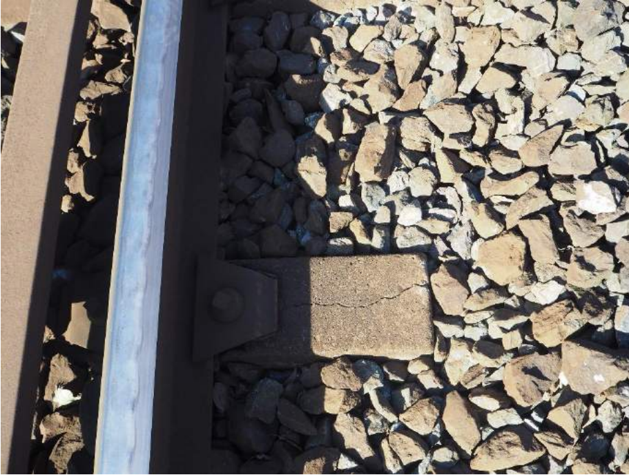
201029 047 Fisura en traviesa
