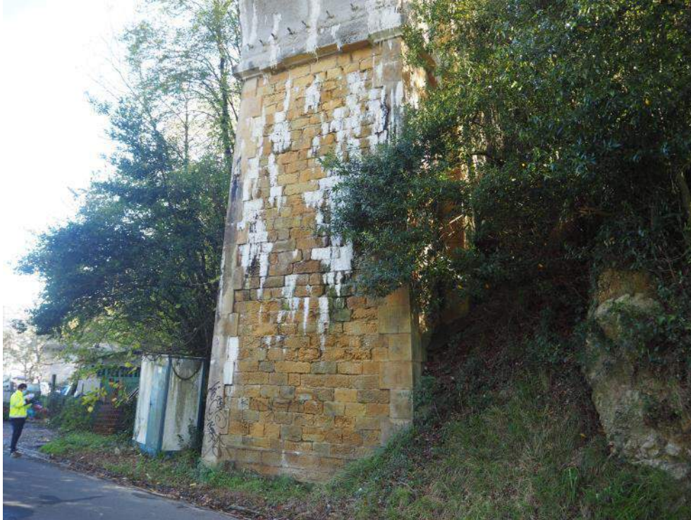
Figura 6. Vista del muro frontal del estribo 2, con eflorescencias y leves arenizaciones
