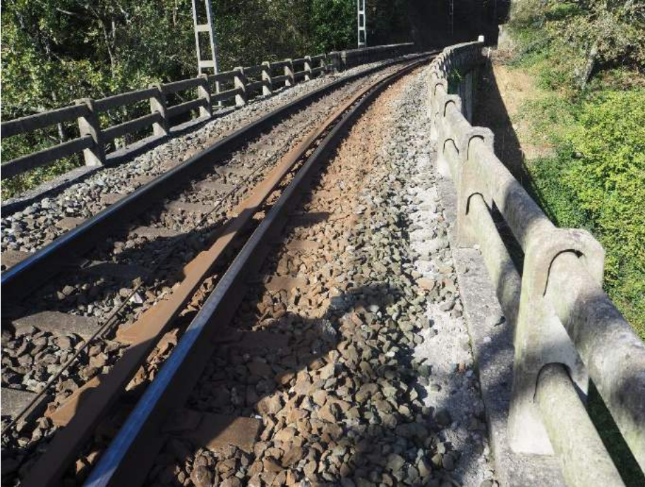
201029 079 Banqueta de balasto en lado izquierdo sobre vano 4
