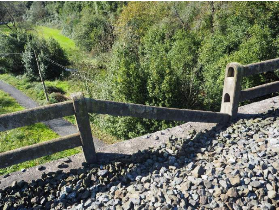
201029 068 Rotura de barandilla derecha sobre vano 4
