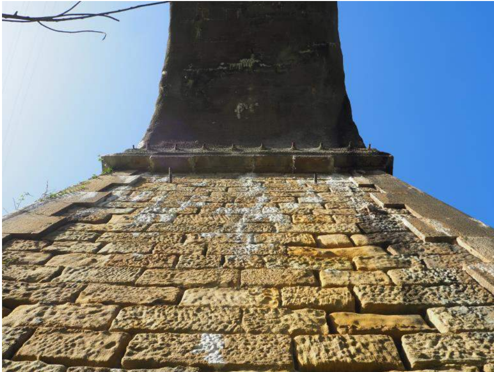
Figura 15. Mechinales de drenaje en la cabeza de las pilas, sin circulación de agua
