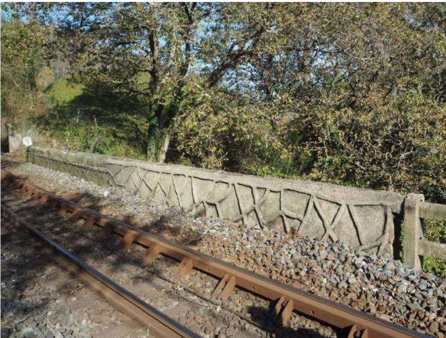
201029 084 Murete derecho de fábrica con leves daños en estribo 1
