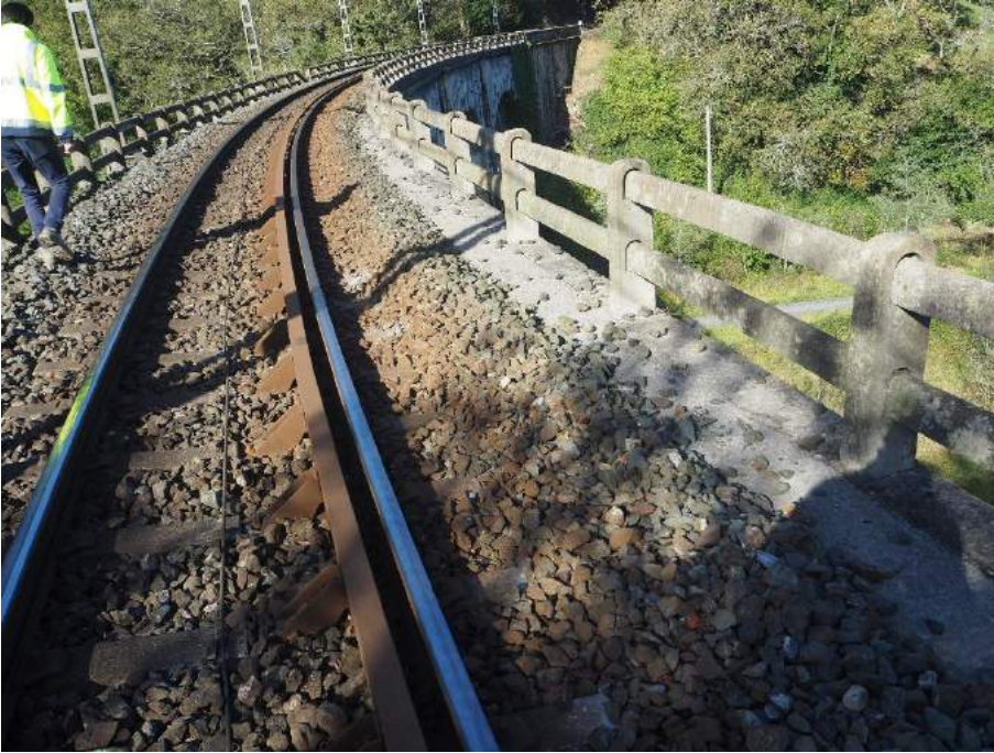
201029 039 Banqueta de balasto en lado izquierdo
