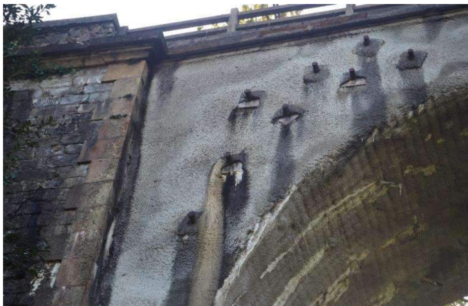
Figura 13. Filtraciones desde los anclajes de los bulones y desprendimiento del gunitado
