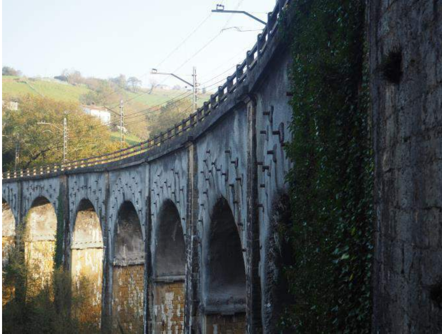
Figura 11. Vista del asiento registrado en las pilas P-2, P-3, P-4 y P-5 desde el estribo 2, observable por la pérdida de alineación de la imposta de fábrica
