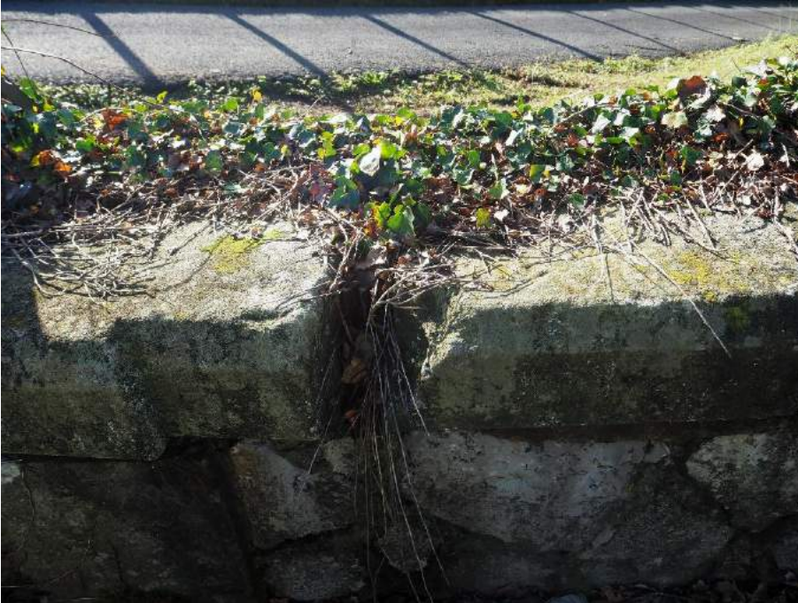
201029 011 Leve rotura en murete derecho de fábrica con leves daños
