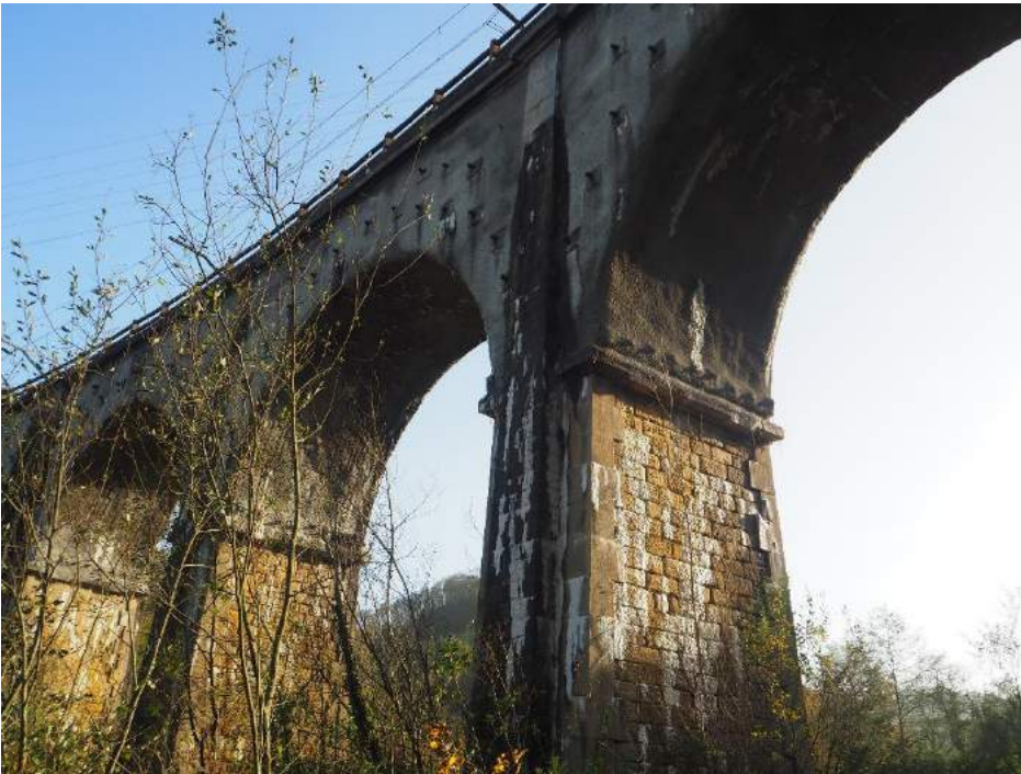
201029 196 Bulones con humedades en bóvedas vanos 3 y 4 lado izquierdo
