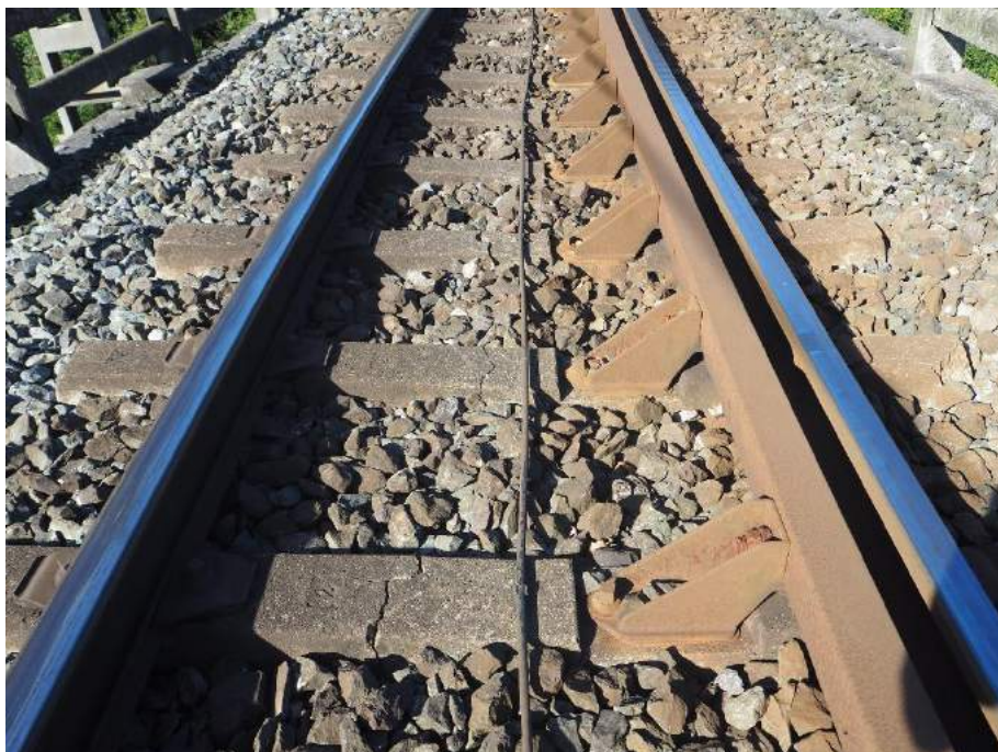
201029 065 Grietas y roturas en traviesa de hormigón sobre vano 4
