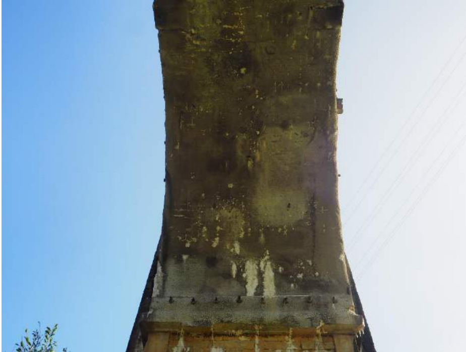
201029 145 Fisuras y eflorescencias en bóveda vano 5
