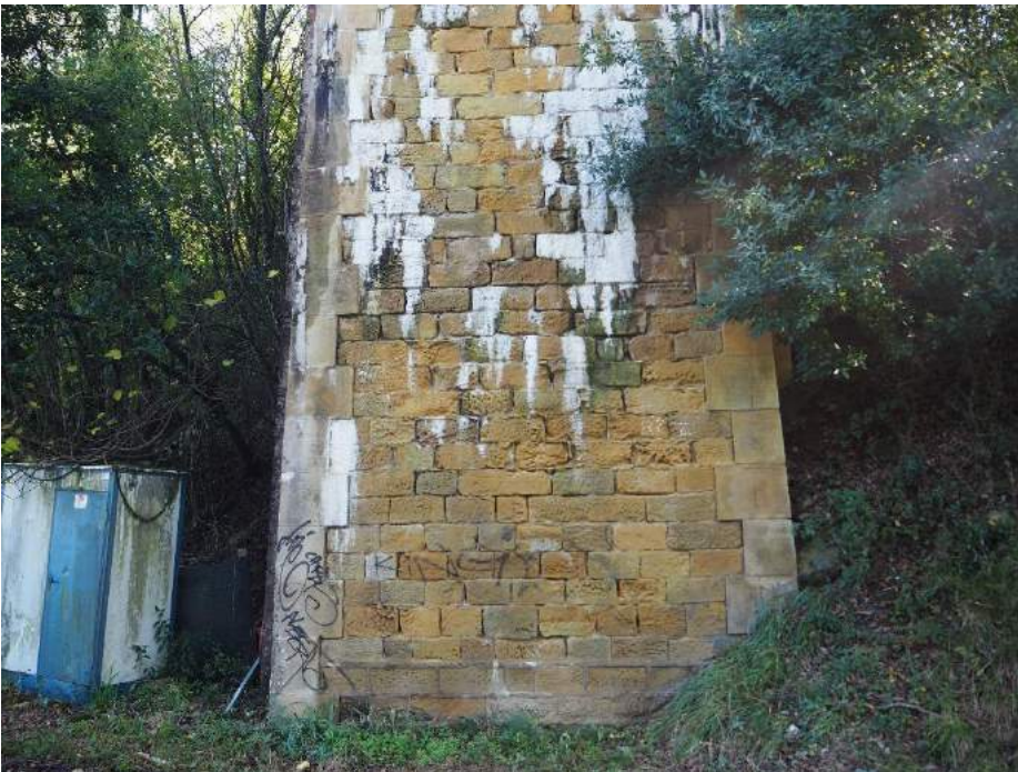
201029 108 Muro frontal de estribo 2 con eflorescencias y arenización
