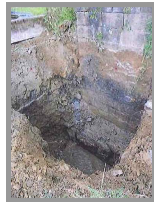
ACTUACIÓN 1 REFUERZO DE LAS CIMENTACIONES MEDIANTE LA EJECUCIÓN DE MICROPILOTES Y ENCEPADO PERIMETRAL
