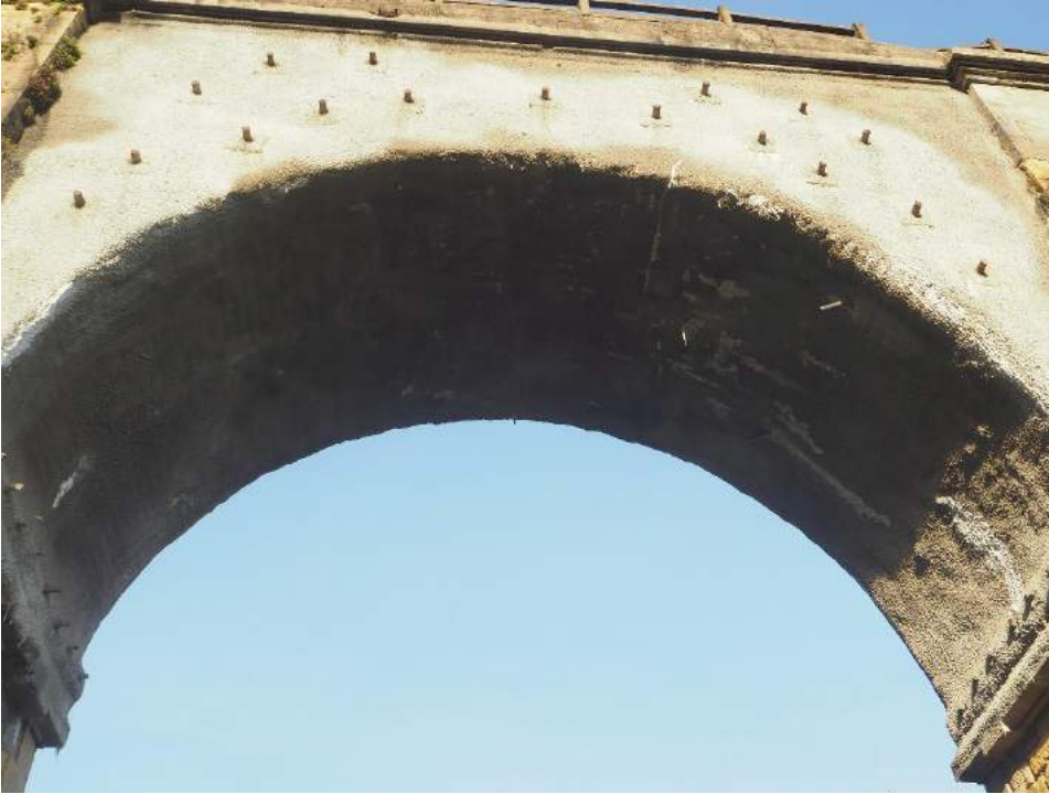
201029 215 Bóveda vano 3 con fisuras y eflorescencias
