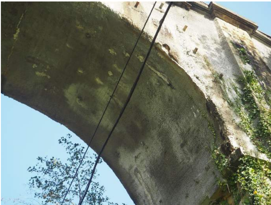
201029 154 Detalle de rotura en gunita bóveda vano 6 lado derecho
