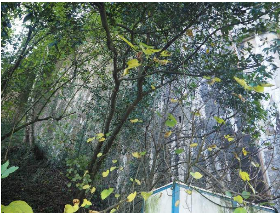
201029 114 Humedades y vegetación enraizada en muro en vuelta izquierdo estribo 2
