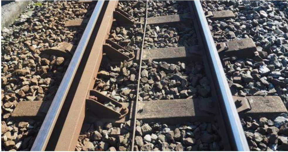
Figura 19. Traviesa de hormigón rota su lado izquierdo, con giro adicional respecto a su posición original
