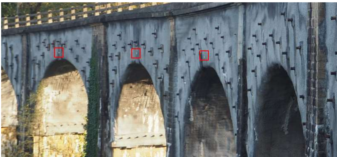
Figura 23. Dianas para mediciones topográficas en las claves de las bóvedas, en lado izquierdo
