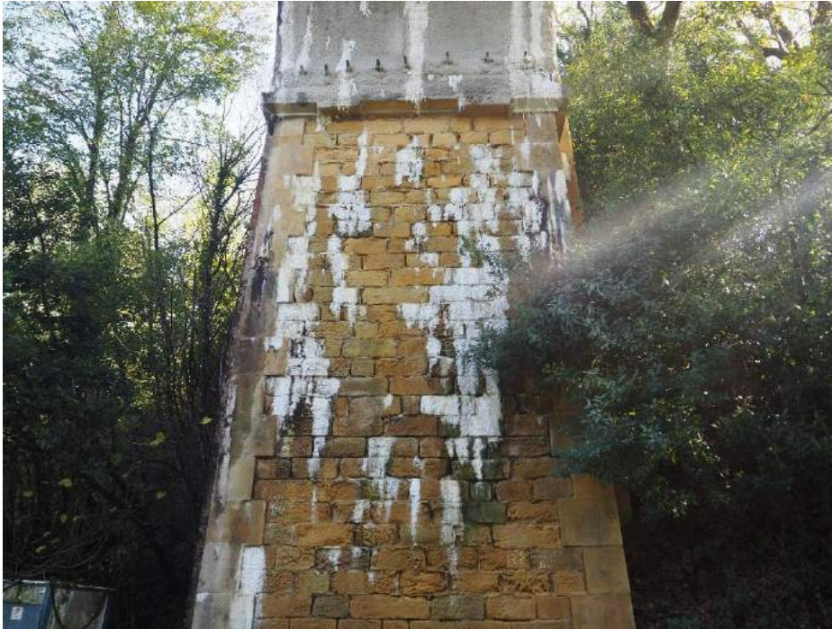
201029 109 Muro frontal de estribo 2 con eflorescencias y arenización
