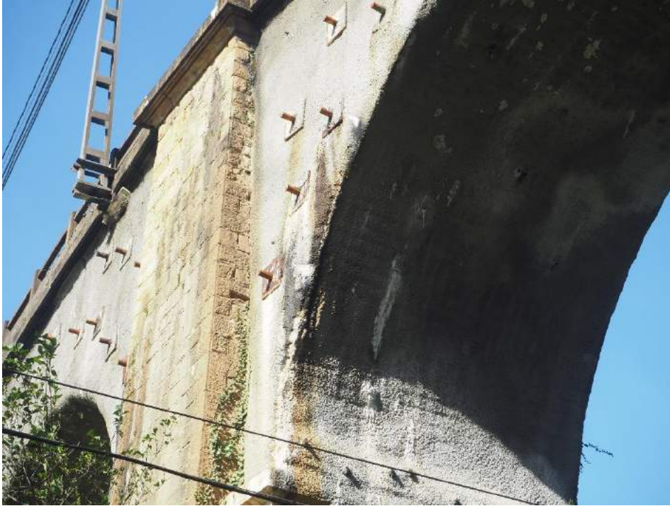
201029 133 Humedades en bulones en bóveda vano 6 lado derecho junto pila 5
