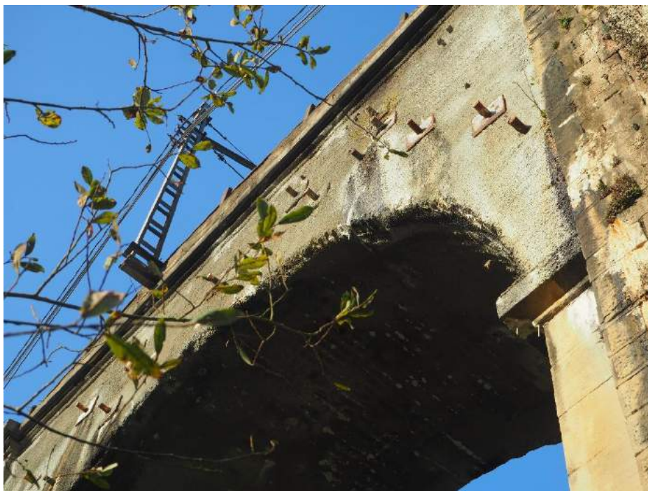
201029 189 Humedades en bulones de bóveda vano 3 lado derecho
