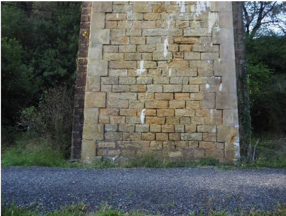
201029 206 Pila 2 lado vano 3 con eflorescencias y arenización
