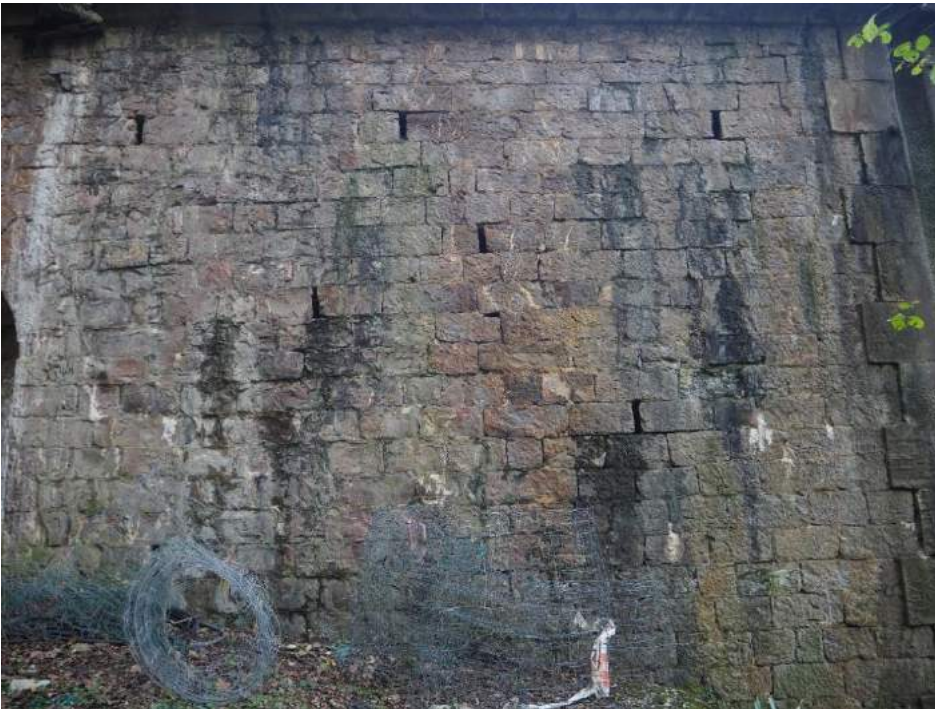
201029 268 Muro en vuelta derecho estribo 1 con humedades y vegetación
