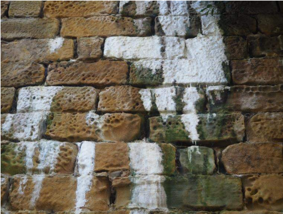
Figura 5. Costra calcárea en fábrica de pila, junto con manchas oscuras
