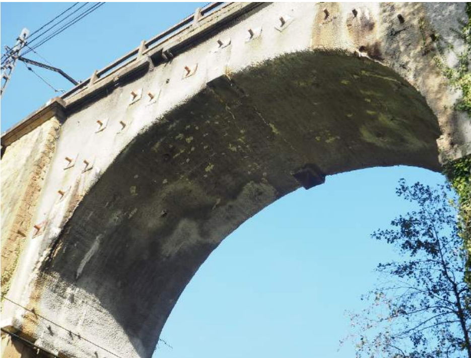
201029 132 Fisuras y eflorescencias en bóveda vano 6
