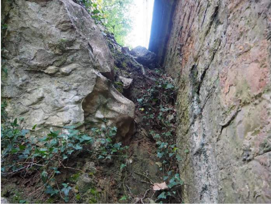
201029 273 Talud de roca en muro en vuelta derecho estribo 1
