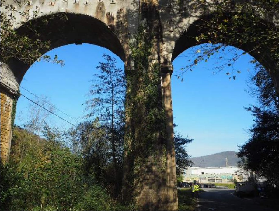
201029 127 Pila 6 lado derecho con humedades y vegetación enraizada
