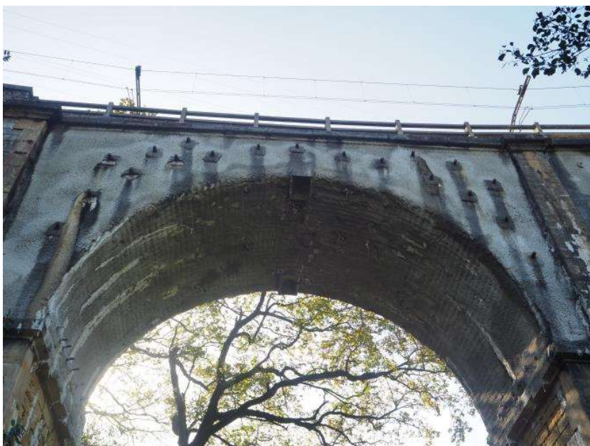
Figura 12. Vista del asiento registrado en las pilas P-2, P-3, P-4 y P-5 desde el estribo 2, observable por la pérdida de alineación de la imposta de fábrica
