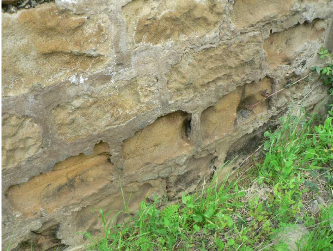
Figura 3. Alveolización por empleo de morteros de cemento
