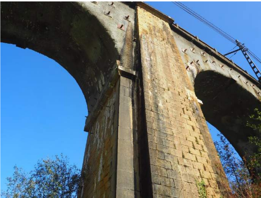
201029 148 Pila 5 lado derecho con humedades y leve vegetación enraizada
