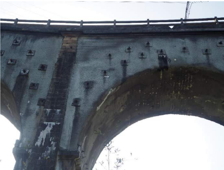
201029 176 Humedades en bulones de bóveda vanos 4 y 5 lado izquierdo
