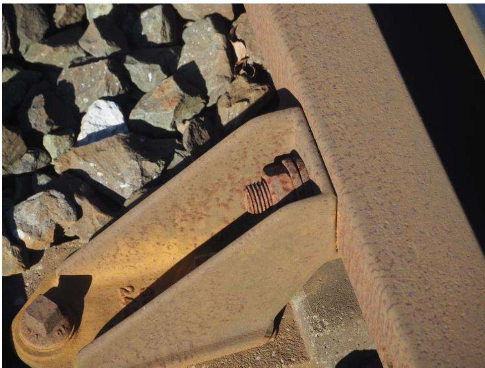
Figura 21. Picaduras y pátinas de óxido en la encarriladora de vía
