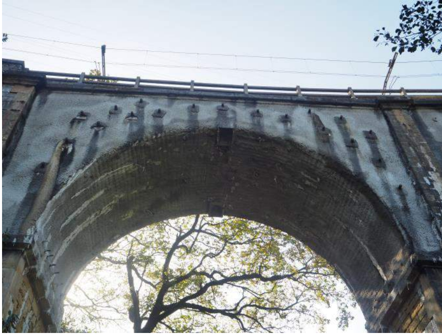
Figura 12. Vista del asiento registrado en las pilas P-2, P-3, P-4 y P-5 desde el estribo 2, observable por la pérdida de alineación de la imposta de fábrica
