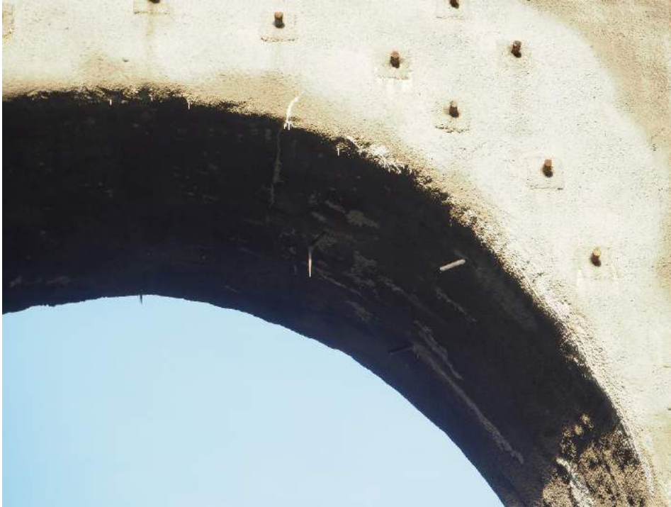
201029 213 Anclajes de bulones y mechinales en bóveda vano 3 lado derecho
