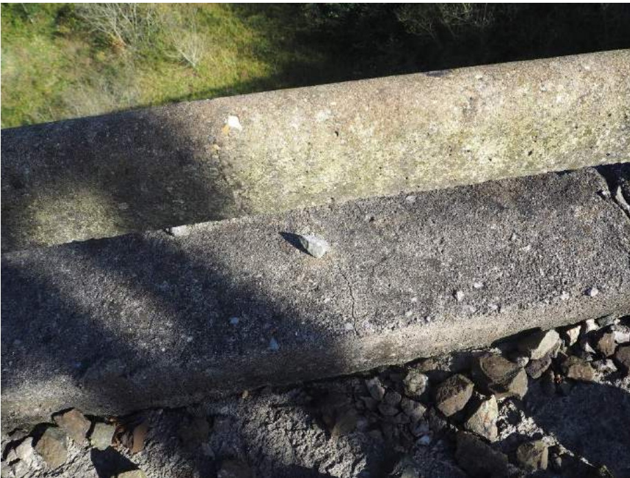
201029 060 Fisura en barandilla lado izquierdo
