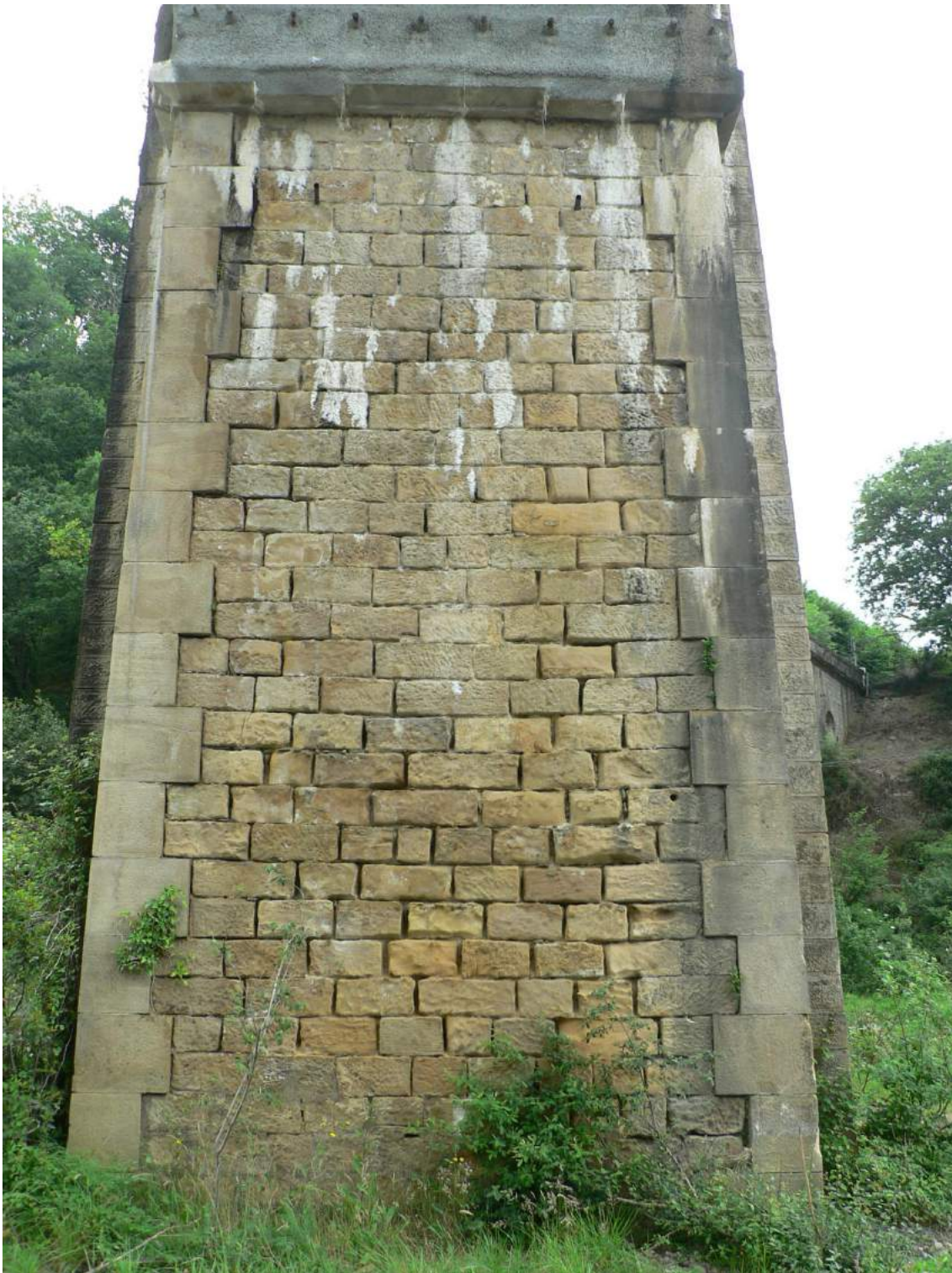
Figura 4. Aspecto de pila con deslavado de juntas
