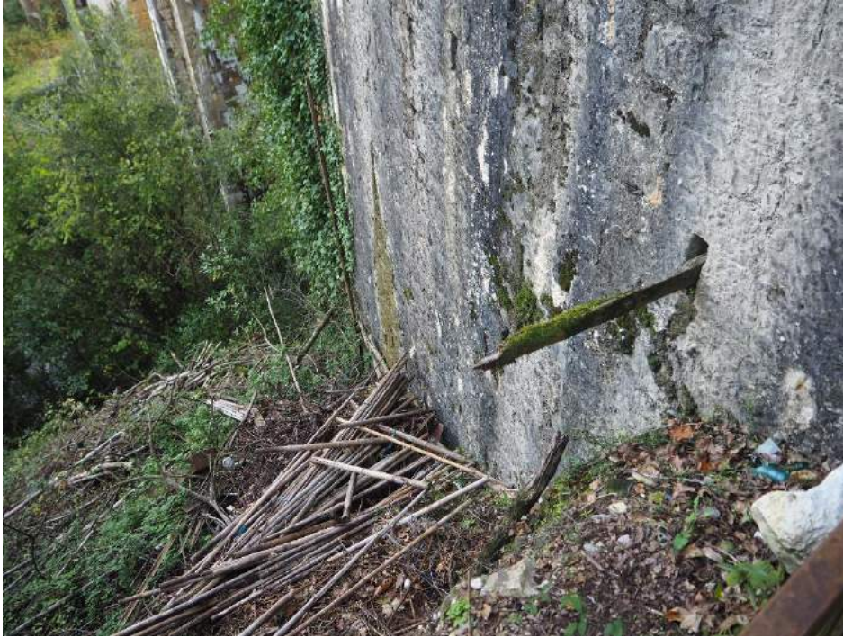
201029 257 Muro en vuelta izquierdo estribo 1 con humedades y vegetación
