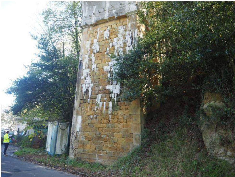
Figura 1. Vista del muro frontal del estribo 2, con eflorescencias y leves arenizaciones
