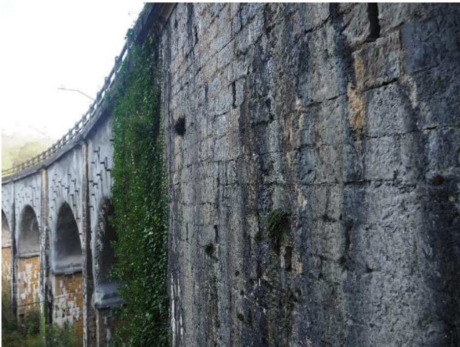
201029 258 Muro en vuelta izquierdo estribo 1 con humedades y vegetación
