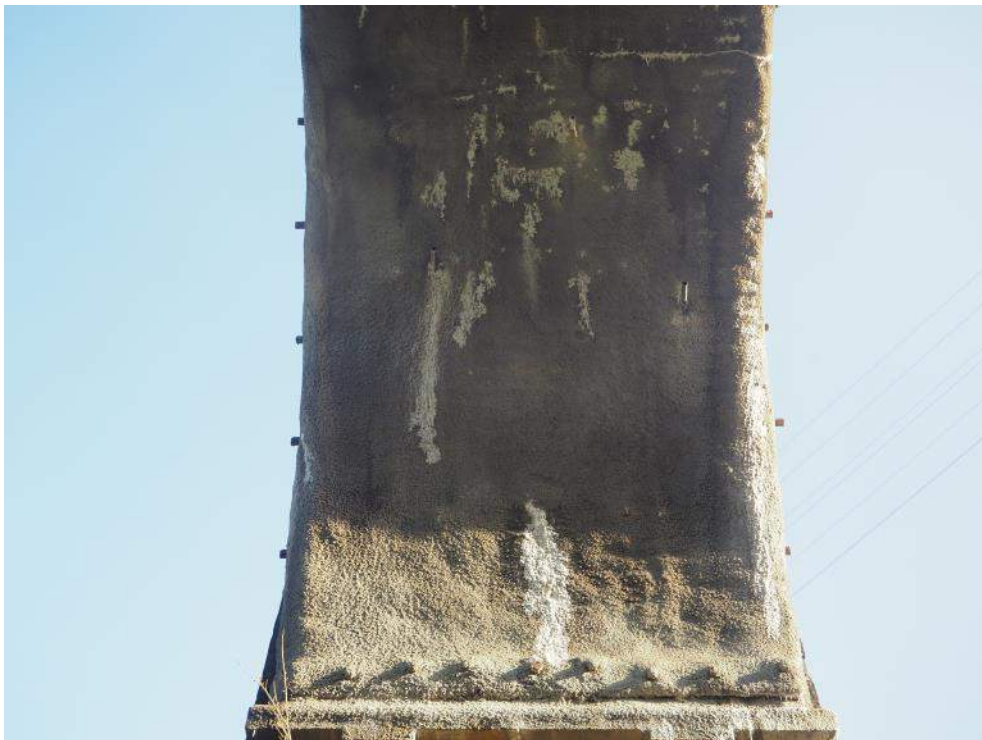
Figura 16. Mechinales de drenaje en los hombros de bóveda, sin circulación de agua
