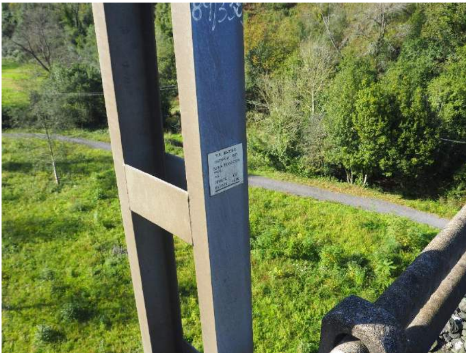
201029 054 Poste de catenaria y P.K.
