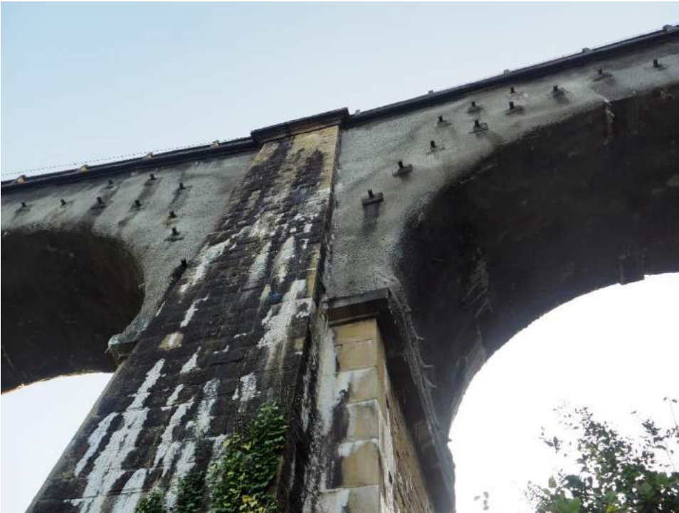
201029 243 Pila 2 lado izquierdo con humedades y eflorescencias
