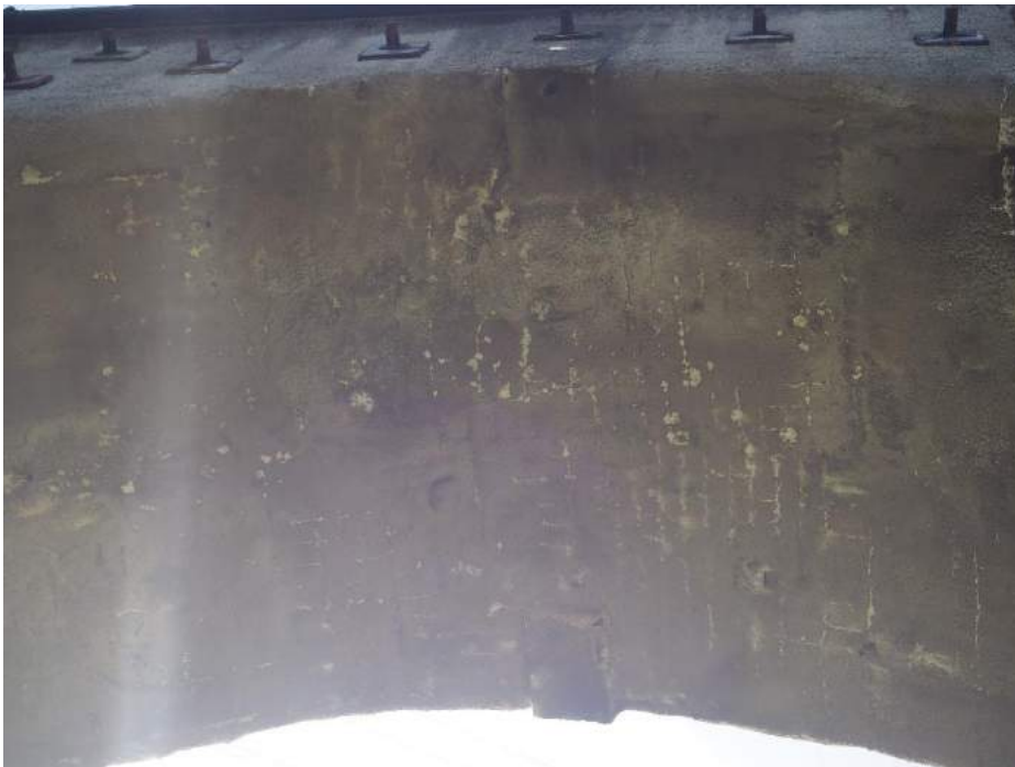
201029 142 Detalla de fisuras y eflorescencias en bóveda vano 5
