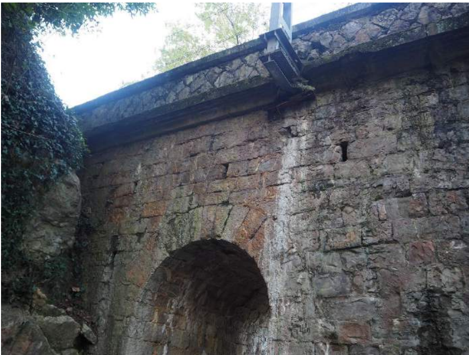
201029 270 Anclaje de poste de catenaria en muro en vuelta derecho
