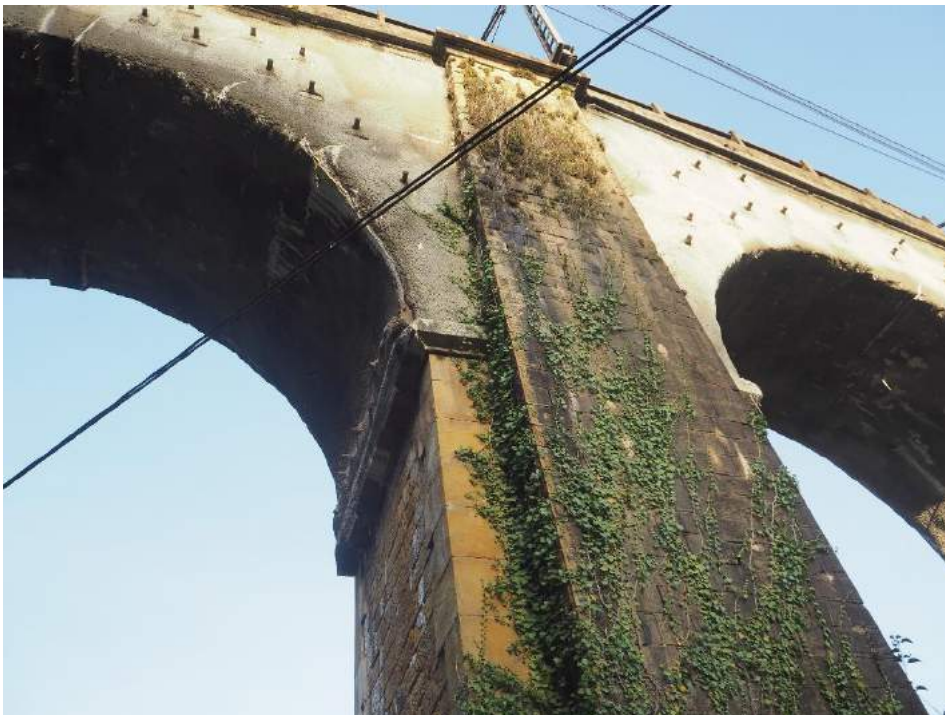
201029 230 Pila 2 lado derecho con humedades y vegetación
