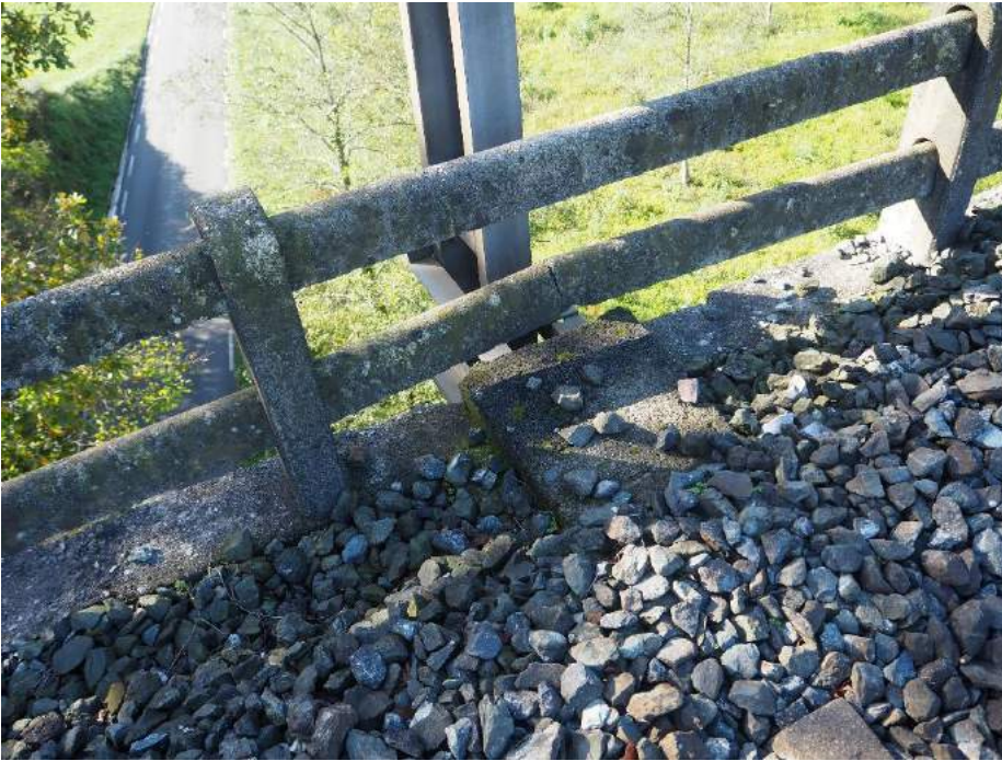
201029 035 Rotura en bardilla derecha sobre vano 7
