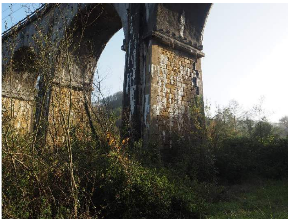
201029 194 Pila 3 lado vano 3 con eflorescencias y arenización
