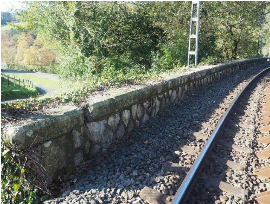
201029 006 Murete derecho de fábrica con leves daños
