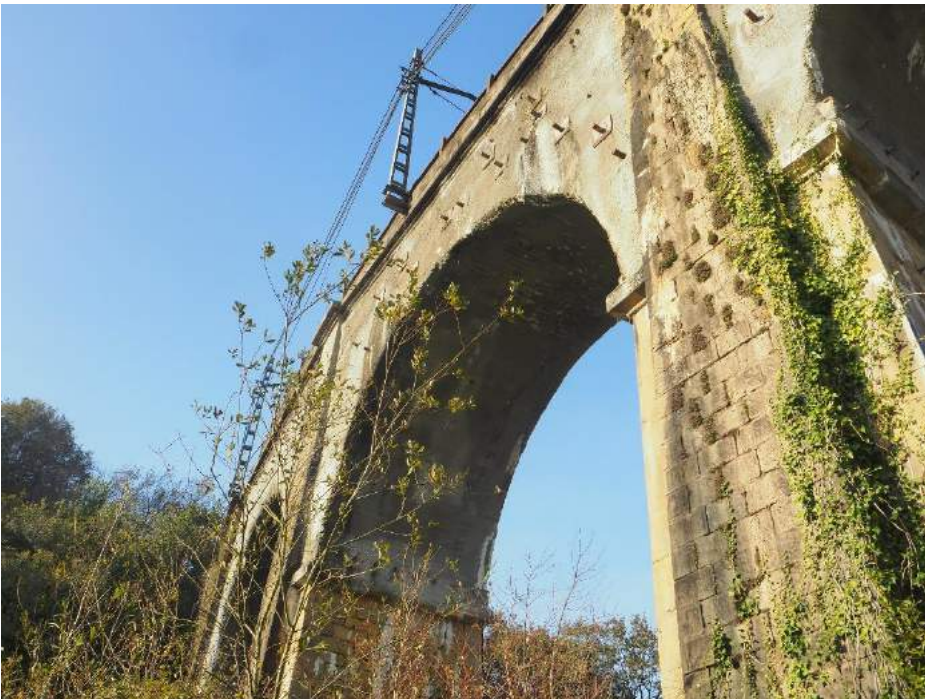
201029 184 Pila 3 y vano 3 lado derecho con huimedades y vegetación
