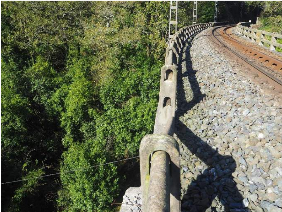
201029 070 Rotura de barandilla derecha sobre vano 4
