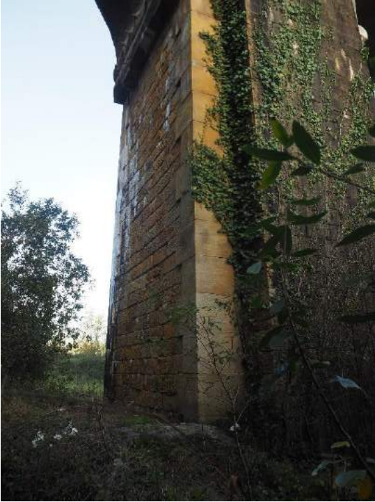
201029 235 Pila 2 lado derecho con humedades y vegetación
