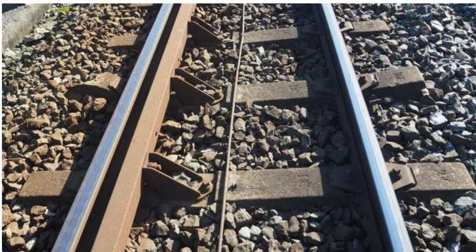
Figura 19. Travesía de hormigón rota su lado izquierdo, con giro adicional respecto a su posición original
