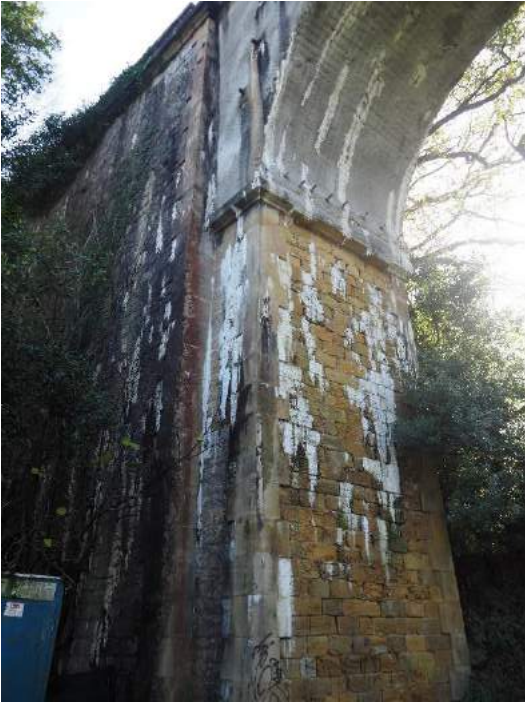
201029 119 Muro frontal de estribo 2 con eflorescencias y arenización
