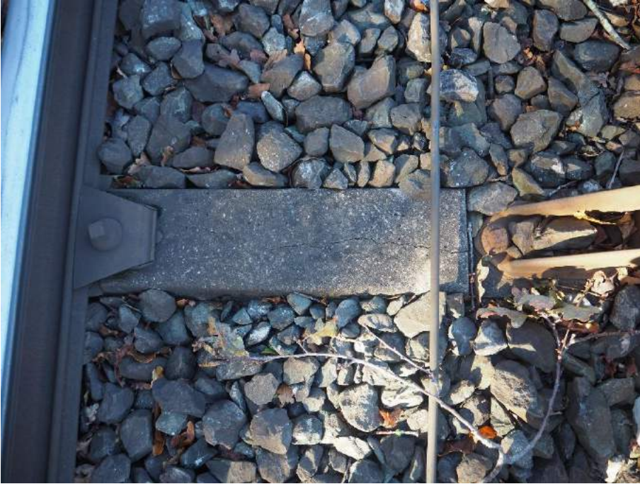
201029 031 Fisura en zona central de traviesa
