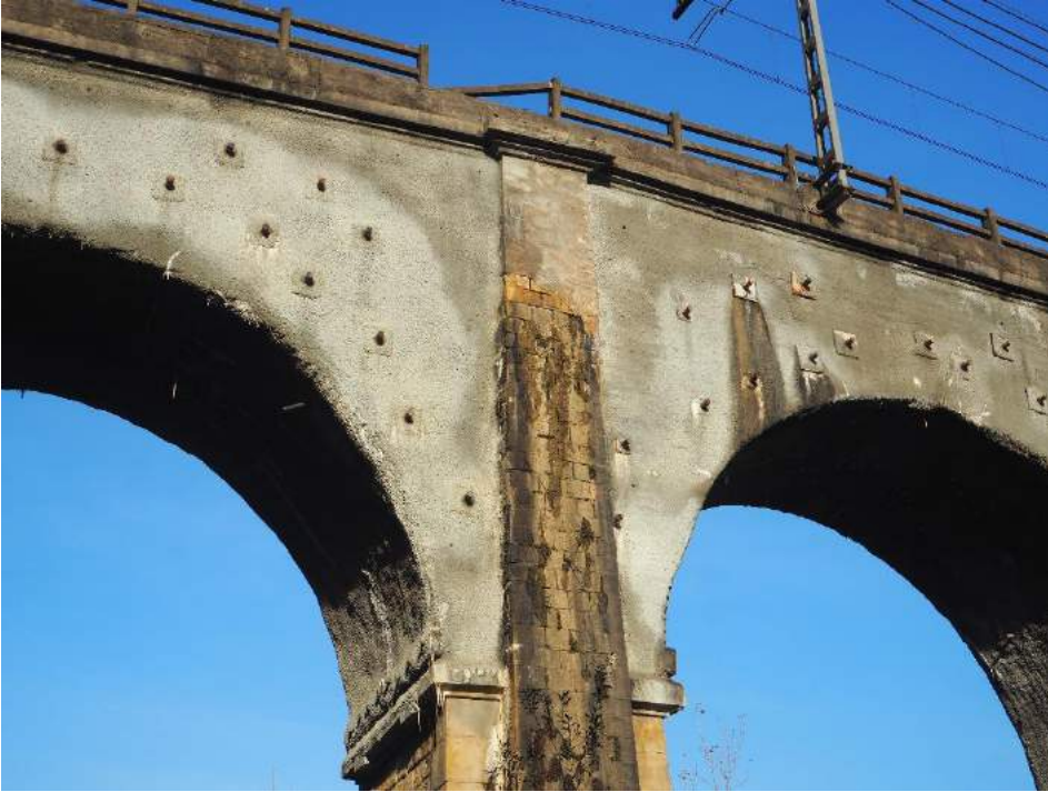
201029 211 Pila 3 lado derecho con humedades y restos de gunita
