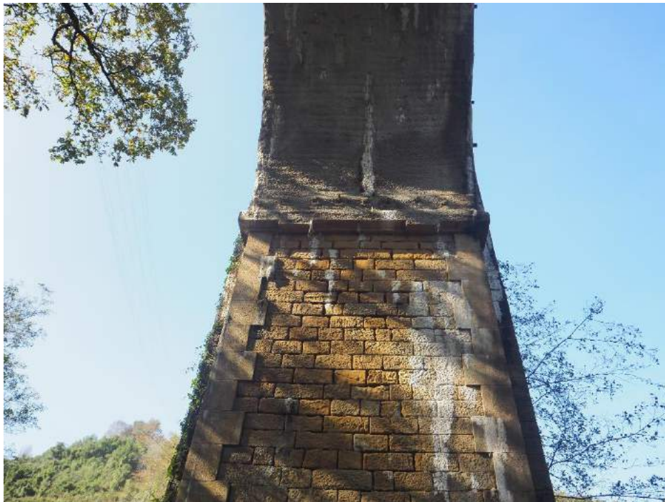
201029 122 Pila 6 lado vano 7 con eflorescencias y leve arenización
