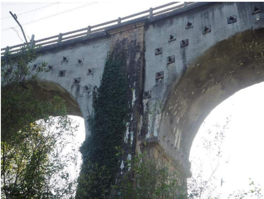
201029 138 Pila 5 lado izquierdo con humedades y vegetación enraizada
