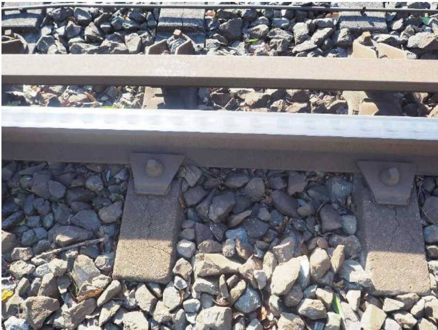
201029 010 Fisura en traviesa sobre estribo 2
