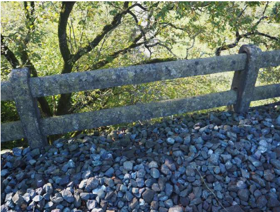
201029 028 Barandilla y derrame de balasto en lado derecho sobre vano 7
