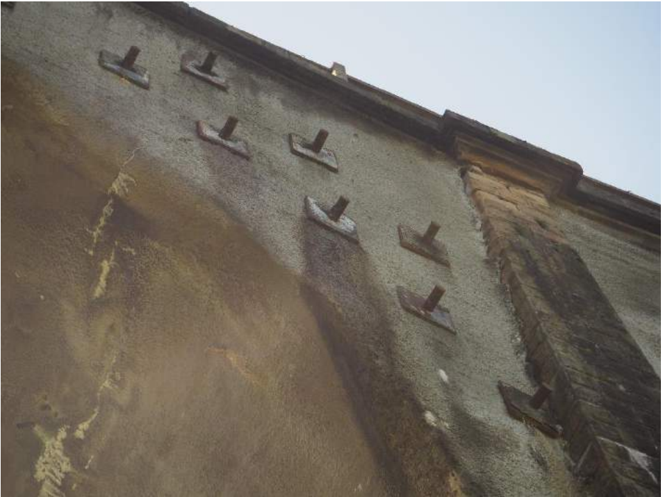
201029 171 Humedades en bulones de bóveda vano 5 lado izquierdo
