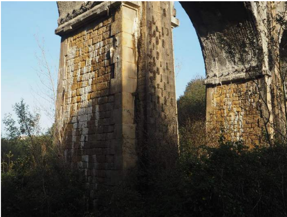
201029 214 Pila 3 lado derecho con humedades y leve vegetación
