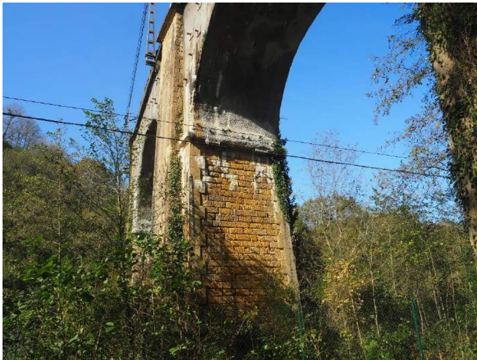
201029 134 Pila 5 lado vano 6 con eflorescencias y arenización
