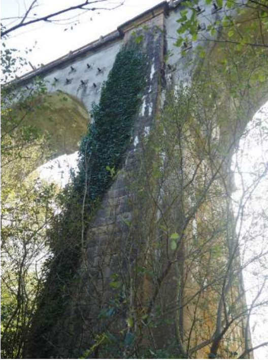
201029 139 Pila 5 lado izquierdo con humedades y vegetación enraizada
