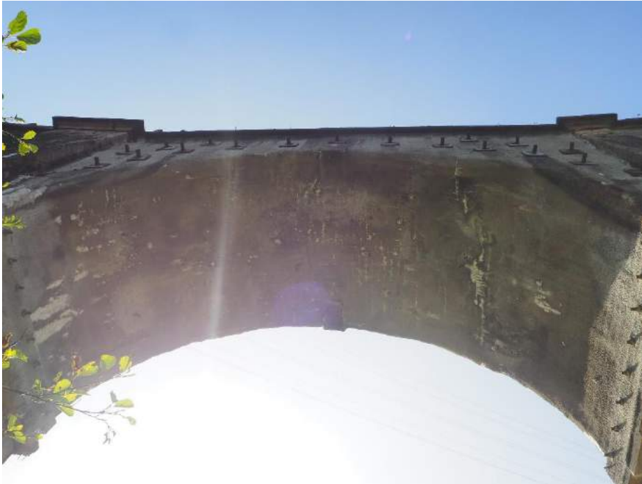
201029 141 Fisuras y eflorescencias en bóveda vano 5
