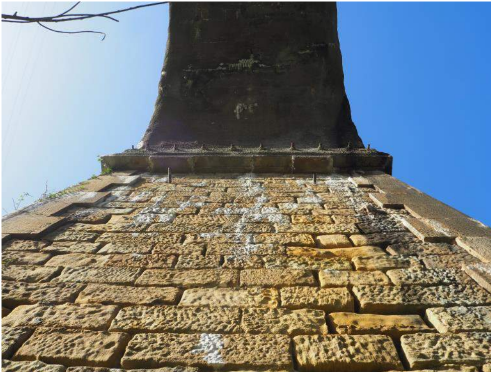
Figura 10. Mechinales de drenaje en la cabeza de las pilas, sin circulación de agua
