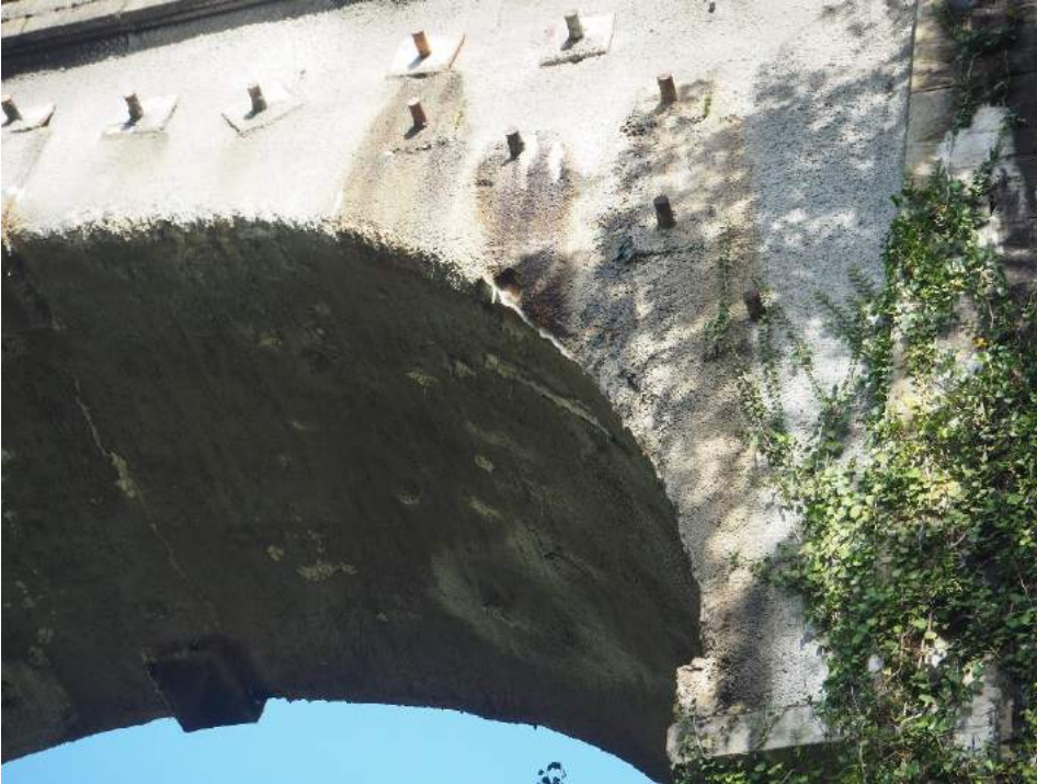
201029 131 Detalle de rotura en gunita bóveda vano 6 lado derecho
