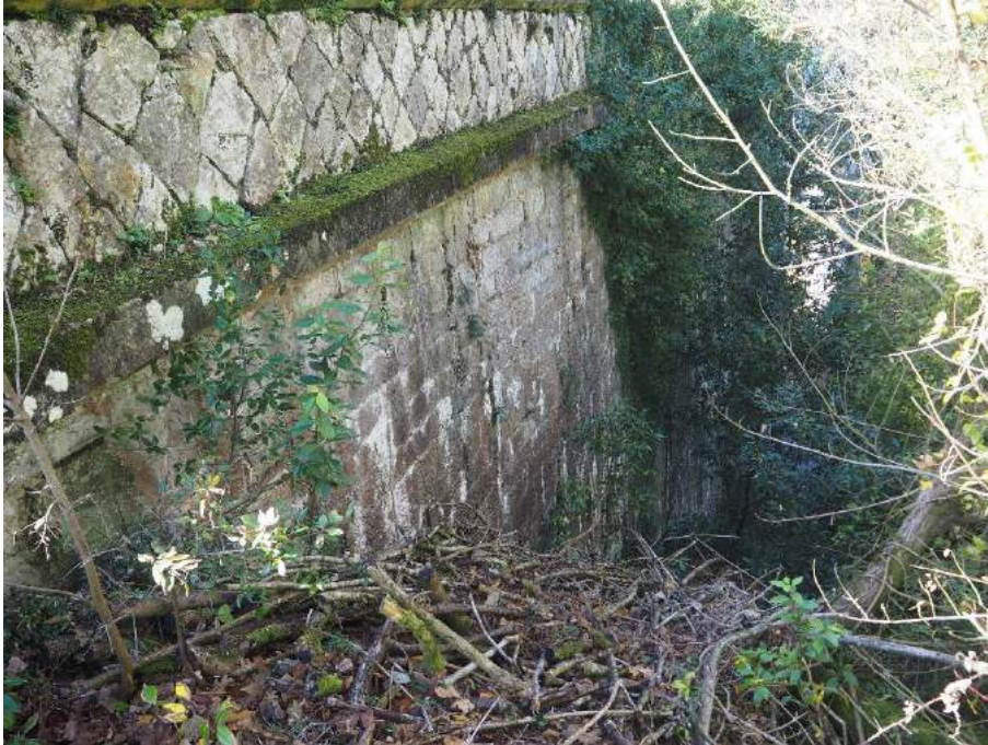
201029 009 Muro en vuelta izquierdo estribo 2 con eflorescencias
