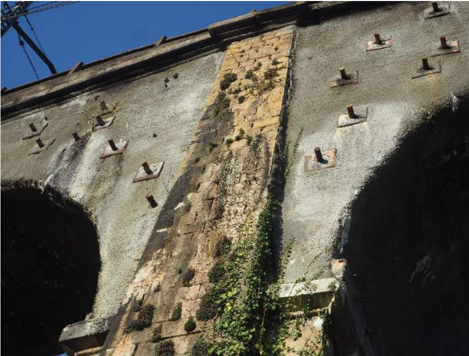
201029 187 Pila 3 con humedades y vegetación enraizada
