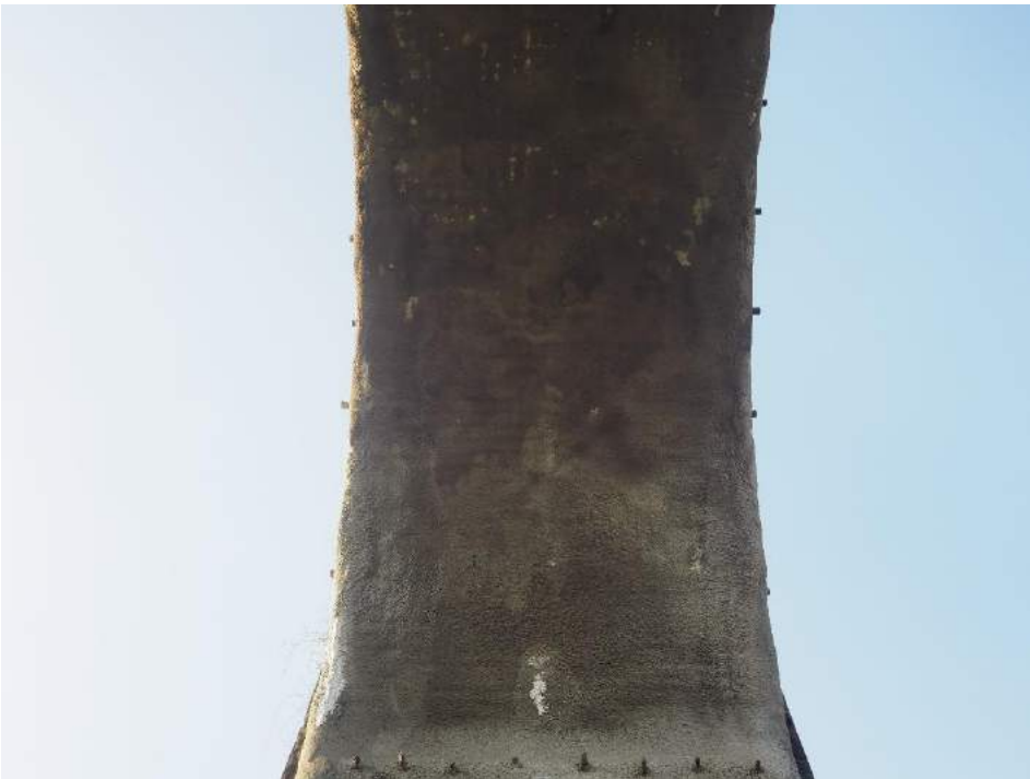
201029 208 Bóveda vano 3 con fisuras y eflorescencias
