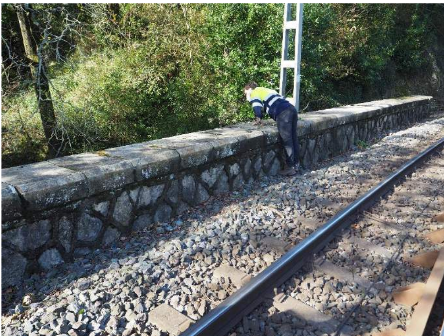
201029 086 Murete izquierdo de fábrica con leves daños en estribo 1
