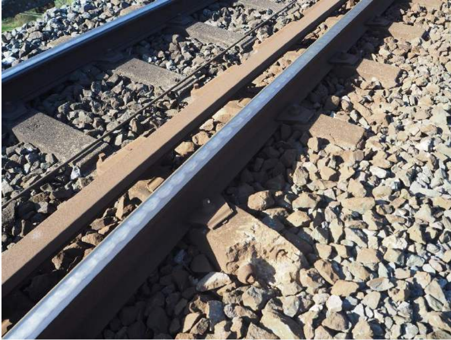
201029 061 Rotura en traviesa de hormigón lado izquierdo
