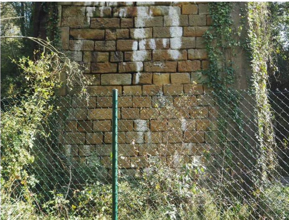
201029 160 Pila 6 lado vano 6 con eflorescencias y arenización
