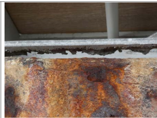
Imagen 21: Corrosión en platabandas de aluminio. Vista inferior
