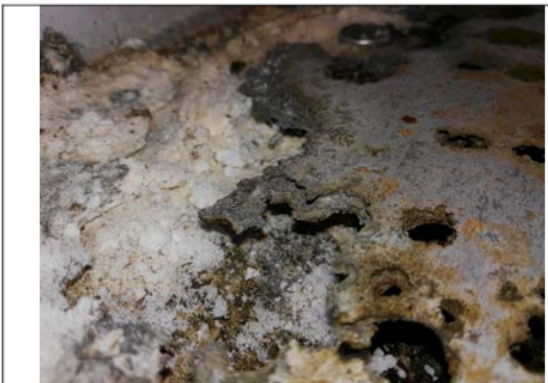
Imagen 20: Corrosión en platabandas de aluminio. Vista superior
