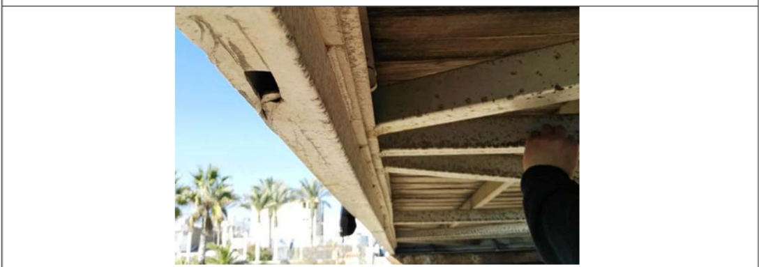
Imagen 23: Agujero detectado en el cordón lateral inferior de la celosía.
