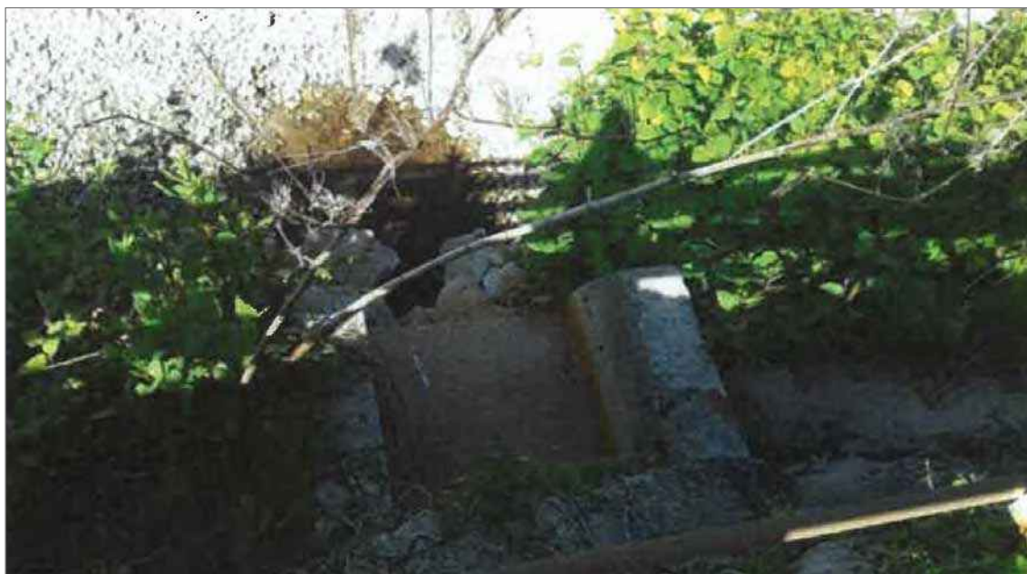
Fotografía 13. Punto de Vertido 2: Detalle de la embocadura de salida de la alcantarilla secundaria. Dicha alcantarilla está constituida por un marco de hormigón de dimensiones aproximadas 0,8 m x 0,8 m.
