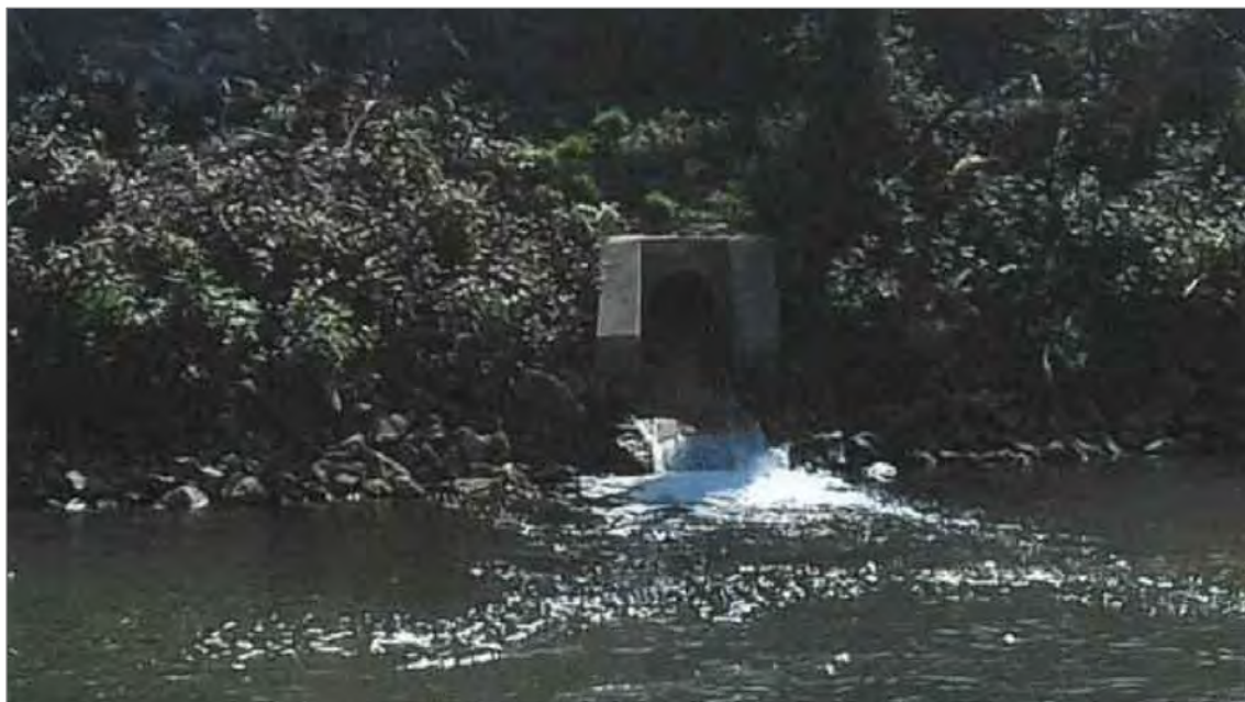
Fotografía 26. Punto de Vertido 3: Salida del agua tratada de la EDARI (vista desde la margen izquierda de la Ría de San Martín de la Arena).
