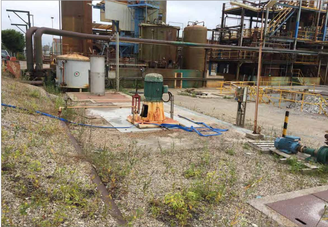
Fotografía 8. Punto de Vertido 2: Foso y bombas de achique para evacuación de caudales a través de la alcantarilla secundaria en situación de grandes avenidas.
