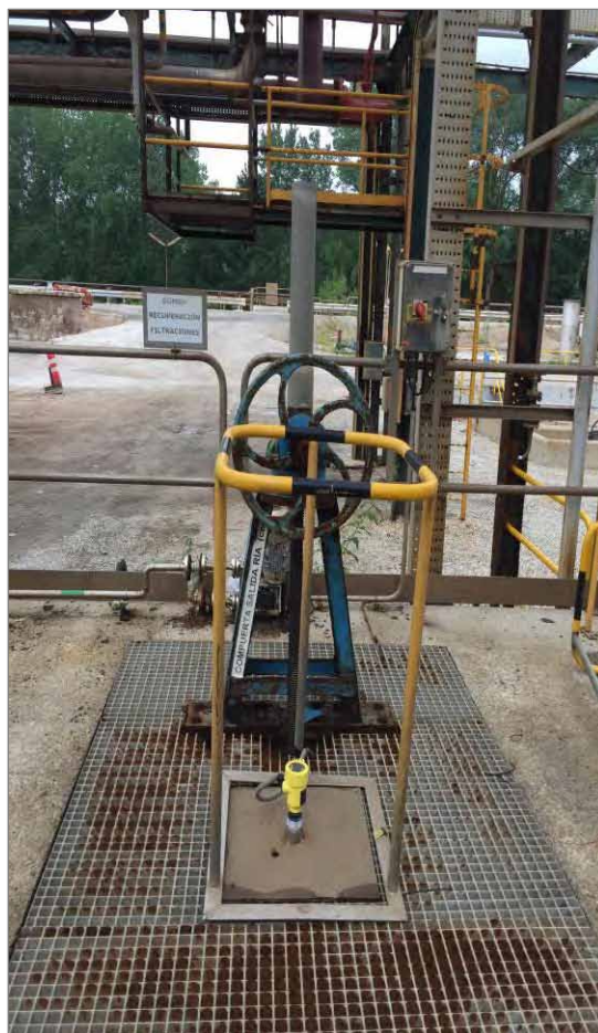
Fotografía 8. Compuerta general de cierre tipo canal (1,5 m x 1,6 m) existente sobre la alcantarilla general en el foso de bombeo a EDARI.
