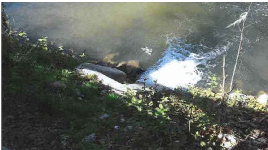
Fotografía 24. Punto de Vertido 3: Vista de la embocadura de salida del agua tratada de la EDARI, desde la parte superior del muro de encauzamiento de la margen derecha de la Ría de San Martín de la Arena.
