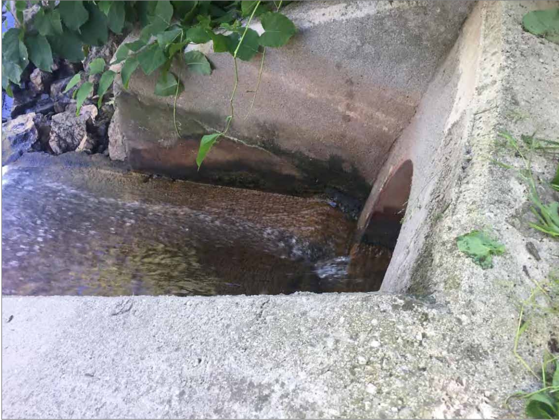
Fotografía 21. Punto de Vertido 3: Salida del tubo de agua tratada de la EDARI (FD DN 800 mm).
