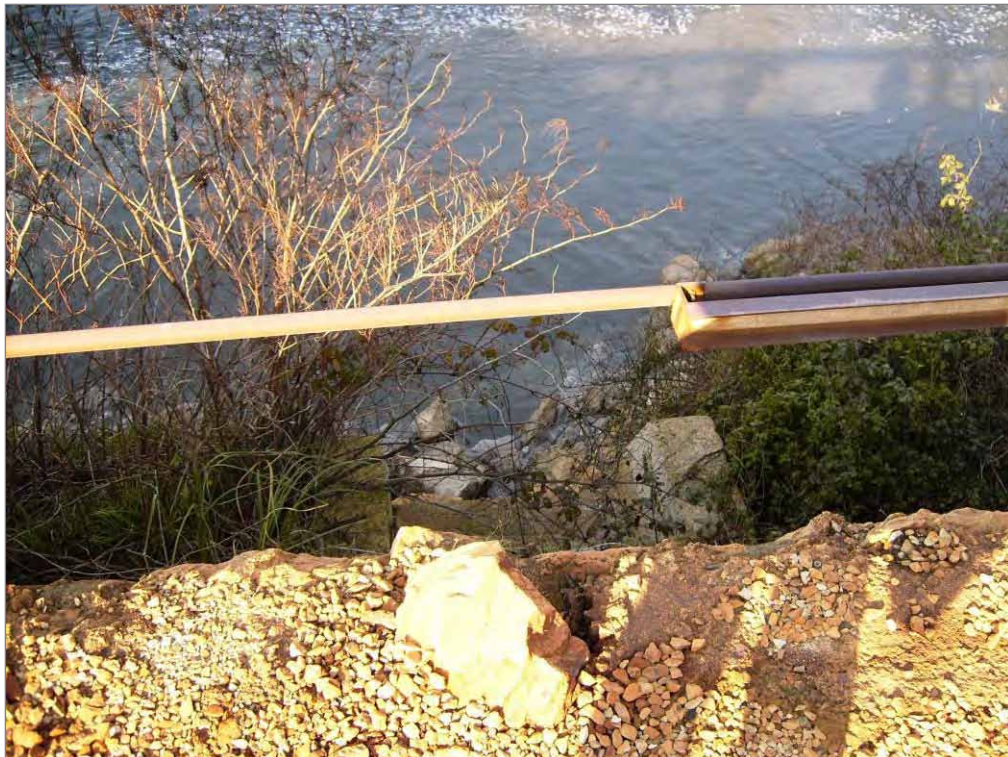
Fotografía 6. Punto de Vertido 2: Salida de la alcantarilla secundaria, a través de la cual se produce el vertido a la ría sólo en situaciones extraordinarias (avenidas, marea alta) en las que se requiere efectuar un alivio de carácter excepcional.
