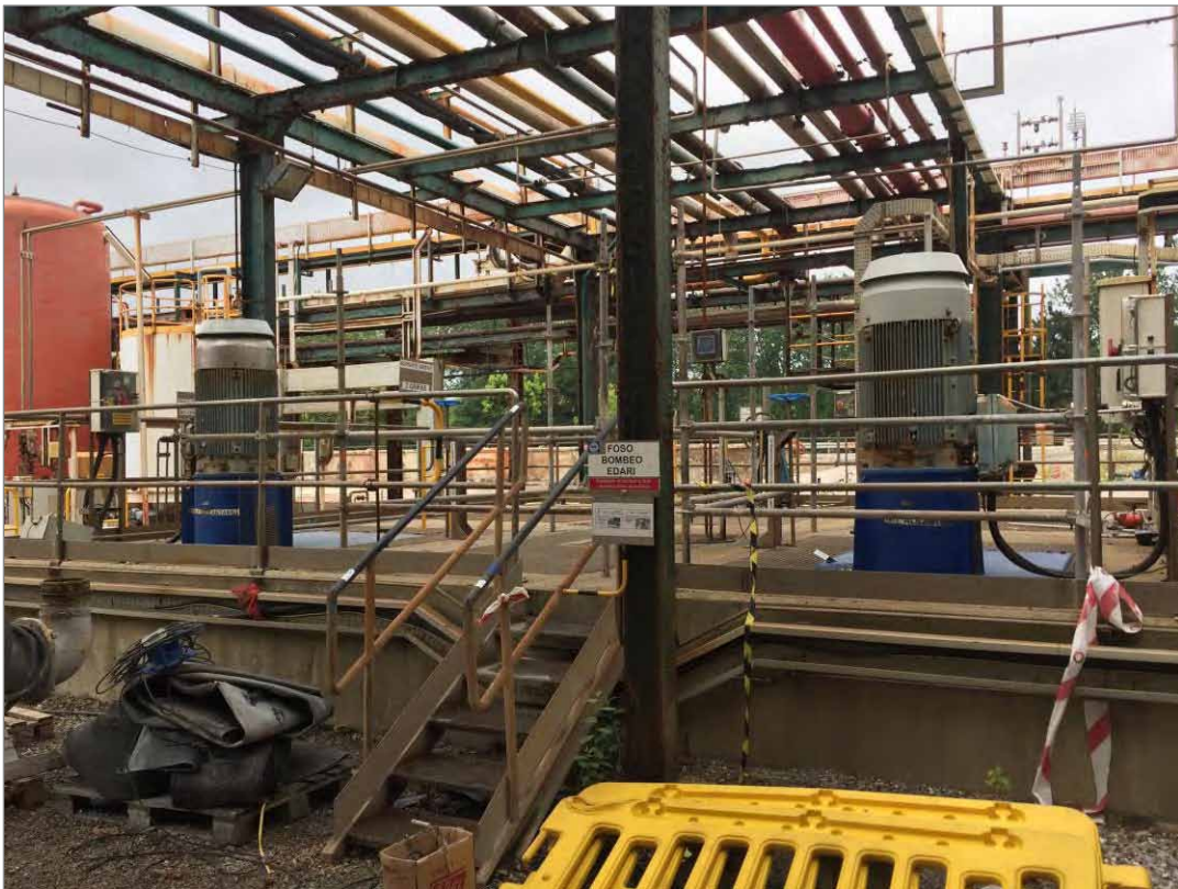
Fotografía 15. Foso de bombeo a EDARI.
