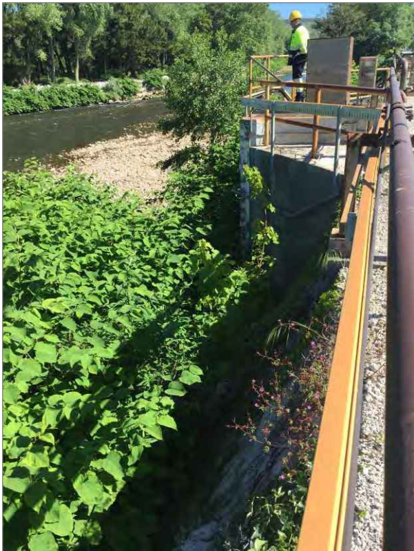
Fotografía 13. Punto de Vertido 1: Antigua alcantarilla general.
