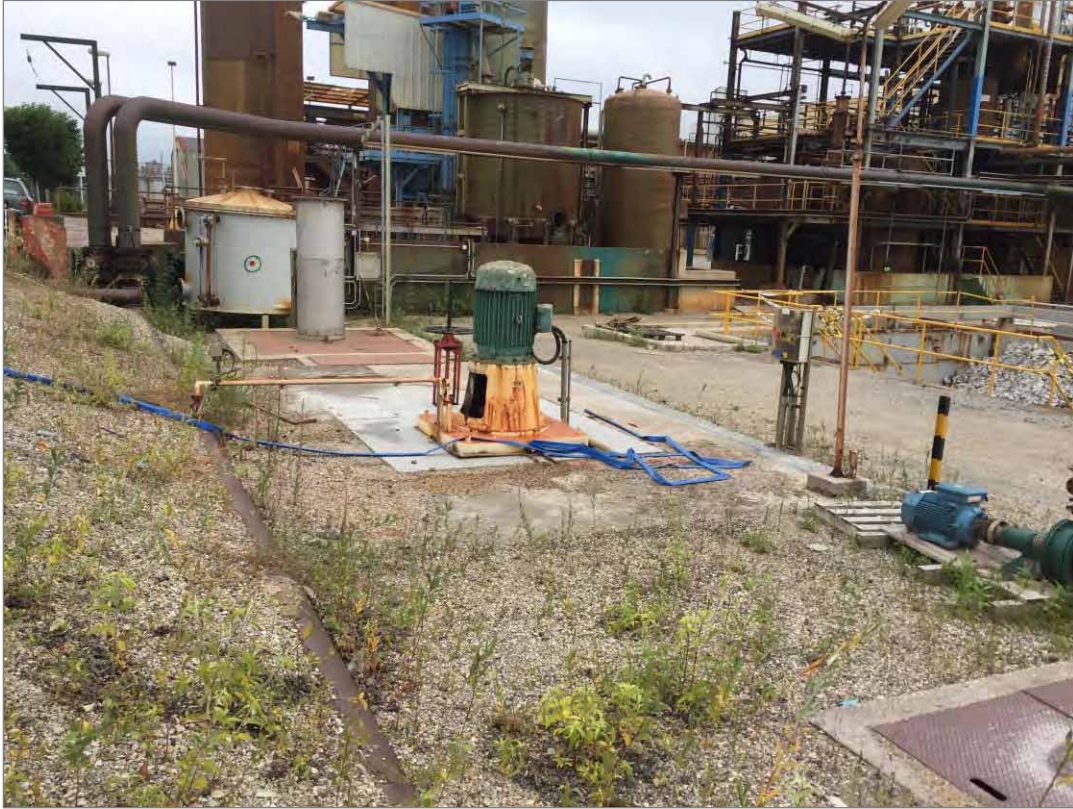
Fotografía 14. Punto de Vertido 2: Foso y bombas de achique para evacuación de caudales a través de la alcantarilla secundaria en situación de grandes avenidas.
