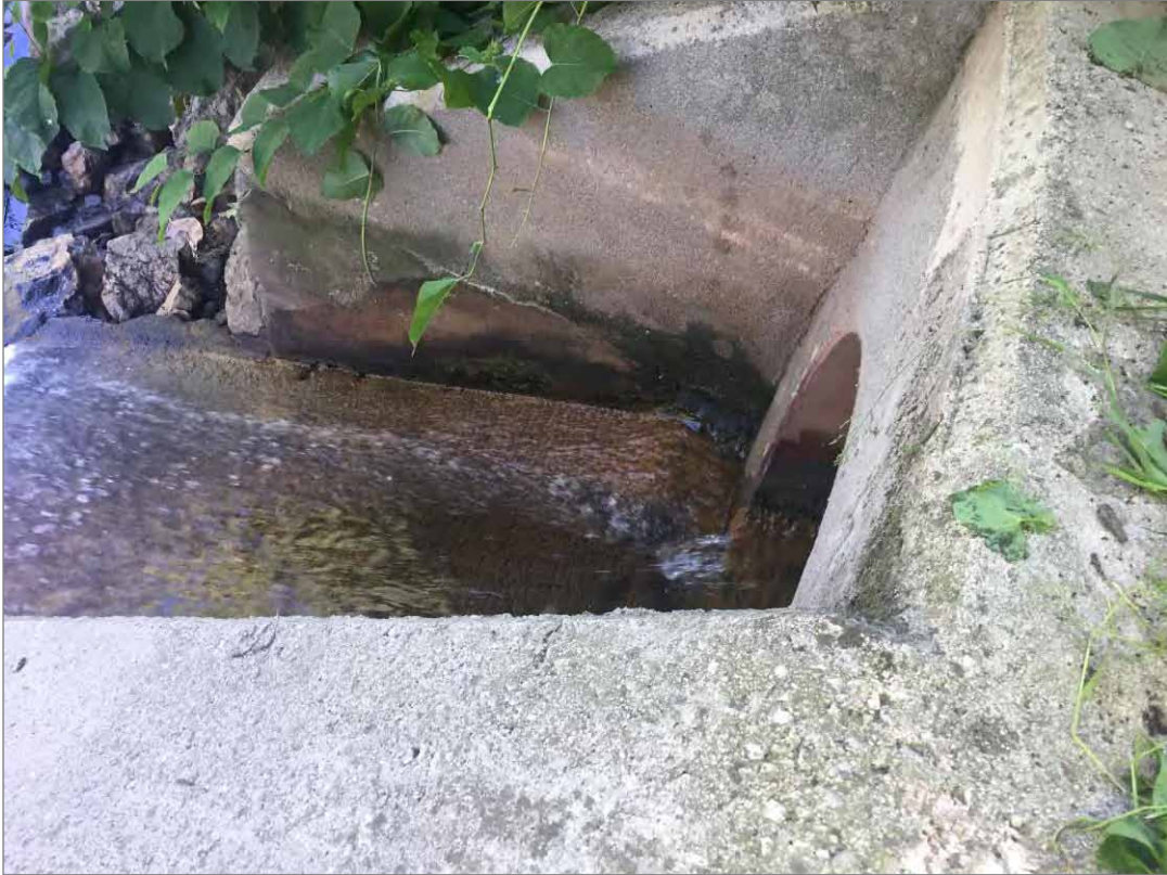
Fotografía 10. Punto de Vertido 3: Salida del tubo de agua tratada de la EDARI (FD DN 800 mm).
