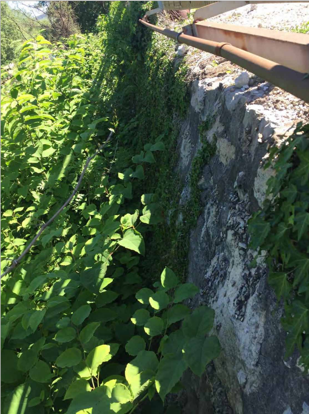
Fotografía 17. Punto de Vertido 2: Vista hacia aguas abajo del muro de encauzamiento de la ría, cubierto por vegetación, en zona de salida de la alcantarilla de achique en grandes avenidas.
