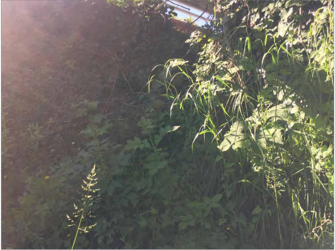
Fotografía 30. Punto de Vertido 3: Vista hacia aguas arriba del muro de encauzamiento de la ría, cubierto por vegetación, en zona de salida del tubo de agua tratada de la EDARI.
