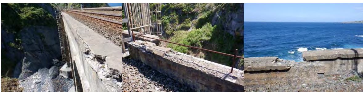
Figura 69. Rotura muretes guardabalastos
