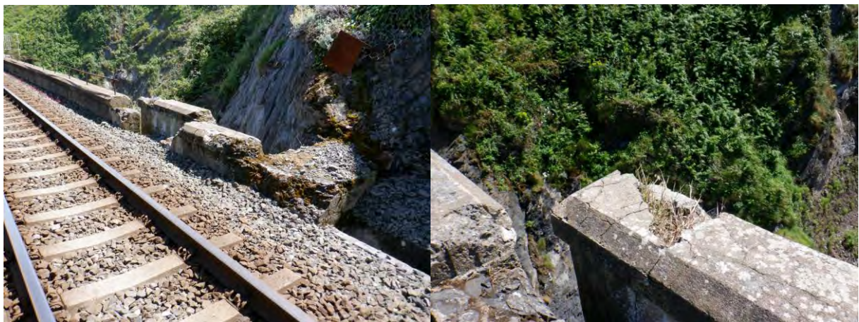
Figura 56. Muro guardabalasto desprendido
