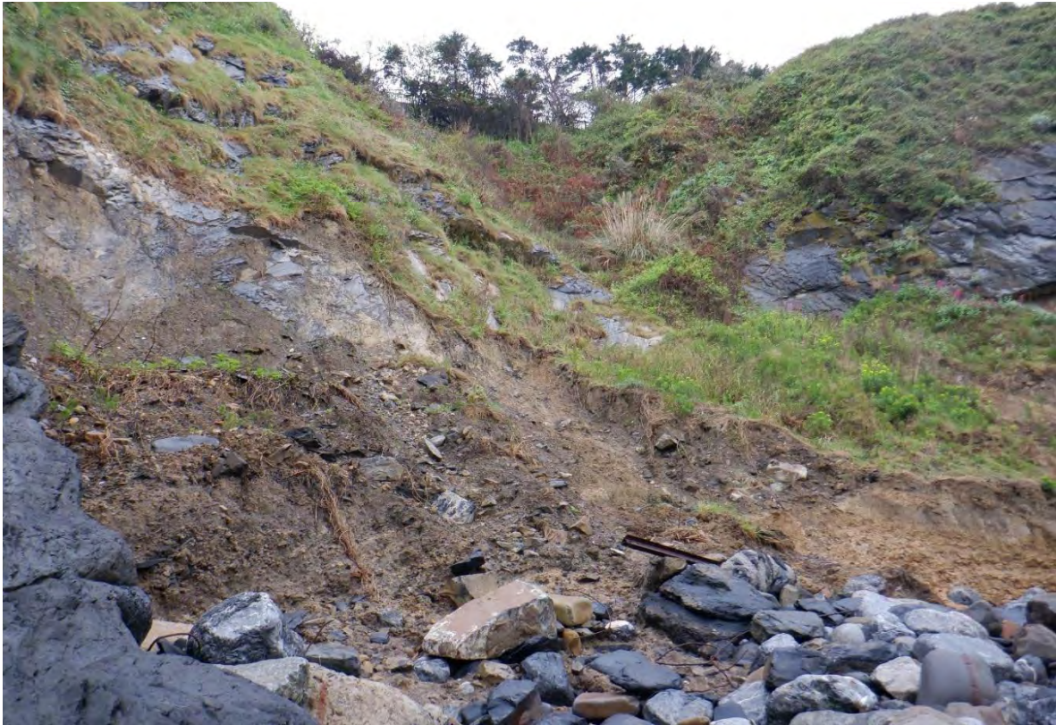
Figura 104. Erosiones localizadas en el pie de la ladera.
