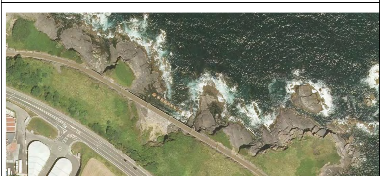
2016. Bloques de protección anclados al sustrato rocoso, pero con signos evidentes de deterioro. Se observa menor vegetación en la parte inferior de la ladera posiblemente causada por la incidencia de los temporales del año 2014.
