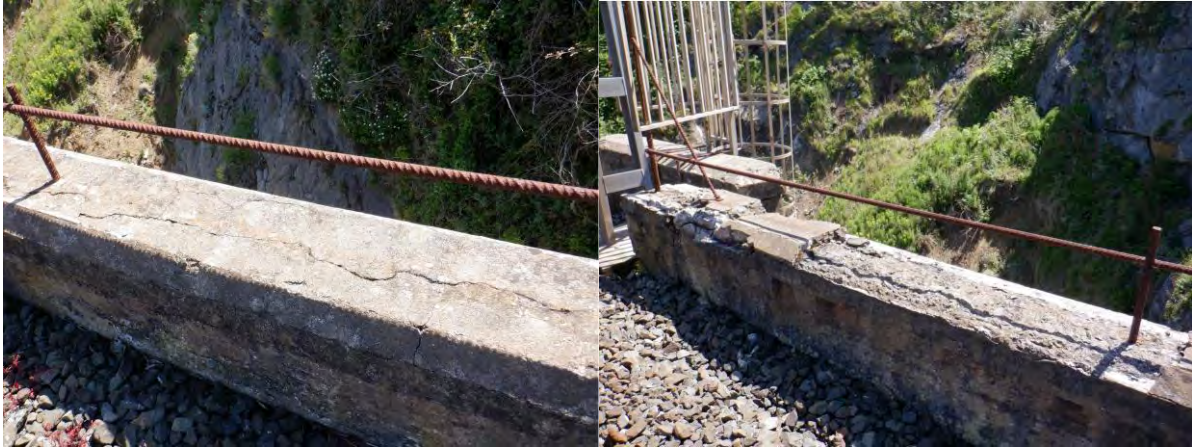
Figura 57. Fisuras y desprendimientos en muro guardabalasto
