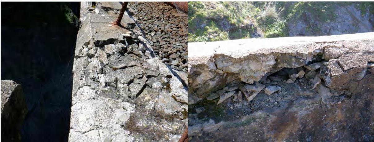
Figura 58. Coqueras y desprendimientos muro guardabalasto
