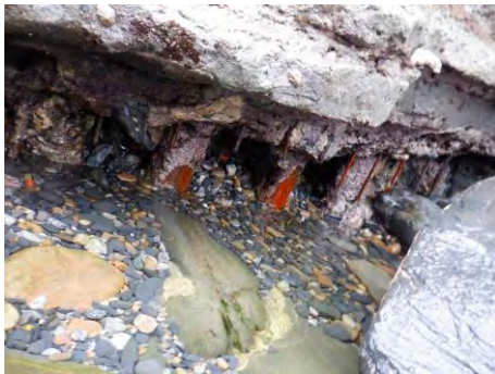
Figura 67. Descalce zona micros pila 7
