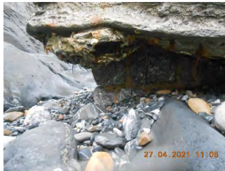
Figura 68. Descalce cimentación pila 7
