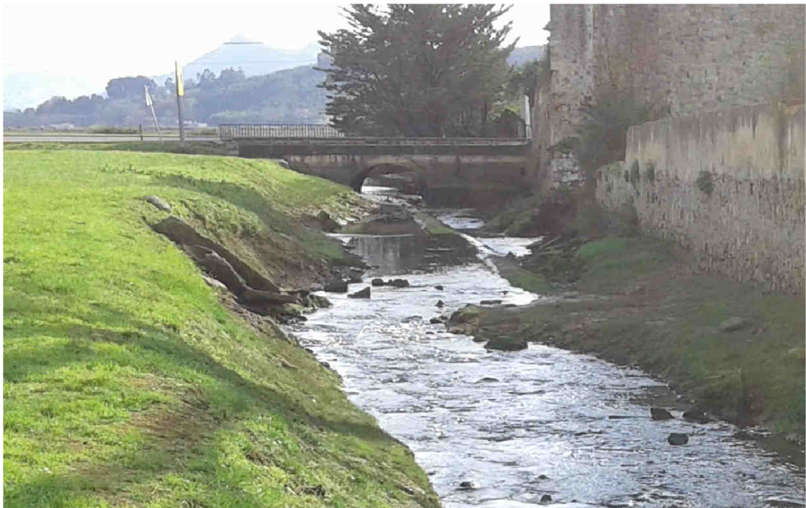
Figura 2. Tubería en el cauce que emerge en el tramo aguas arriba de la carretera CA-148.
