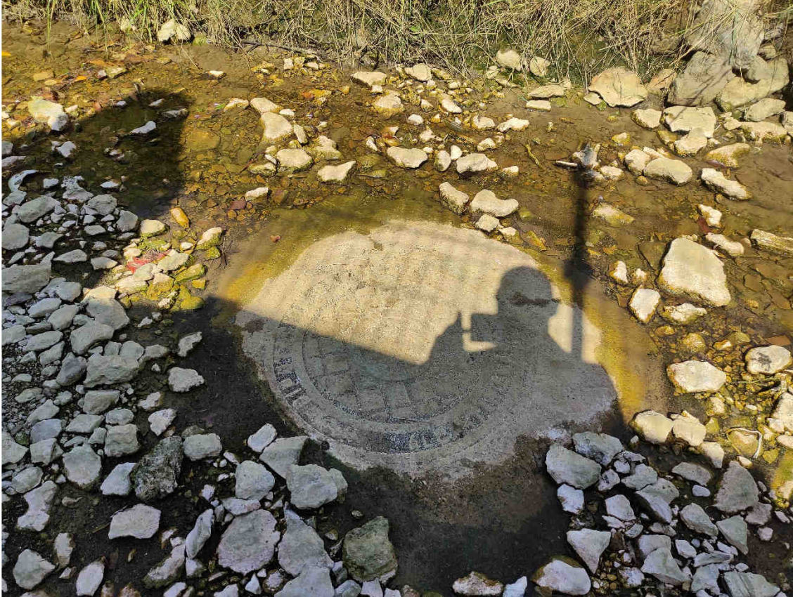
Figura 3. Aspecto de una de las tapas de los pozos existentes en el cauce. La foto se corresponde con una inspección en periodo estival.
